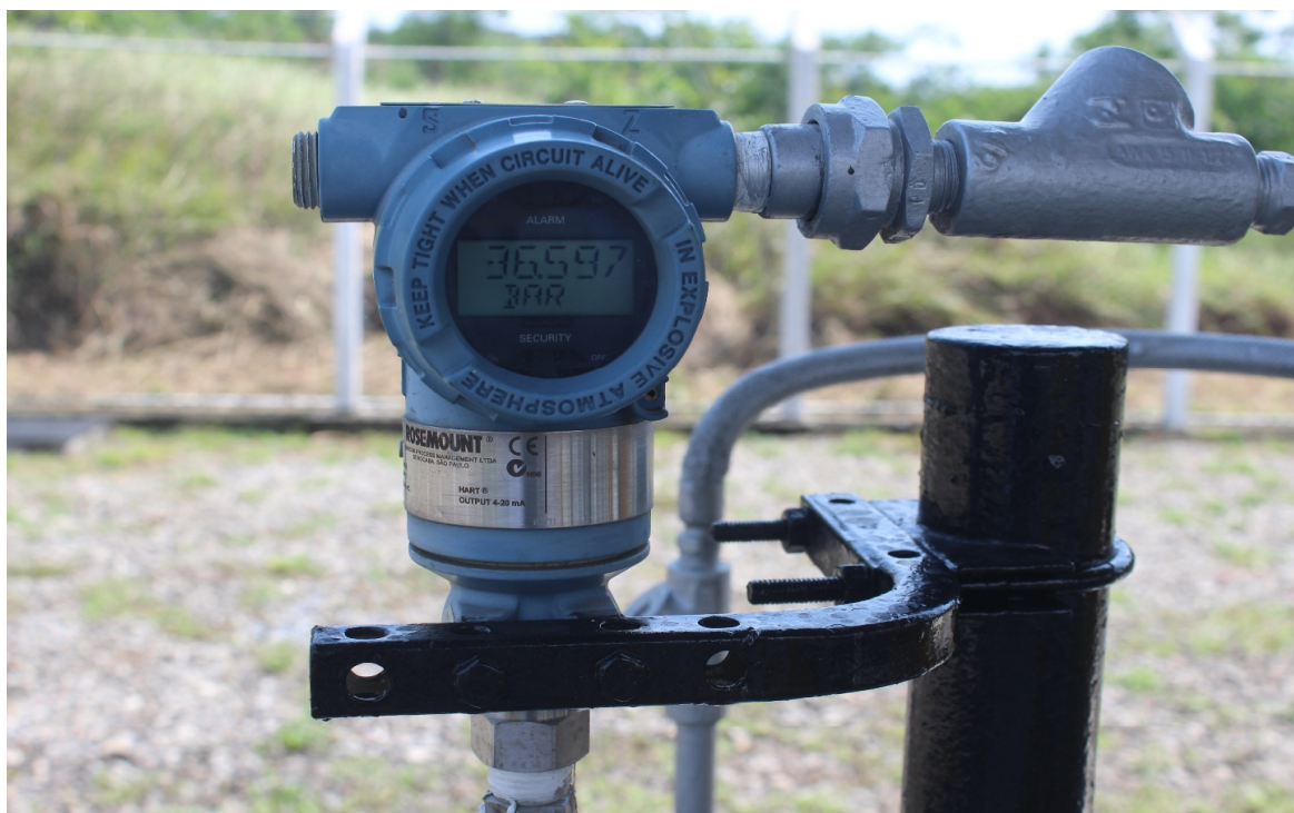
Foto 5: Indicação da pressão de entrada
