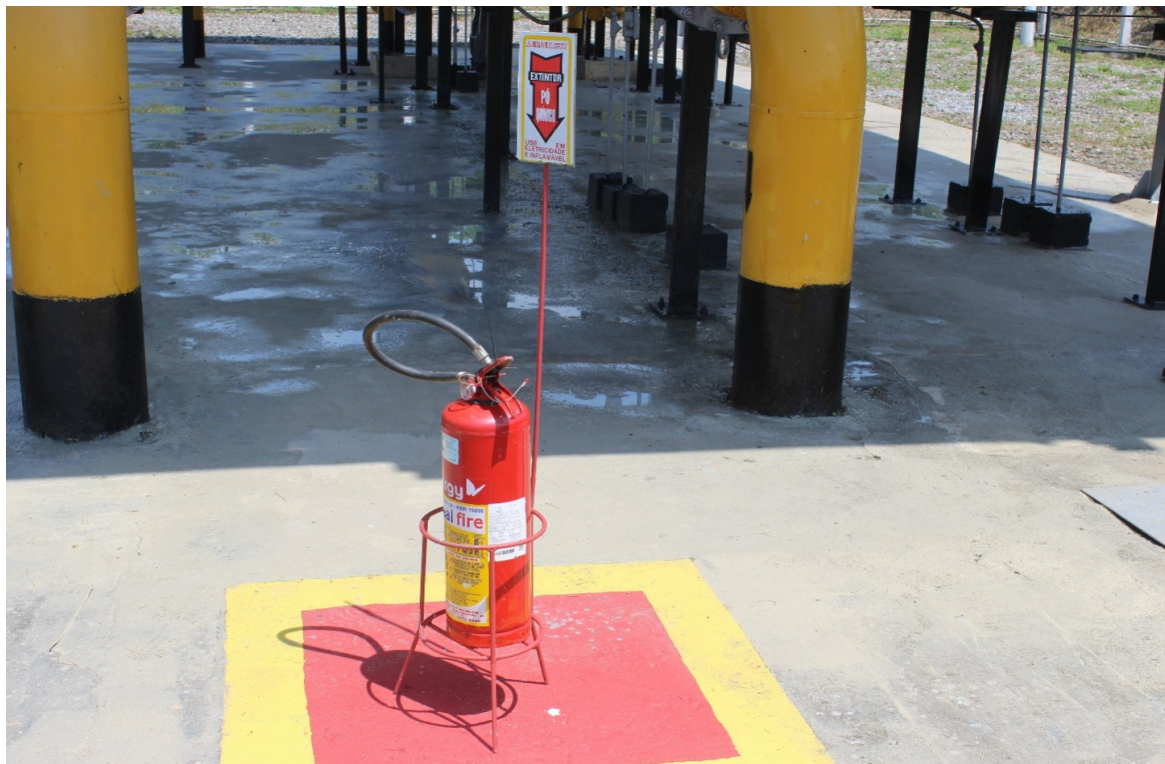
Foto 18: Extintor de PQS
