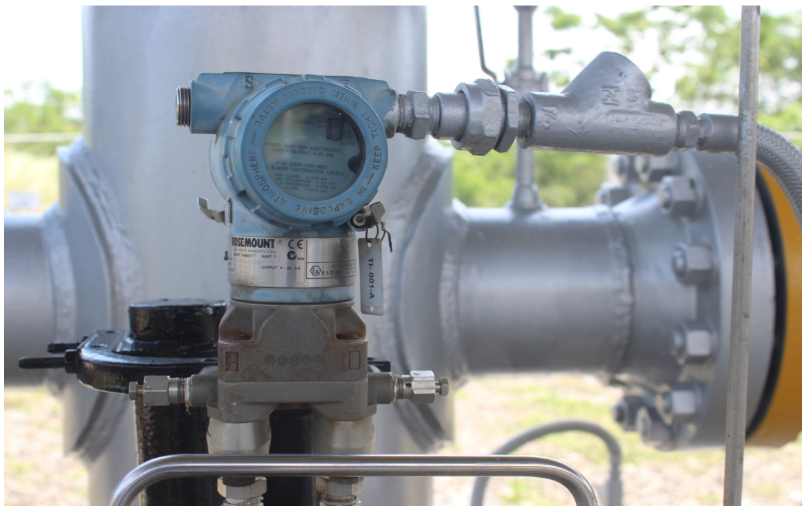
Foto 11: Manômetro diferencial de pressão inoperante
