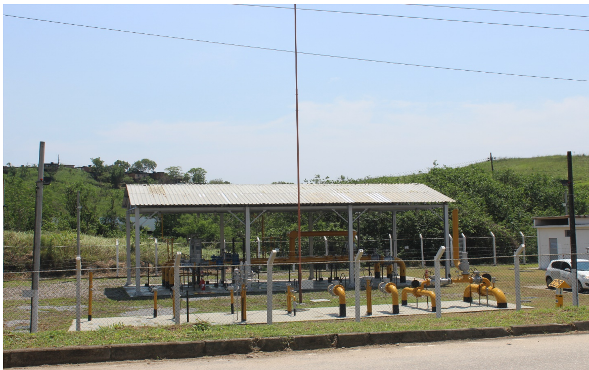
Foto 3: Visão geral da estação
