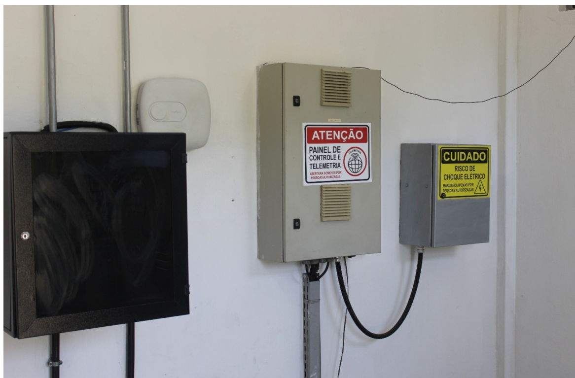
Foto 16: Sala de controle
