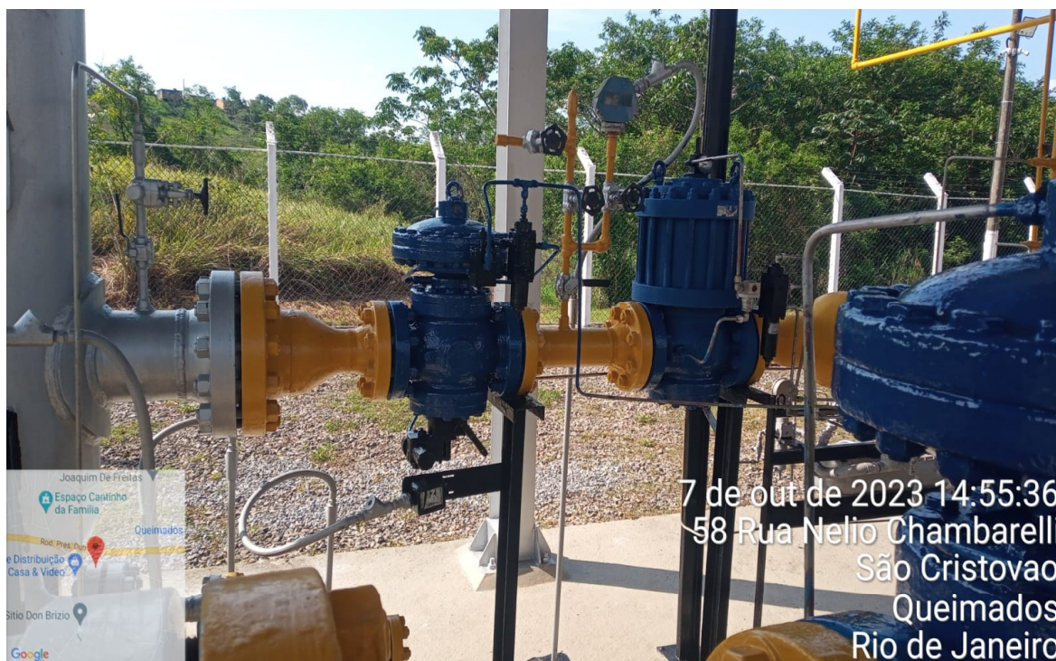
Foto 13: Reguladores que passaram por processo de limpeza
