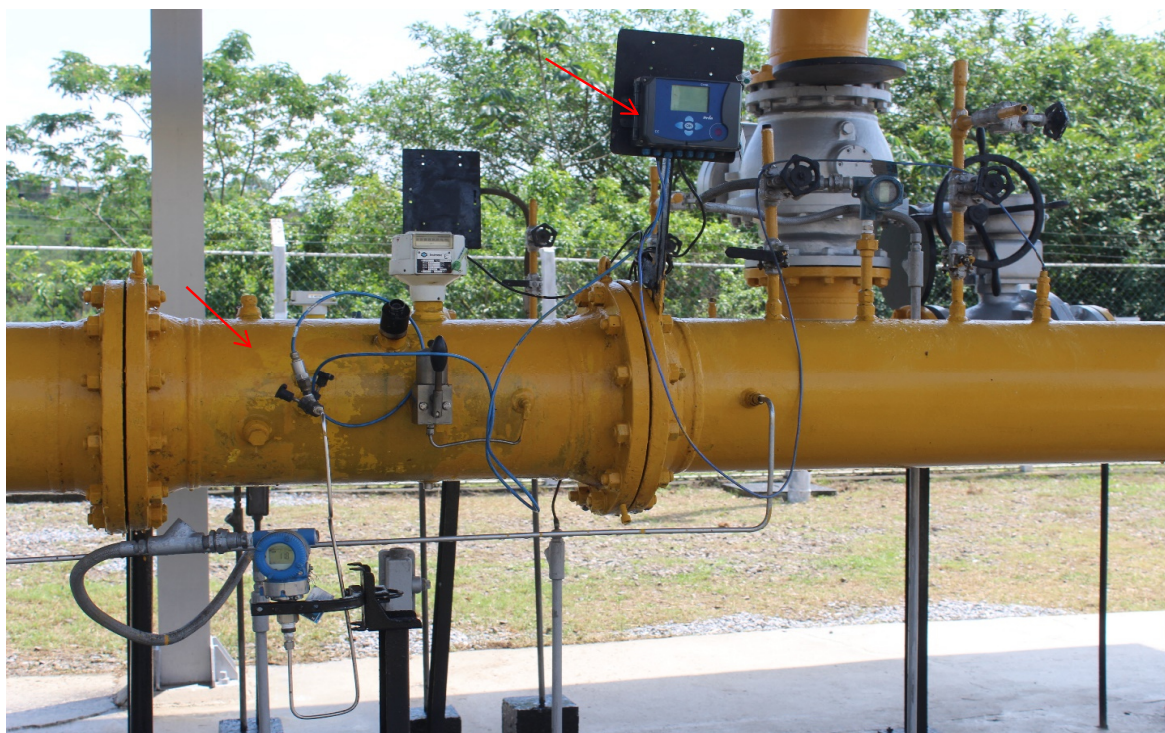
Foto 8: Medidor de vazão (Turbina) e conversor de volume
