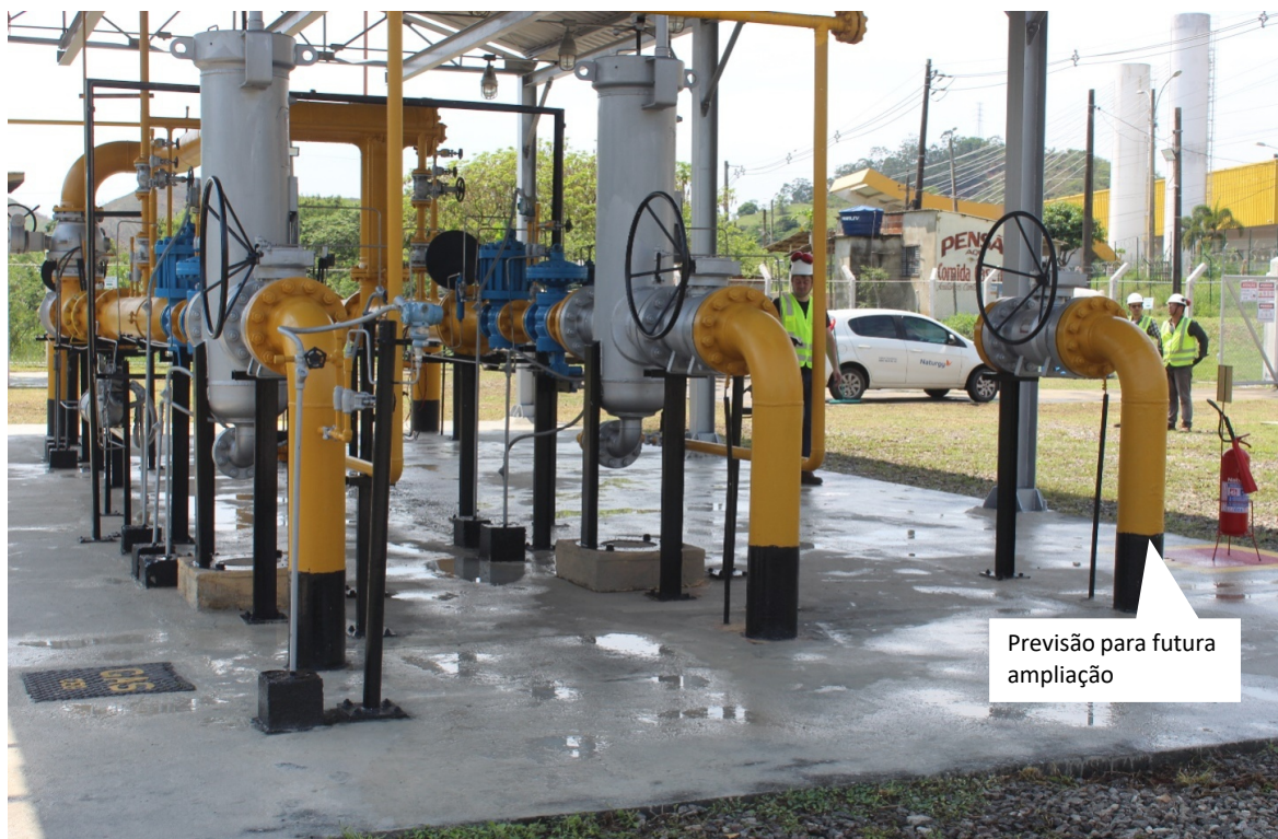
Foto 4: Tubulação de entrada - 36 bar
