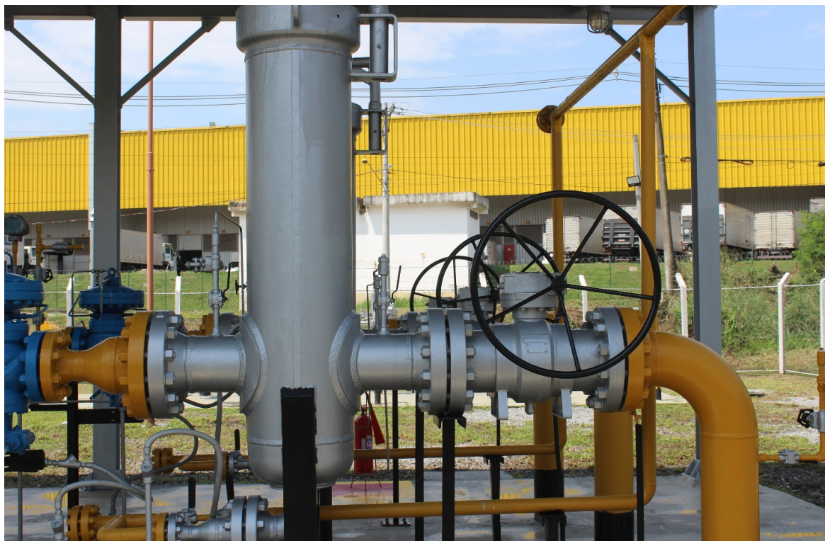
Foto 7: Filtro e válvula (entrada do gás)
