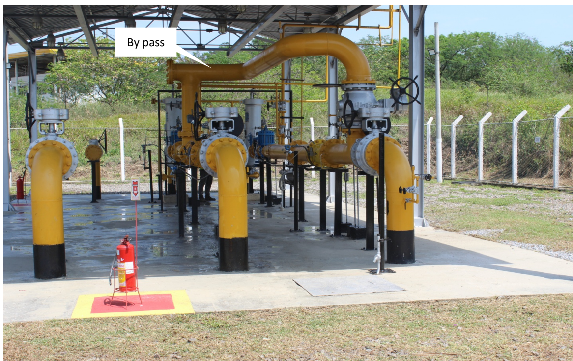
Foto 15: Tubulação de saída - 12 bar
