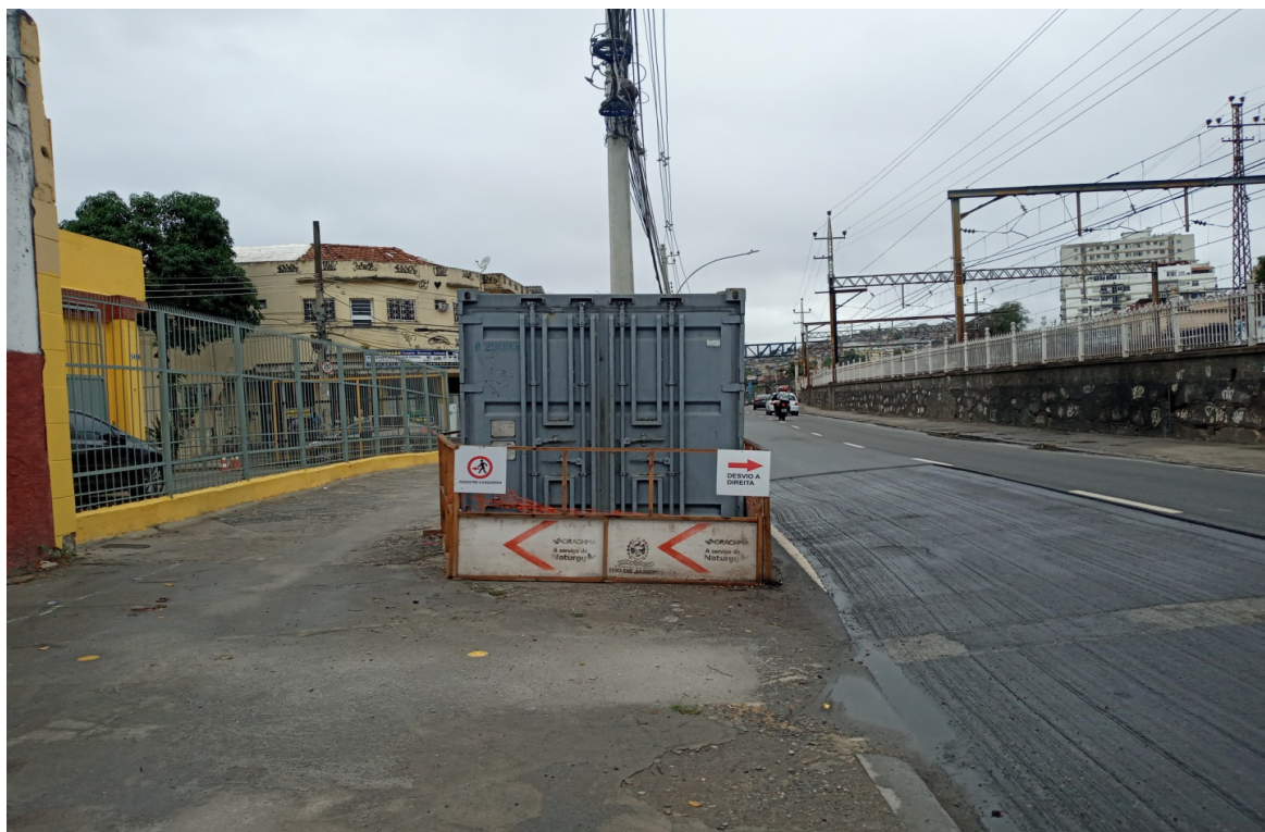
Foto 7: Isolamento sem sinalização noturna
