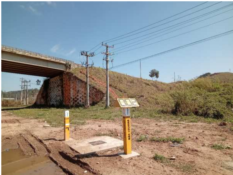
Foto 10: Ponto de interligação entre as redes da fase 1 e fase 2.
