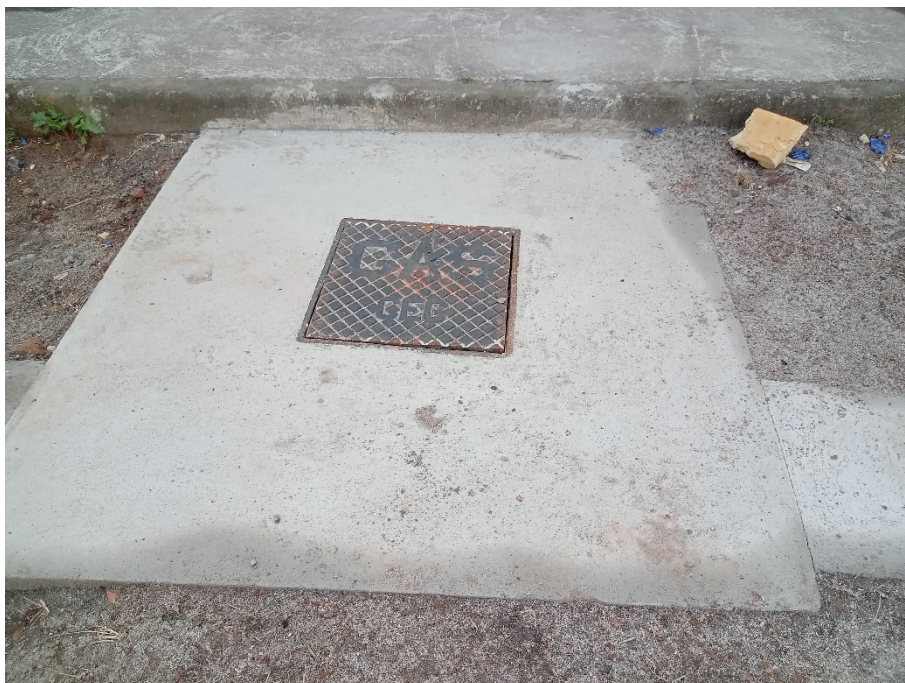
Foto 8: Caixa de válvula de bloqueio da rede de gás instalada no final do trecho da fase 1.
