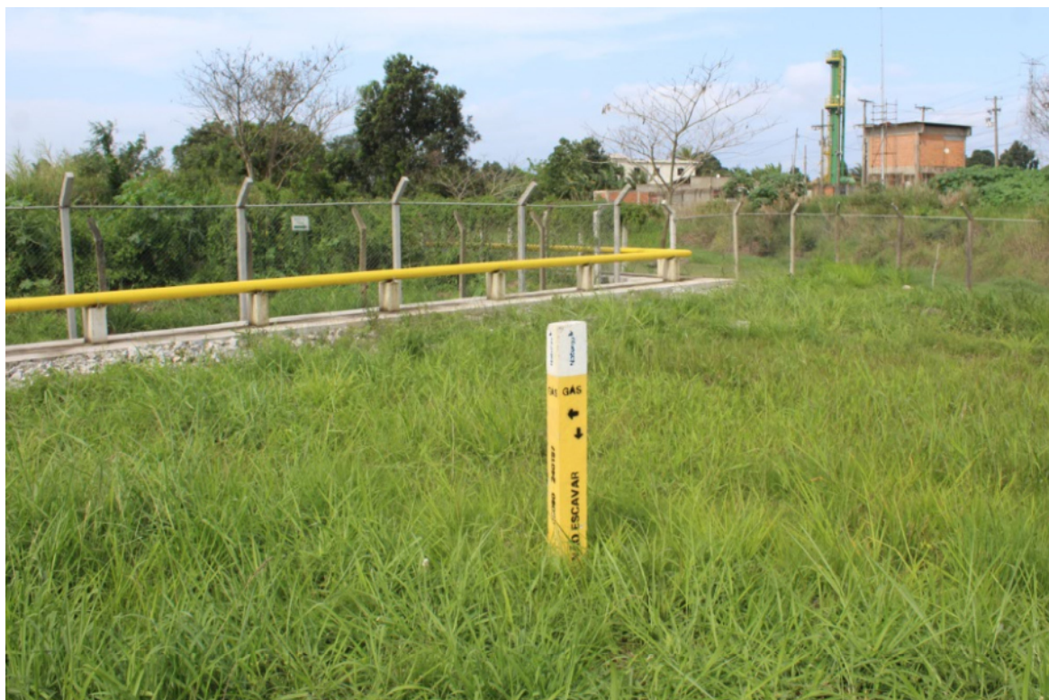
Foto 16: Placas de rota de fuga (antes)
