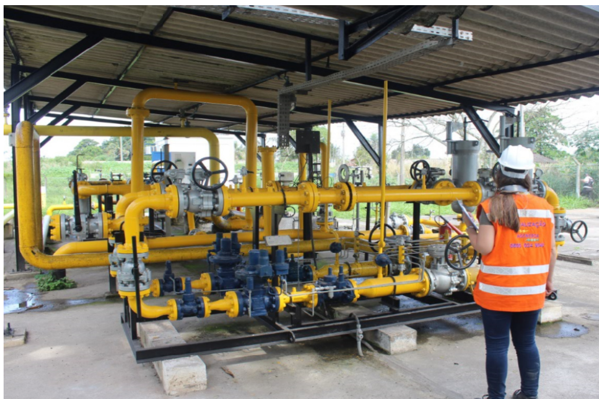
Foto 4: Tubulação sem sentido do fluxo de gás (antes)
