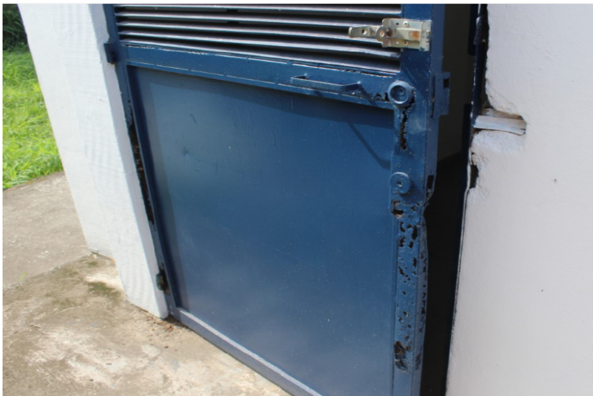
Foto 6: Porta deteriorada (antes)
