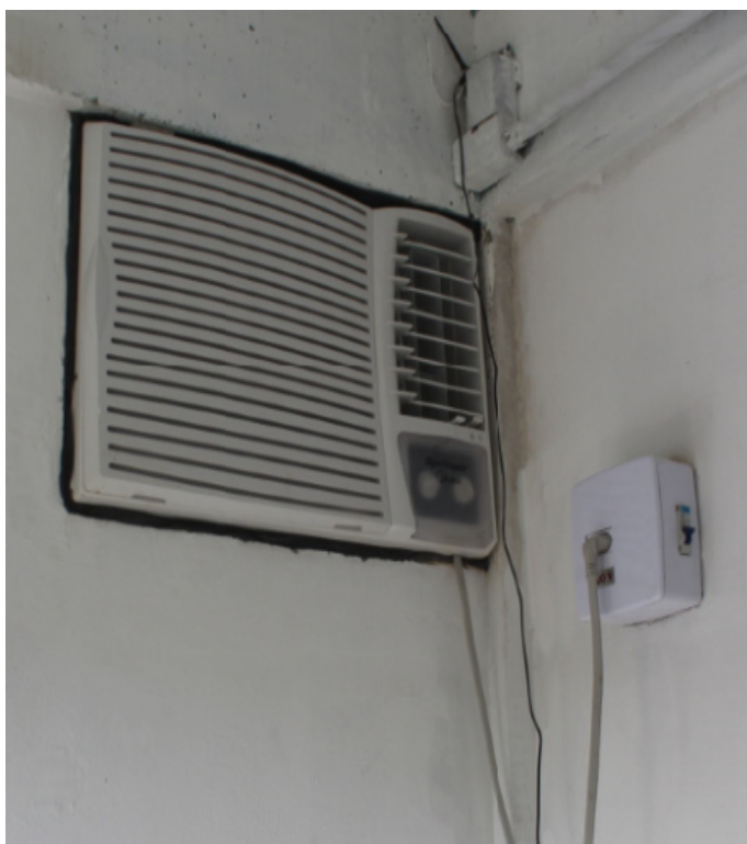
Foto 12: Ar condicionado sem manutenção (antes)
