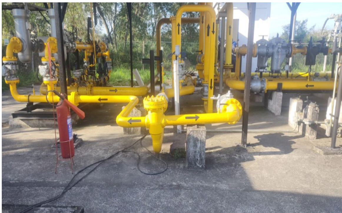
Foto 5: Tubulação sem sentido do fluxo de gás (depois)
