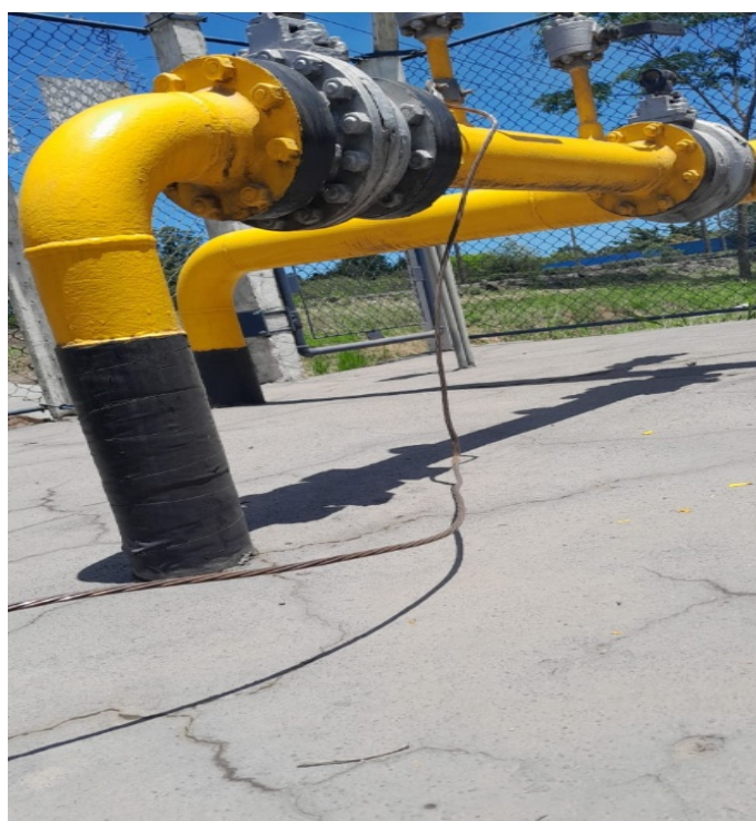
Foto 8: Cabo de aterramento danificado (depois)
