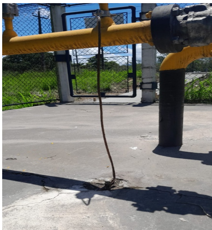
Foto 4: Cabo de aterramento (depois)
