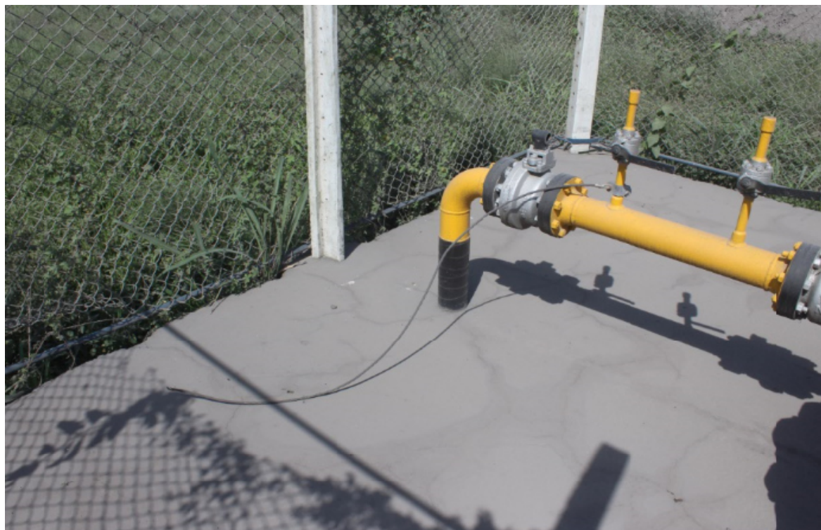
Foto 7: Cabo de aterramento danificado (antes)
