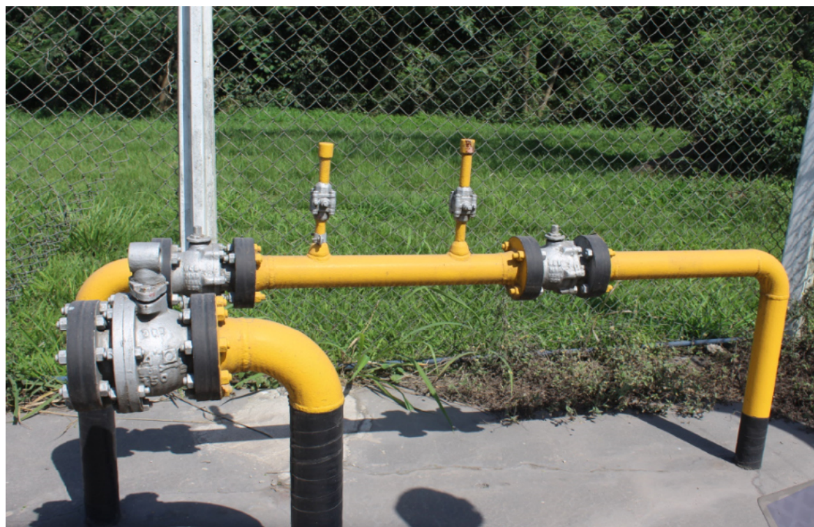
Foto 2: Sistema de bypass
