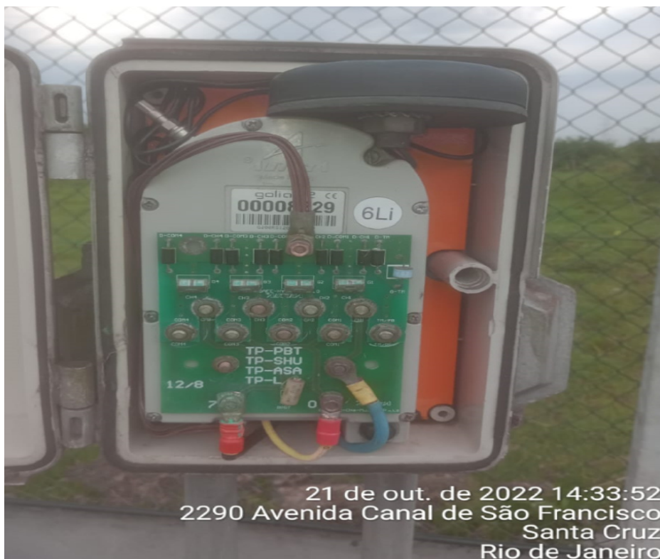
Foto 6: Quadro da proteção catódica necessitando de reparo (depois)
