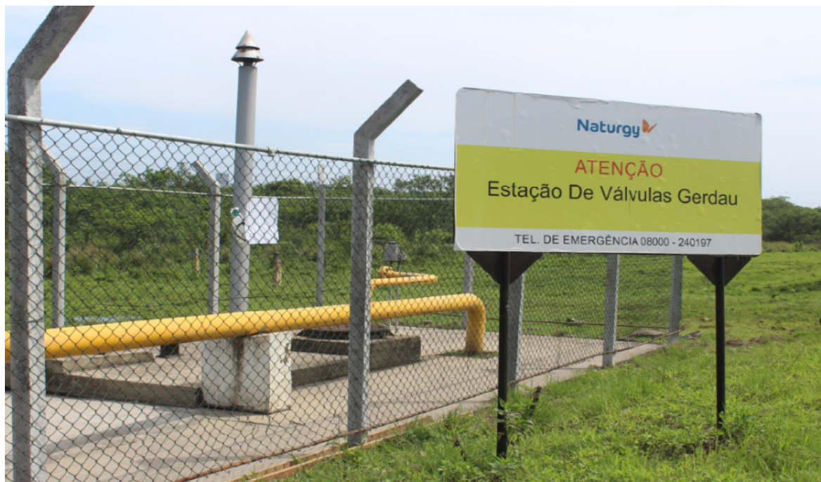
Foto 1: Placa de identificação da Estação
