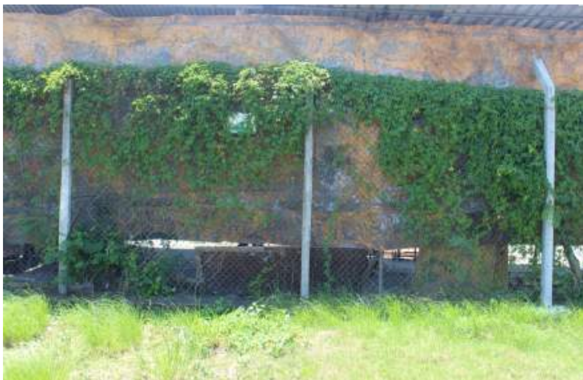
Foto 23: Capina alta, planta cobrindo cerca e placa de rota de fuga (antes).
