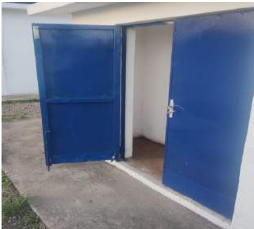
Foto 19: Portas deterioradas e sem maçaneta (depois).
