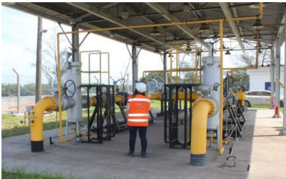
Foto 7: Estação de regulação e medição.
