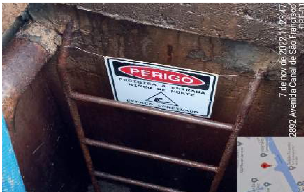
Foto 30: Placa de espaço confinado (depois).
