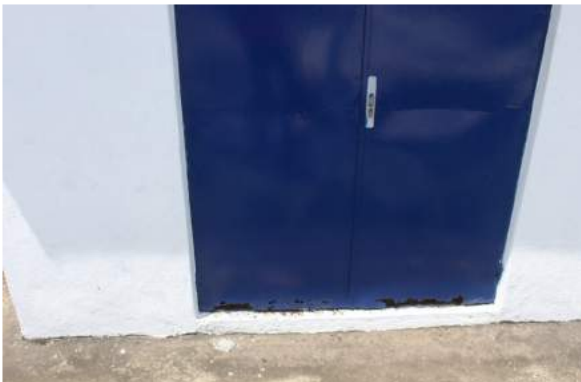
Foto 18: Portas deterioradas e sem maçaneta (antes).
