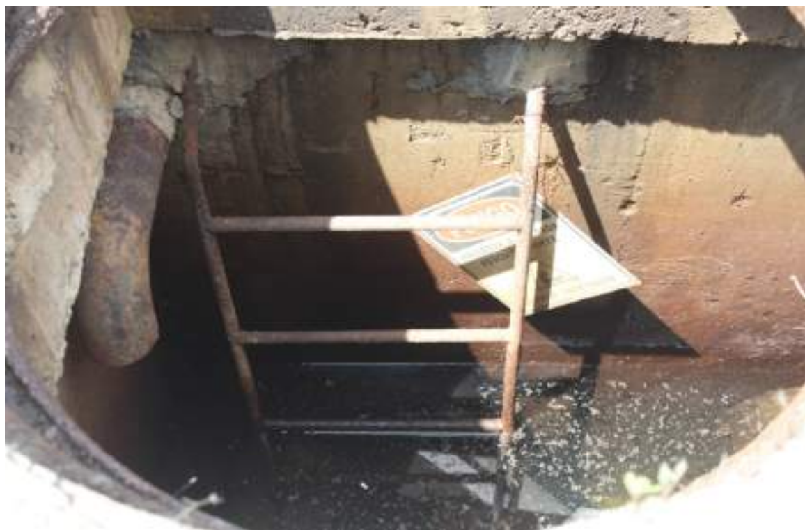
Foto 29: Placa de espaço confinado (antes).
