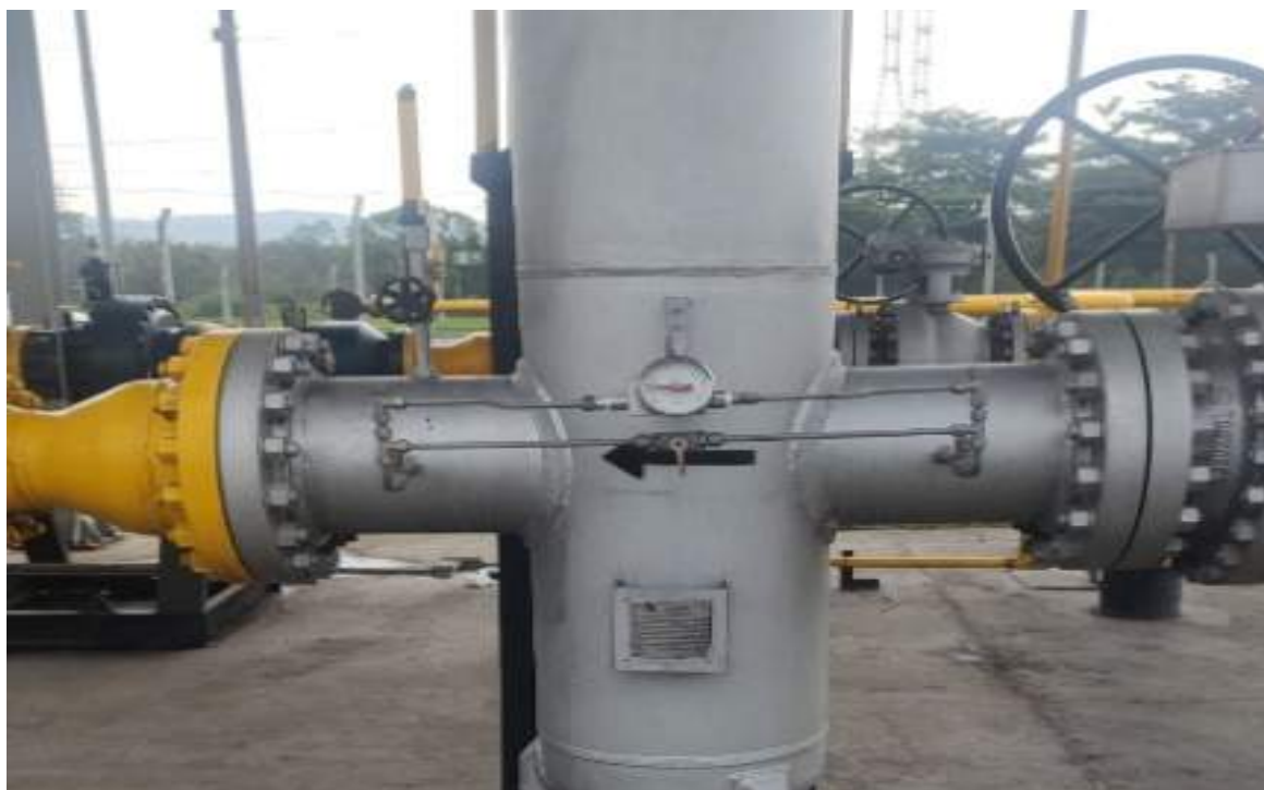
Foto 9: Medidor de pressão (depois).
