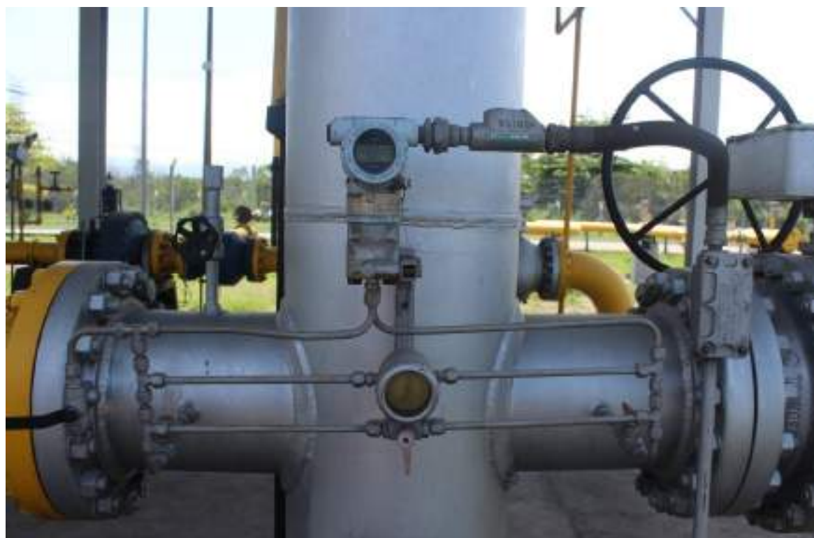
Foto 8: Medidores de pressão inoperantes (antes).
