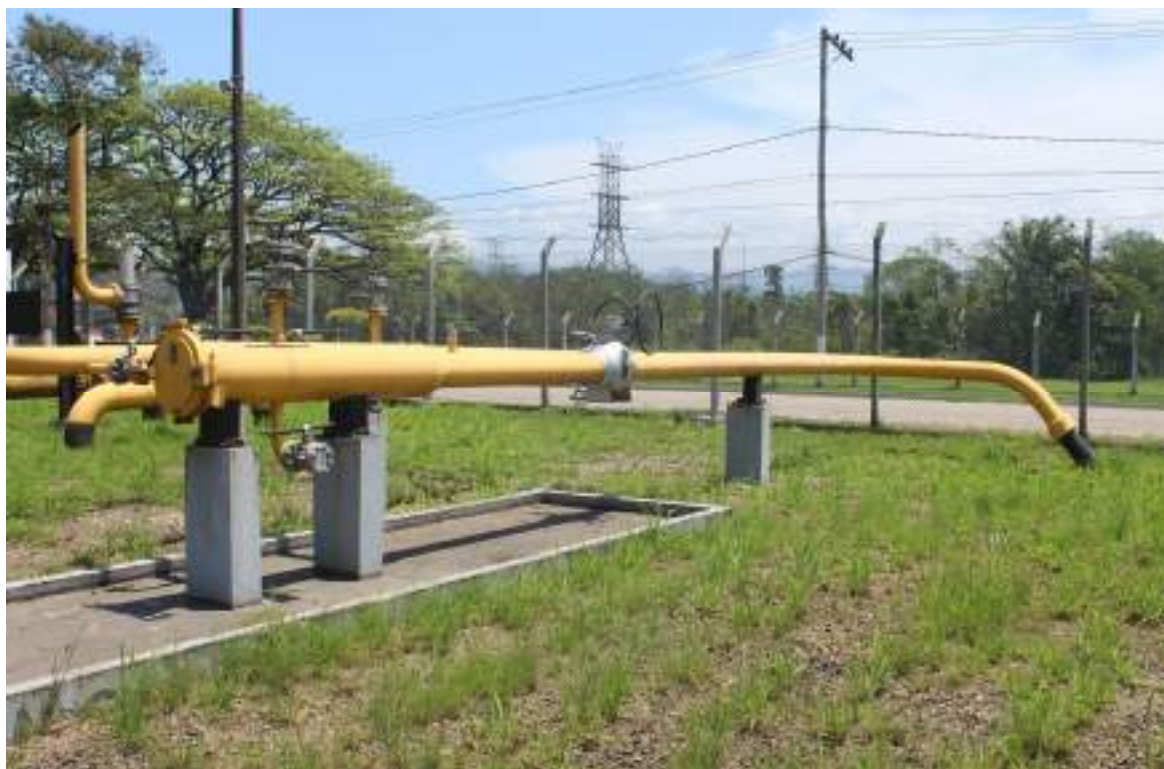
Foto 4: Tubulação de 8" que recebe gás de Fazendinha.
