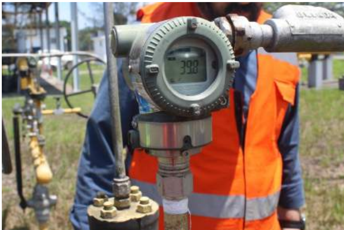
Foto 6: Medidor de pressão.
