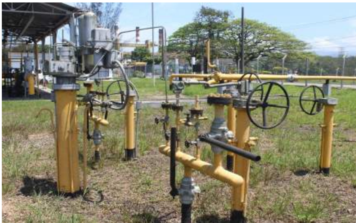
Foto 5: Sistema de válvula telecomandada para manobra de linha.
