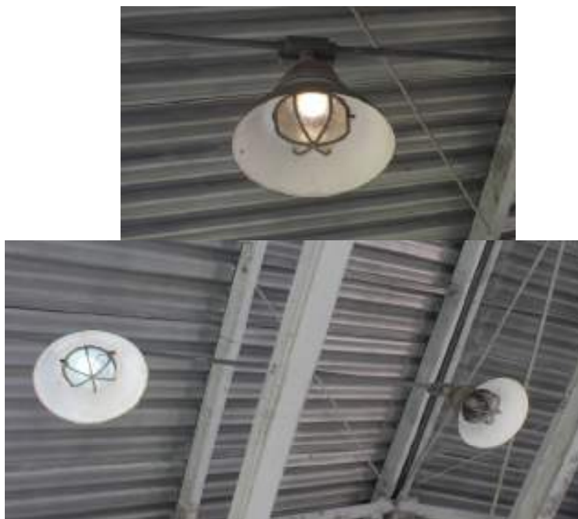
Foto 21: Lâmpadas quebradas, queimadas e amareladas (antes).
