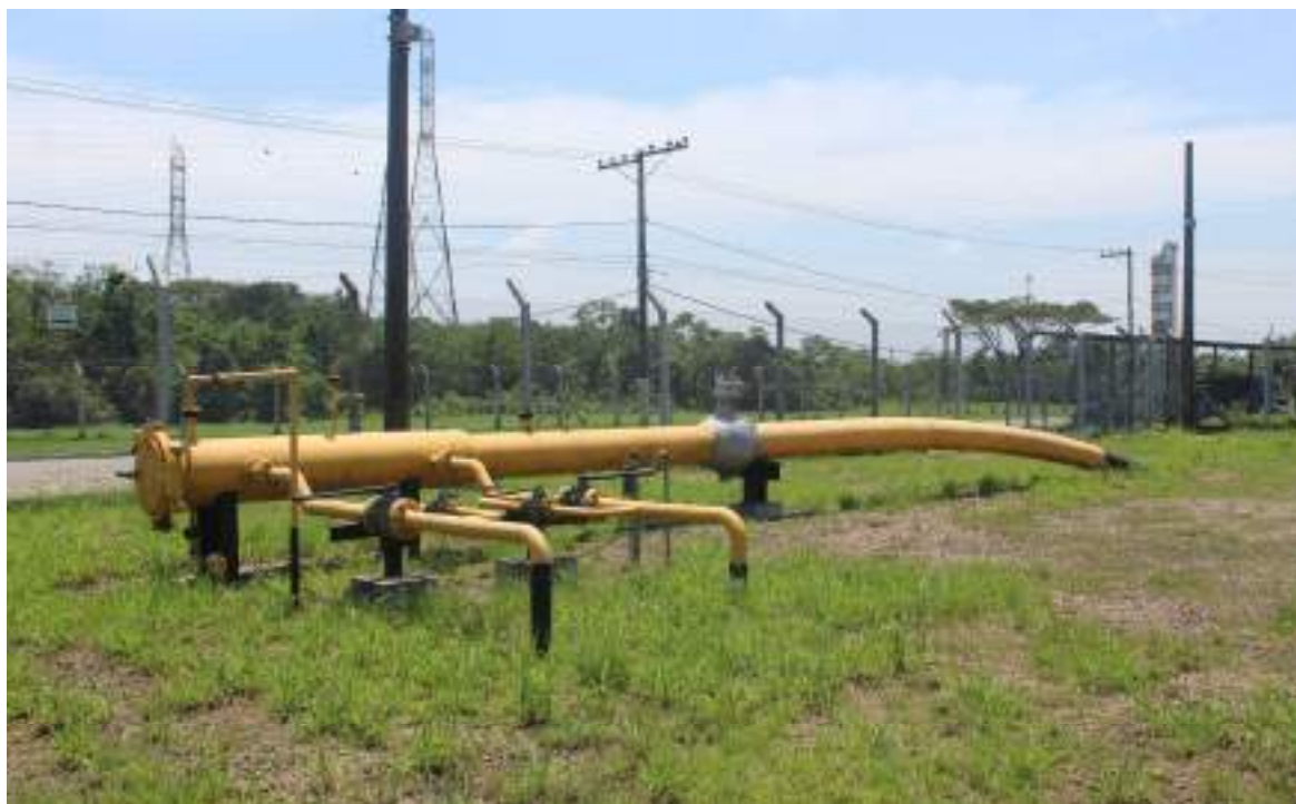
Foto 3: Tubulação de 14" que recebe gás de Japeri.
