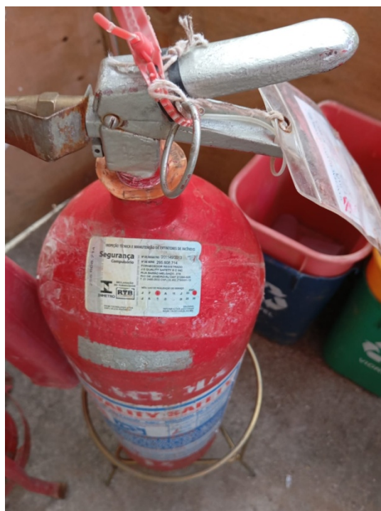
Foto 10: Adequação do extintor de incêndio de CO2.
