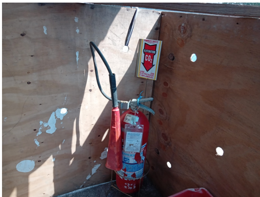
Foto 9: Extintor de incêndio de CO2 com etiquetas danificadas, ilegíveis.
