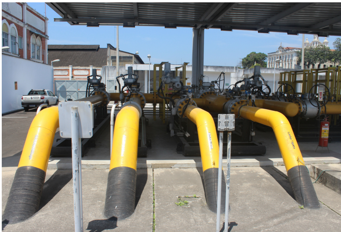
Foto 10: Linhas de abastecimento de gás para as áreas Tijuca, Zona Norte, Botafogo e Leblon.
