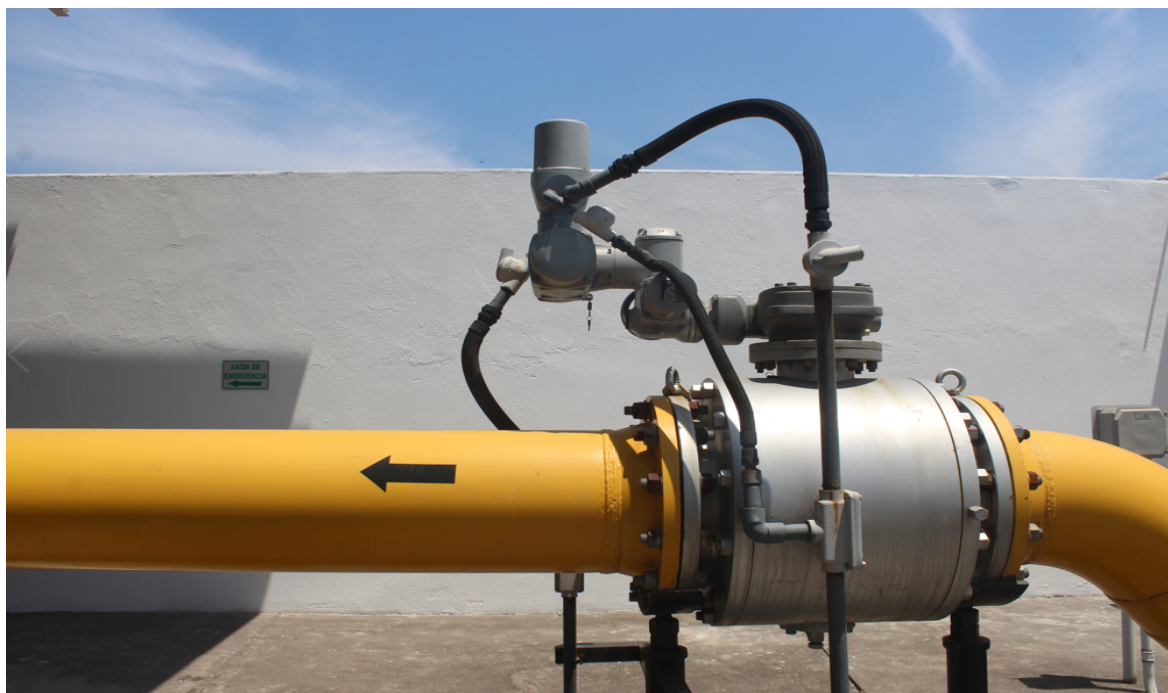
Foto 7: Válvula de segurança no ponto de entrega da UPGN da Petrobras para a CEG.
