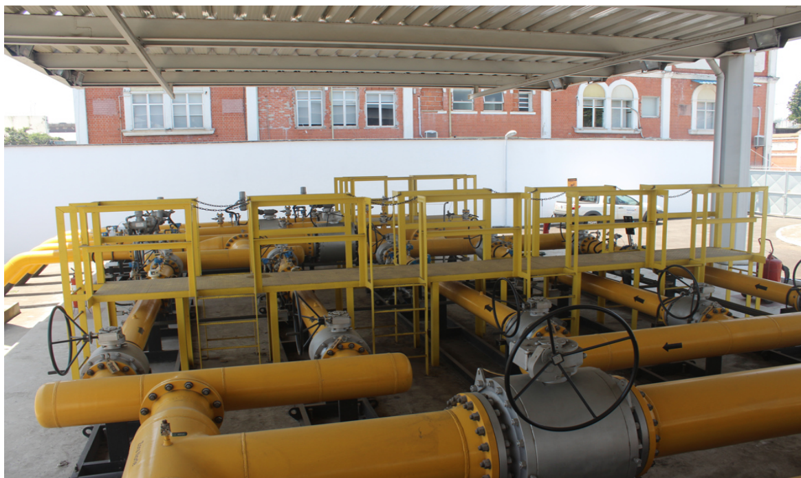
Foto 9: Linhas e válvulas de distribuição de gás.
