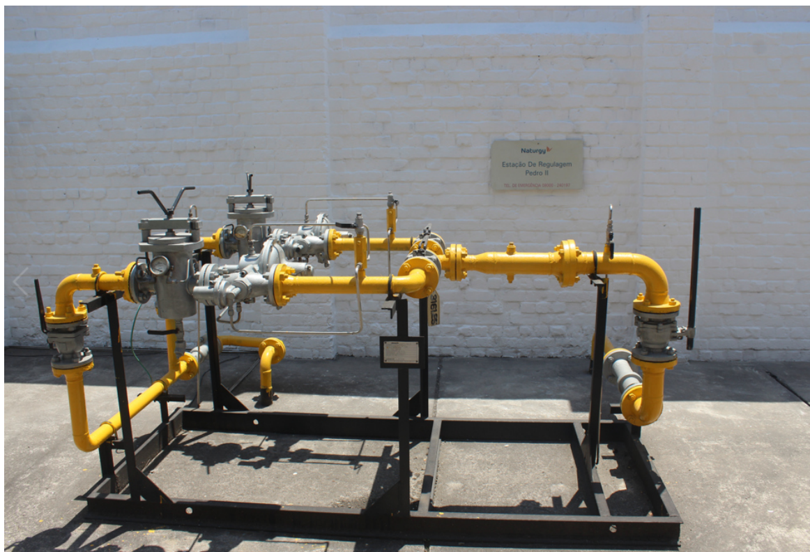
Foto 12: Estação de Regulagem.
