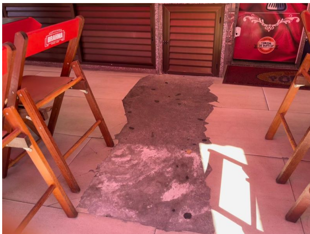
Foto 10: Piso do Buteco do Portuga que deverá ser refeito.
