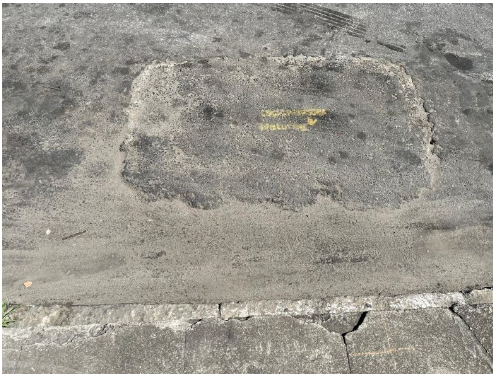
Foto 4: Recomposição provisória em trecho da Rua Áurea Fonseca de Jesus.
