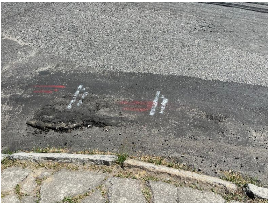
Foto 6: Recomposição provisória e afundamento da via.
