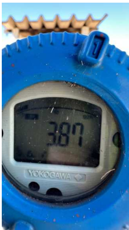
Foto 8: Pressão de saída da ERM da Concessionária – o gás entra no sistema a uma pressão de 40 bar e, posteriormente, tem sua pressão reduzida para 4 bar através das válvulas de regulagem.
