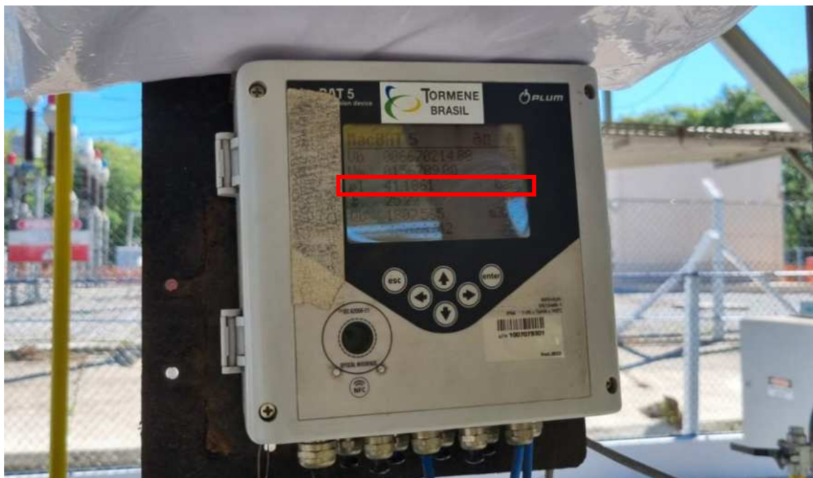
Foto 7: Monitoramento da ERM pela Concessionária, com destaque para a medição da pressão de entrada.
