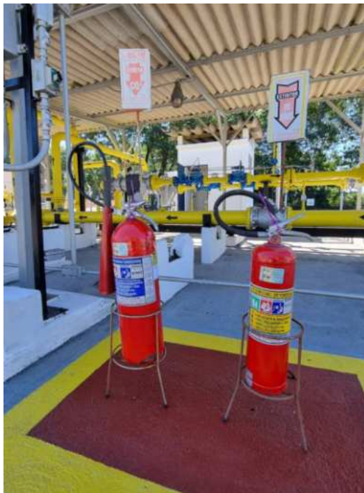
Foto 16: Extintores presentes na estação – os 2 (dois) foram verificados e estavam em conformidade.
