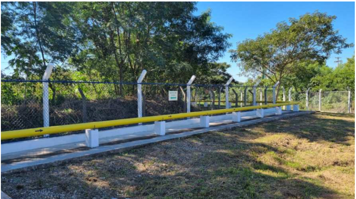
Foto 14: Cerca e sinalização de rota de fuga da estação.
