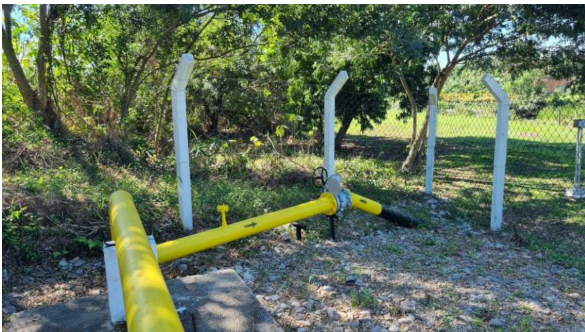
Foto 10: Linha de saída da ERM da FCC – o gás segue em direção à Fábrica Carioca de Catalisadores a uma pressão de 7 bar em tubulação de aço de 6”.
