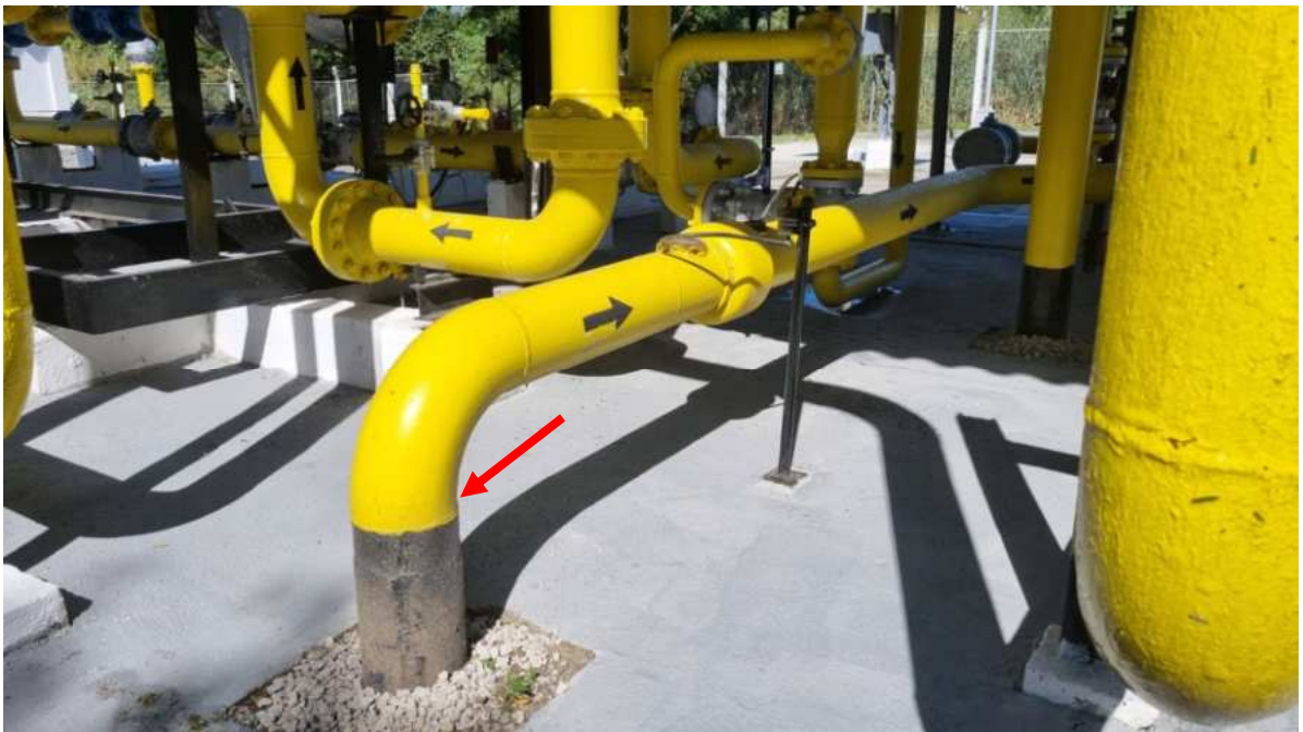
Foto 4: Linha de entrada (pressão de 40 bar em duto de aço de 6").
