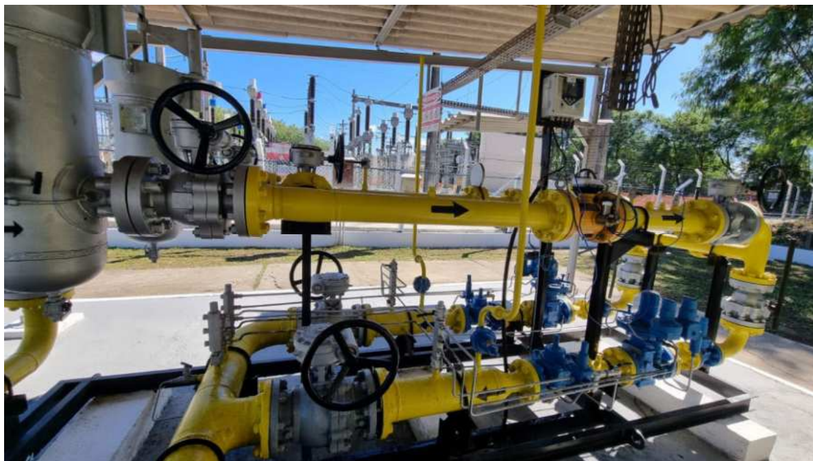
Foto 5: Estação de Regulagem e Medição da Concessionária.
