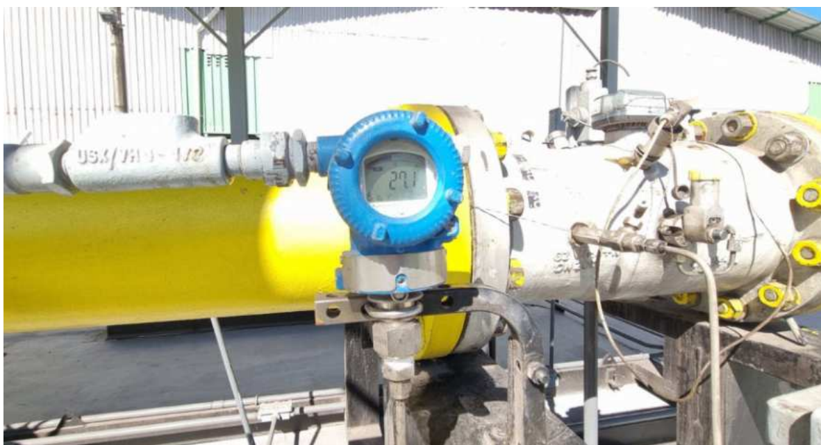
Foto 10: Pressão de saída – o gás entra na estação a uma pressão de 40 bar e, posteriormente, tem sua pressão reduzida para 26-27 bar através das válvulas de regulação.
