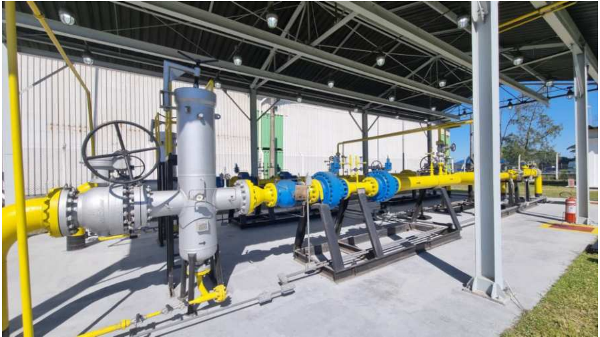
Foto 7: Estação de Regulagem e Medição.
