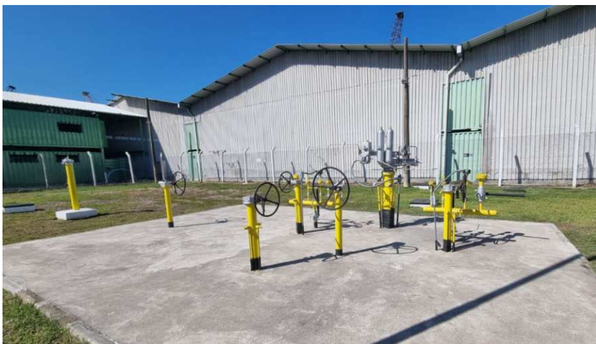
Foto 6: Conjunto de válvulas telecomandadas por qual passa o gás que seguirá em direção à UTE Furnas.
