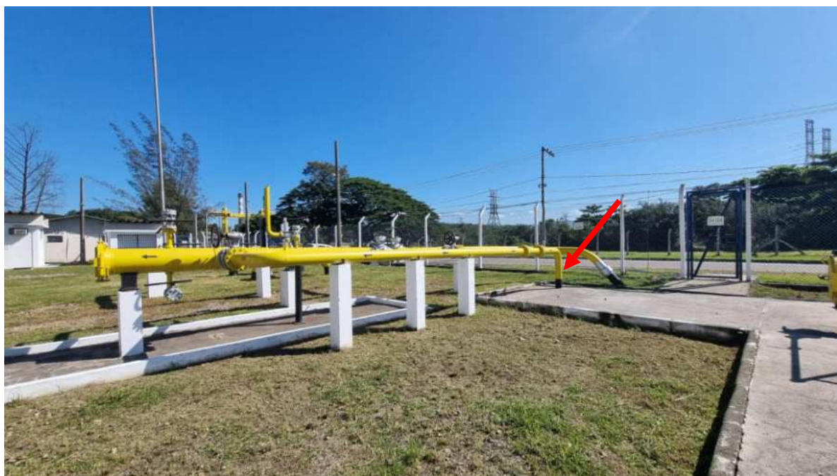
Foto 5: Linha de entrada do canhão lançador de PIG (pressão de 40 bar em duto de aço de 8'').
