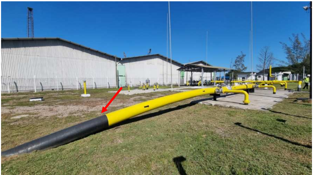
Foto 4: Linha de entrada do canhão lançador de PIG (pressão de 40 bar em duto de aço de 16").
