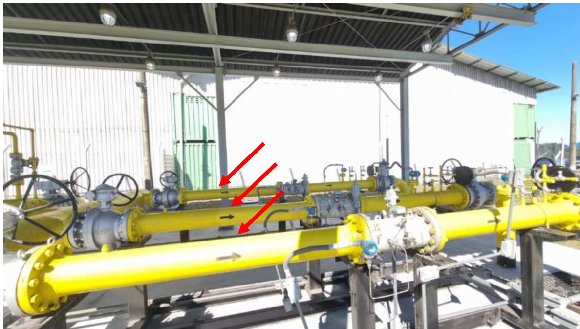
Foto 9: Linhas de medição da pressão do gás.
