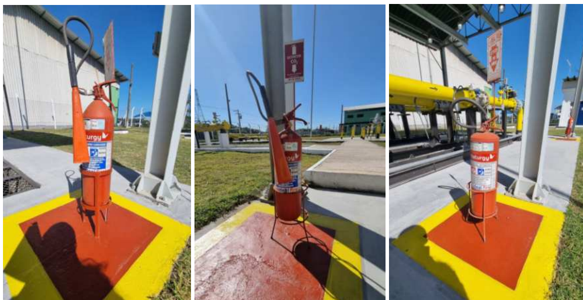
Foto 18: Extintores presentes na estação – os 3 (três) foram verificados e estavam em conformidade.
