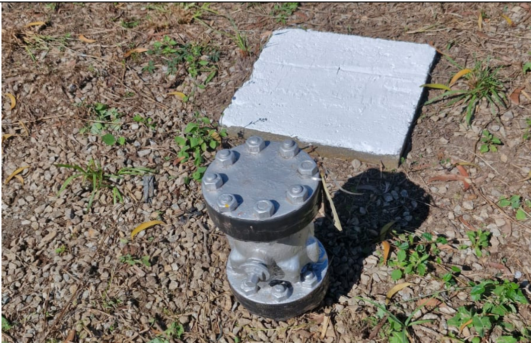
Foto 4: Caixa de visita, fechada, tubulação de apoio ao lado.
