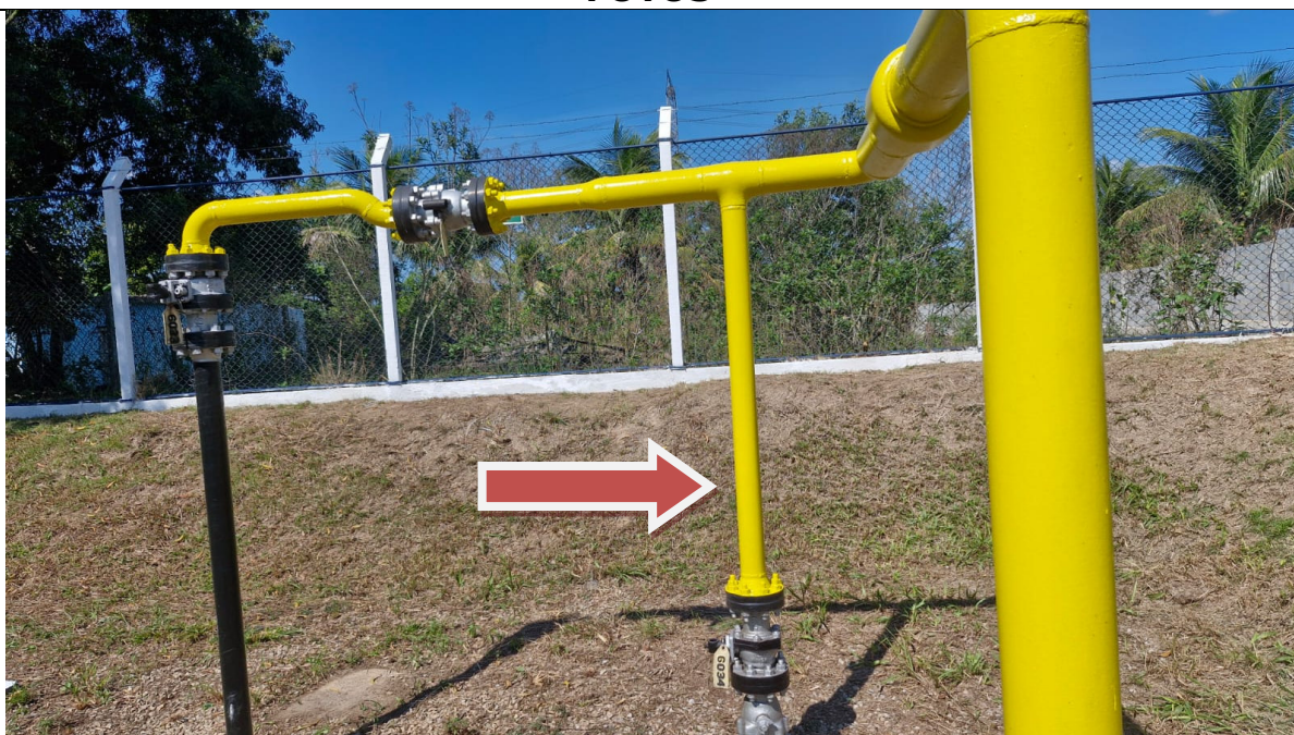
Foto 2: Duto, com derivação em destaque.
