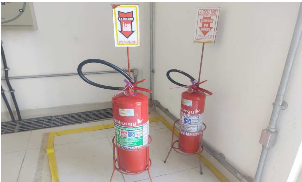
Foto 18: Extintores devidamente acomodados.
