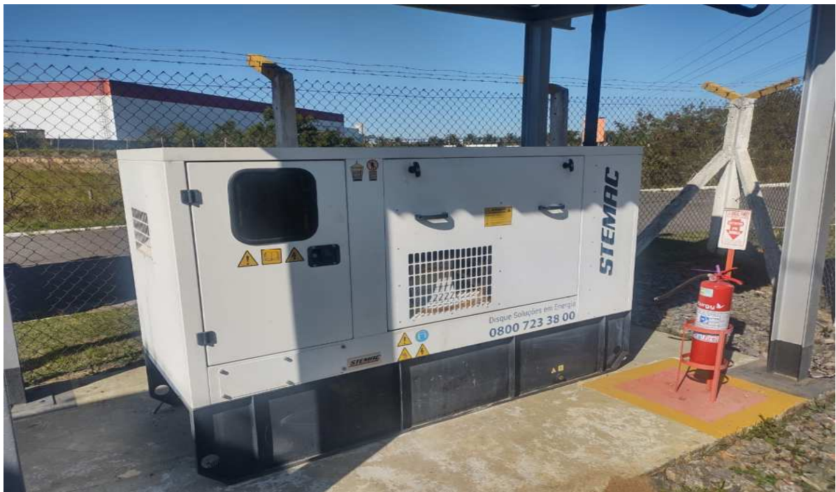
Foto 10: Gerador a diesel.
