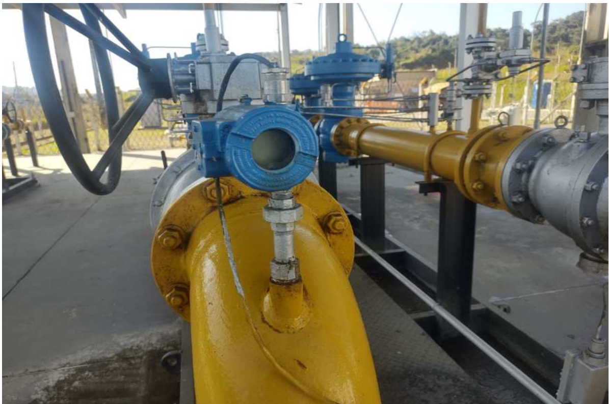
Foto 14: Equipamento de medição fora de operação.
