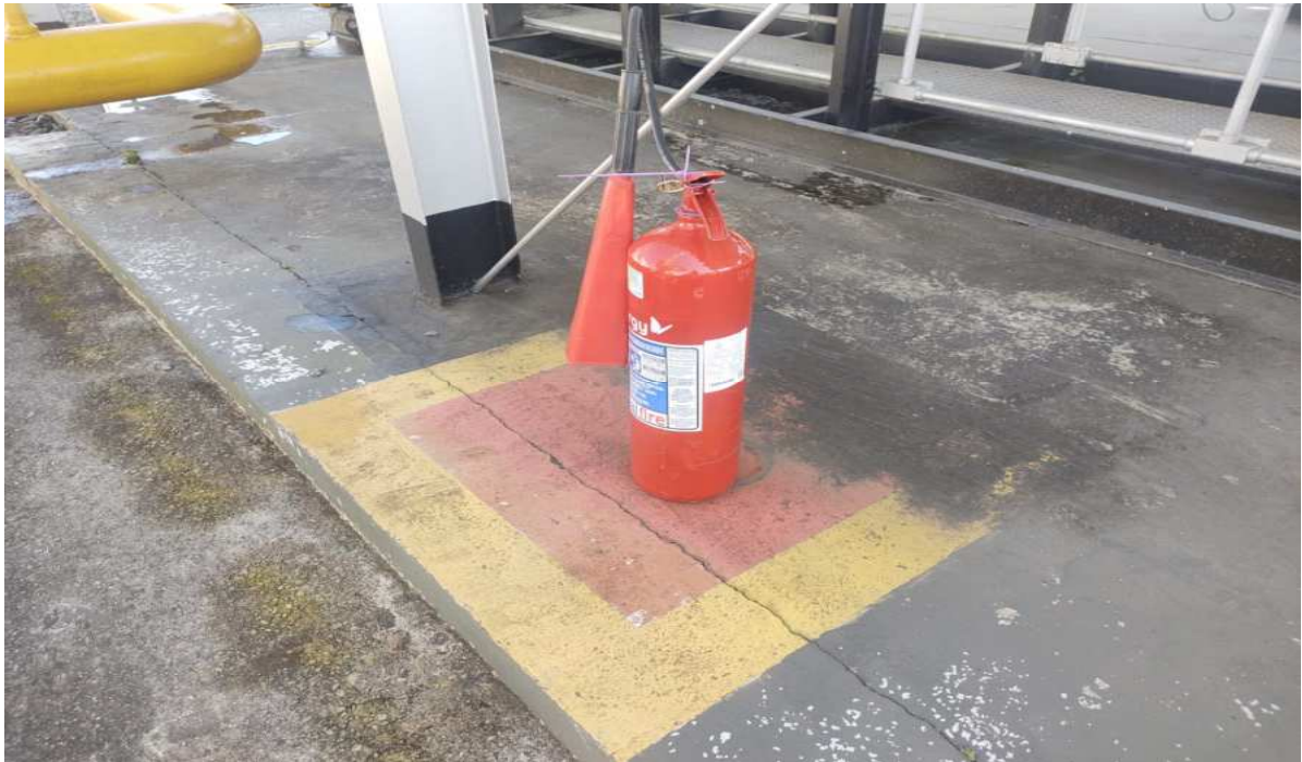
Foto 13: Extintor sem a devida acomodação.
