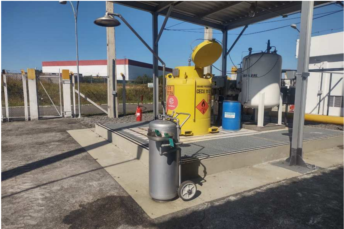
Foto 7: Sistema de odorização, chuveiro e lava olhos.
