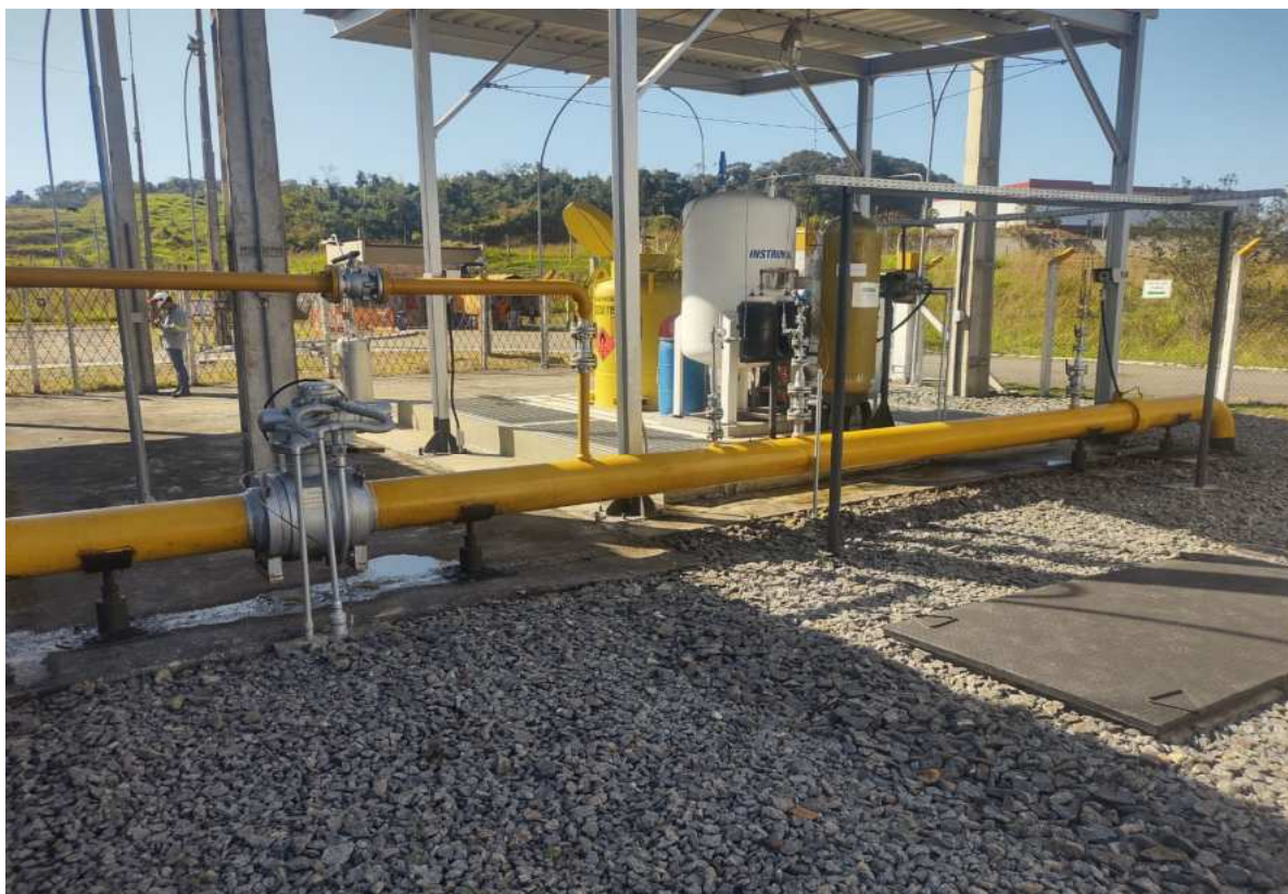
Foto 5: Saída da ETC e passagem pelo sistema de odorização.
