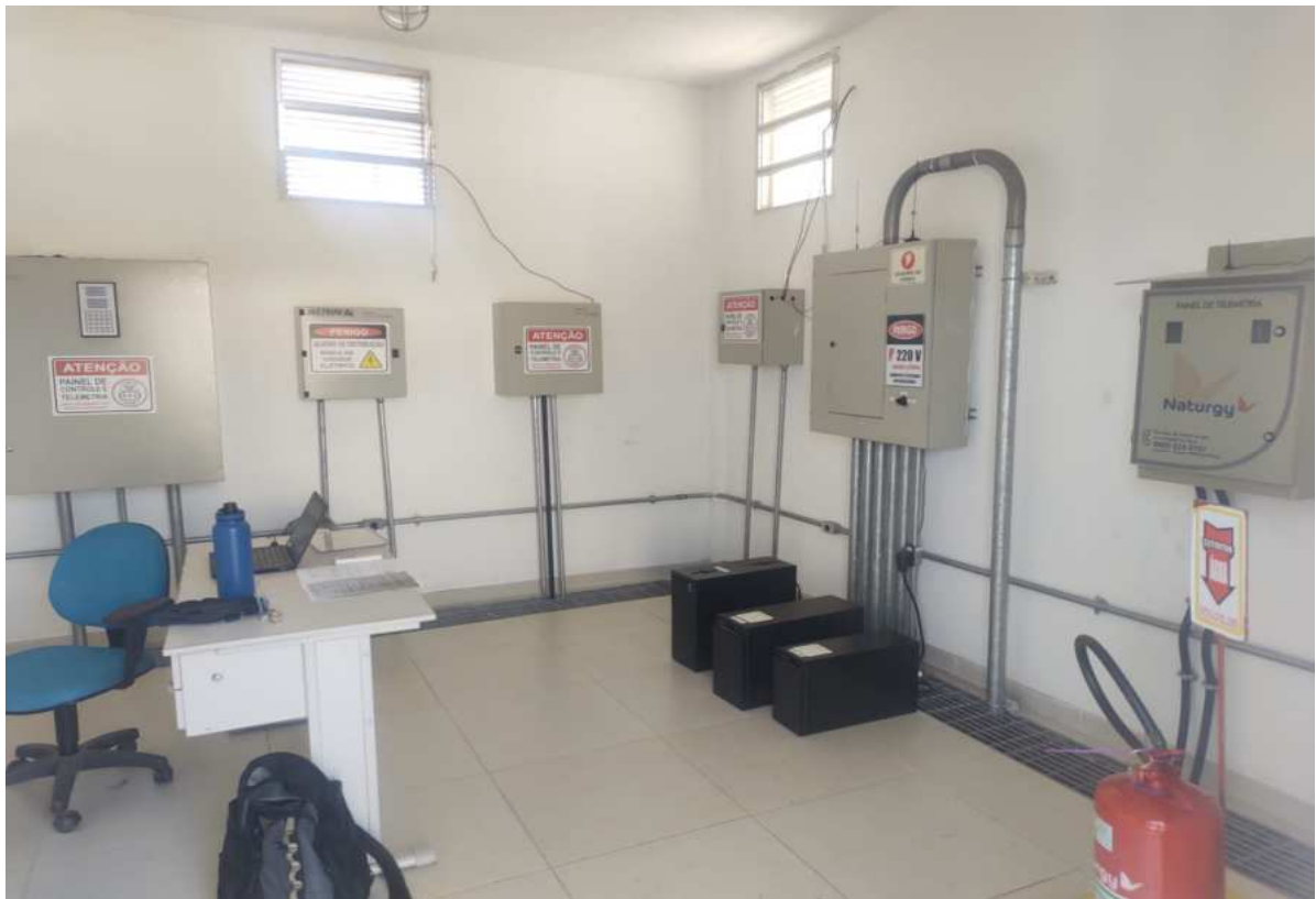
Foto 9: Sala com equipamentos elétricos e telemetria.
