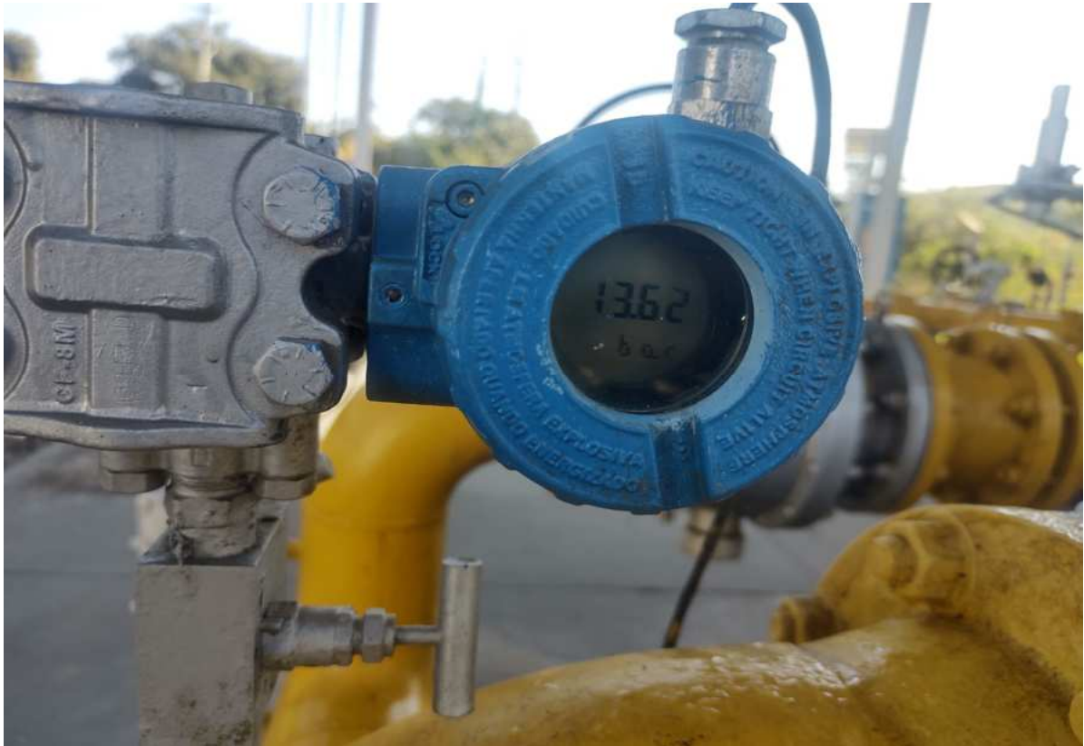
Foto 11: Manômetro na saída da primeira estação.
