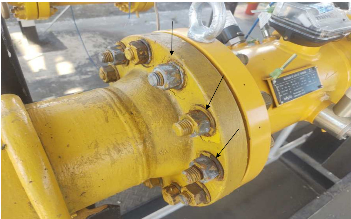
Foto 12: Pintura inadequada na conexão do medidor de gás turbina com a tubulação da estação.
