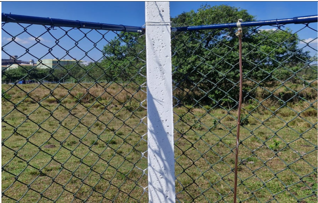
Foto 8: Grade e fio de aterramento.
