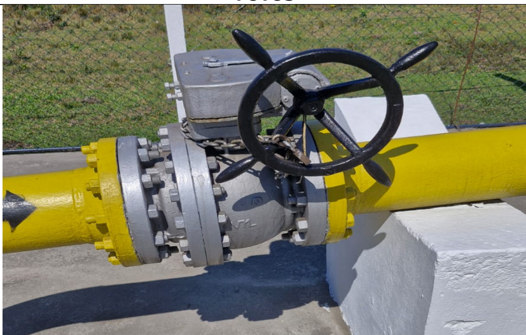
Foto 2: Válvula de linha no detalhe.
