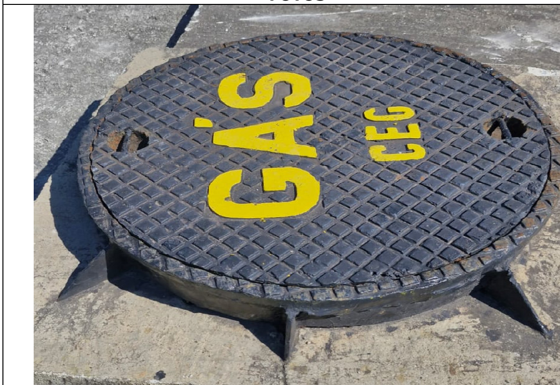
Foto 4: Caixa de visita, fechada.
