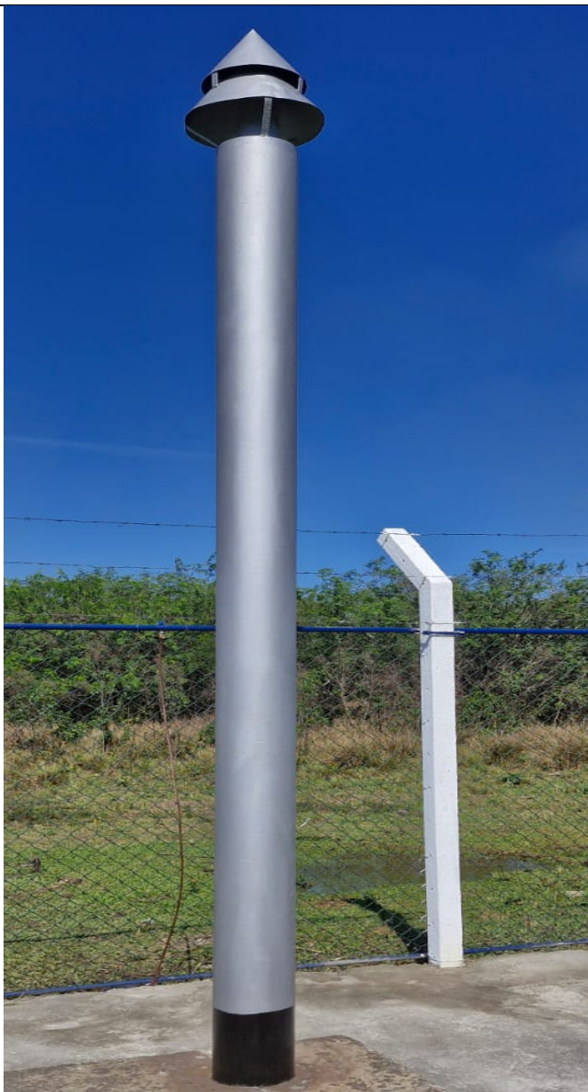
Foto 9: Exausto da caixa de visita.
