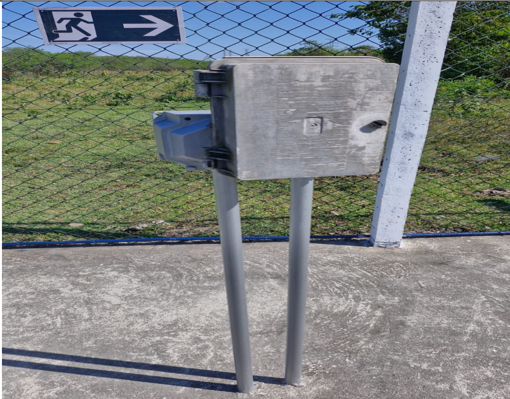
Foto 7: Proteção Catódica. Sinalização de Rota de Fuga na grade ao fundo.
