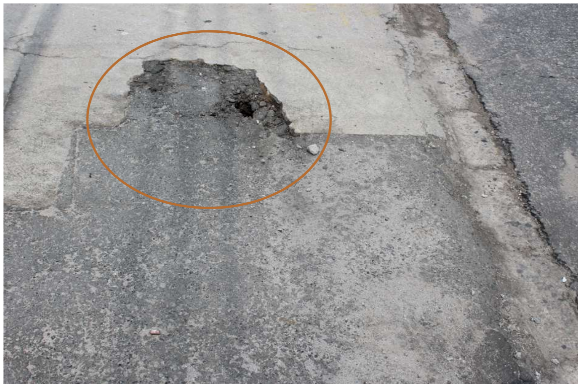
Foto 4: Falha na recomposição do passeio (antes).
