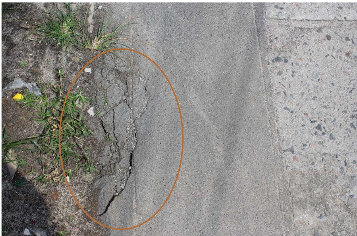
Foto 2: Falha na recomposição do passeio (antes).
