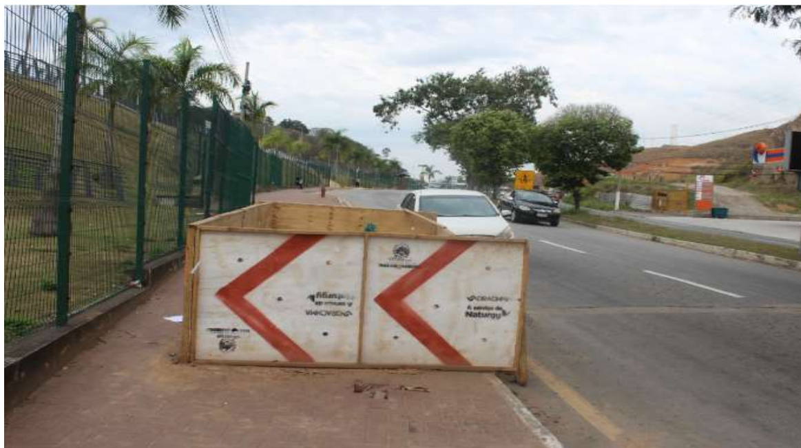
Foto 5: Tapume sem sinalização (antes).
