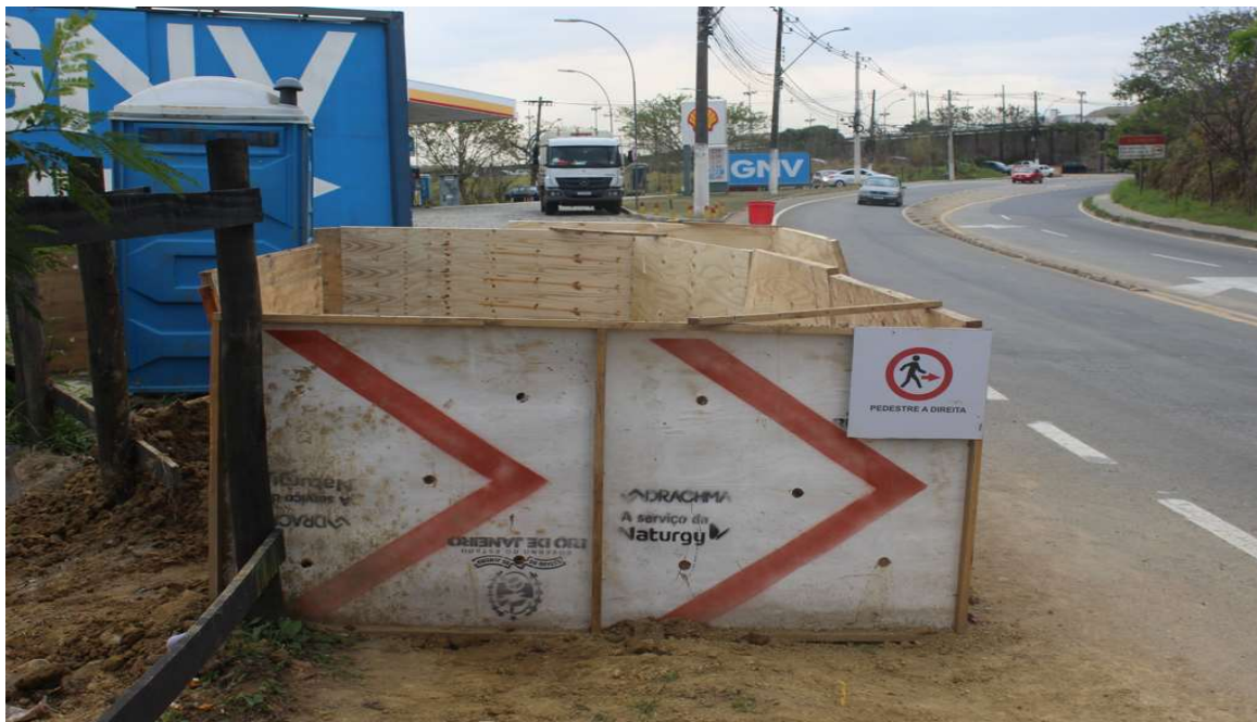
Foto 15: Tapume com sinalização insuficiente (antes).
