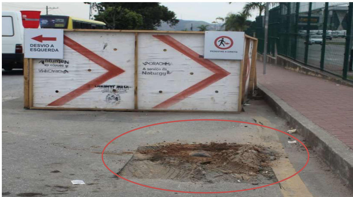
Foto 3: Obra na via sem proteção e sinalização (antes).
