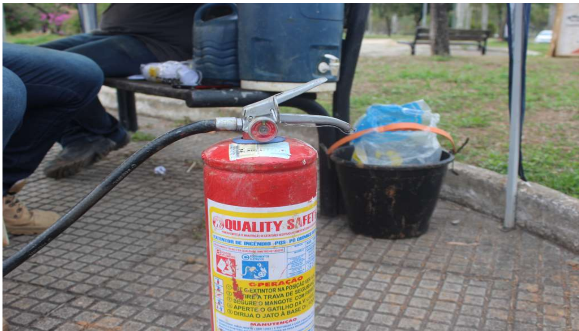
Foto 23: Extintor sem o lacre.
