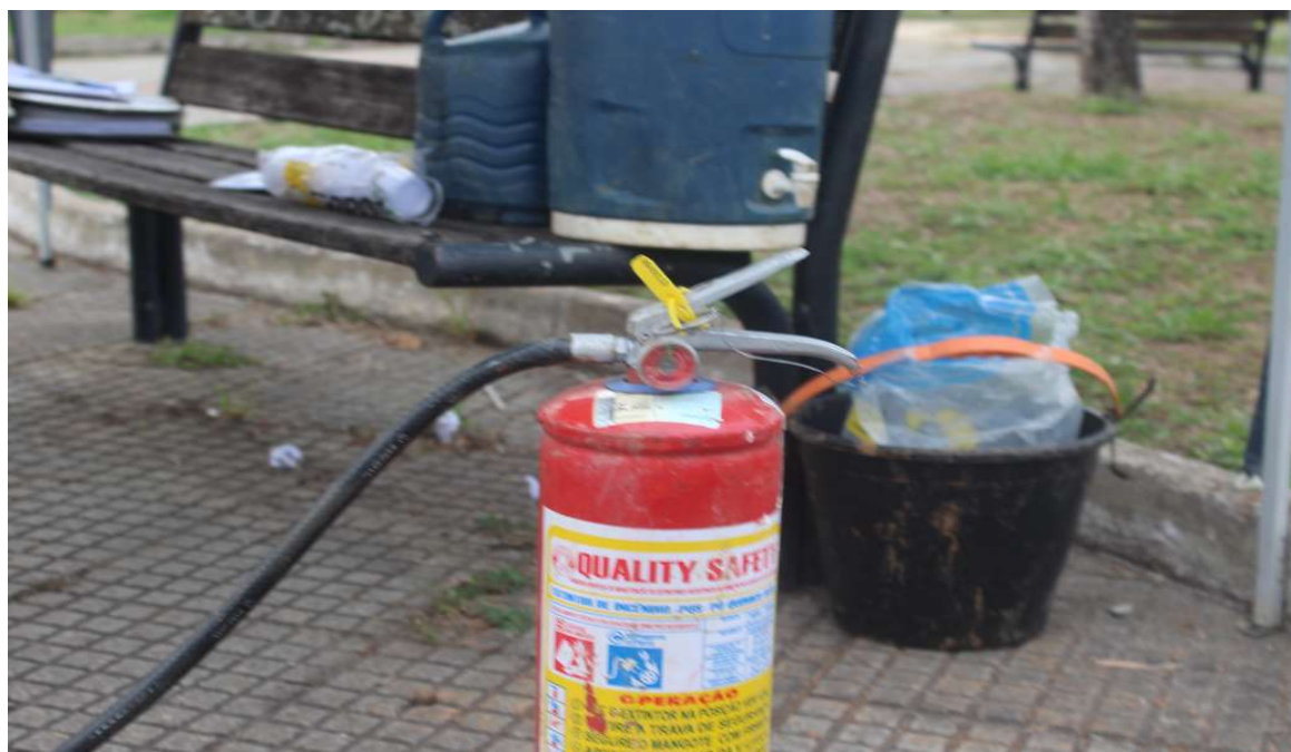
Foto 24: Extintor com o lacre.
