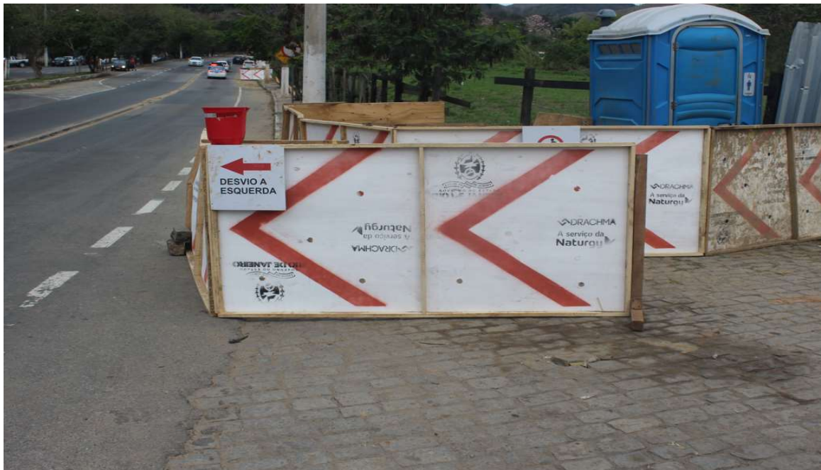
Foto 13: Tapume com sinalização insuficiente (antes).
