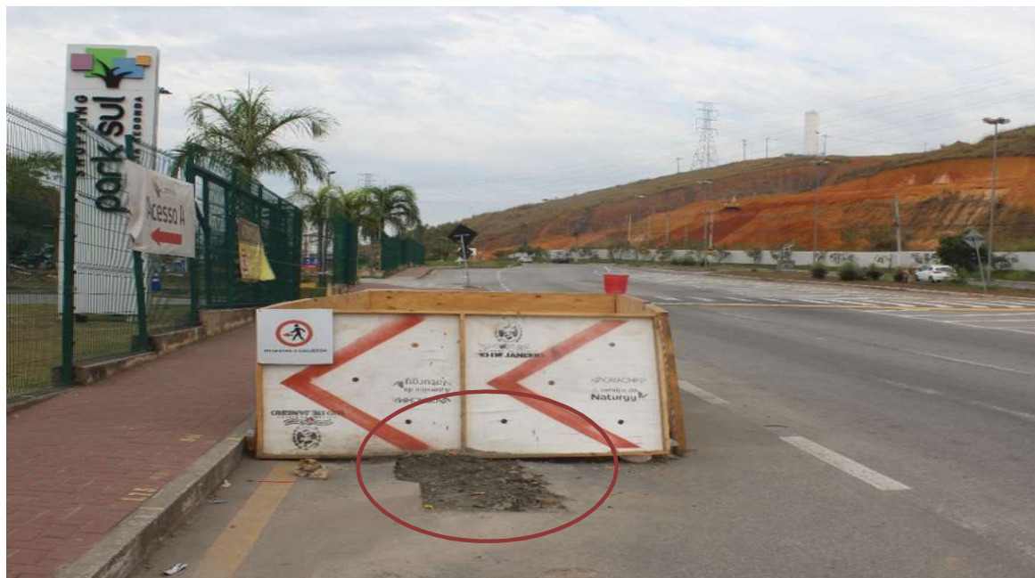
Foto 1: Tapume desalinhado e obra fora da baia (antes).
