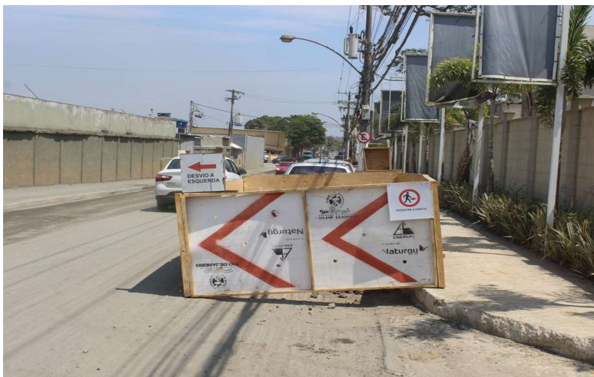
Foto 1: Tapume sem sinalização luminosa.
