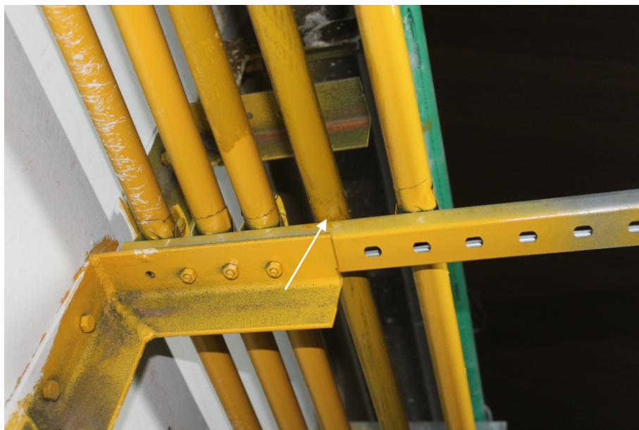
FOTO 11 – Tubulação sem fixação e sem isolamento
