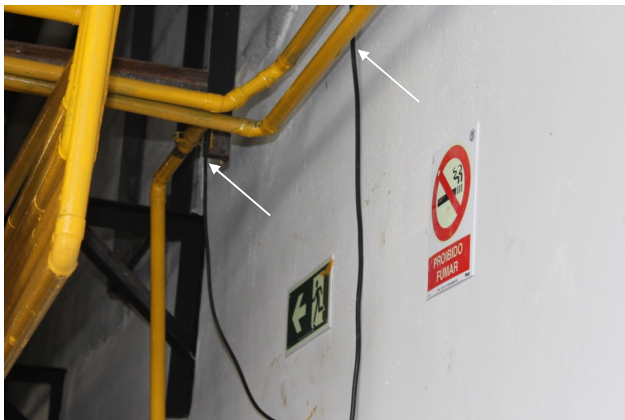
FOTO 13 – Passagem da tubulação junto a cabeadamentos (< 20 cm)
