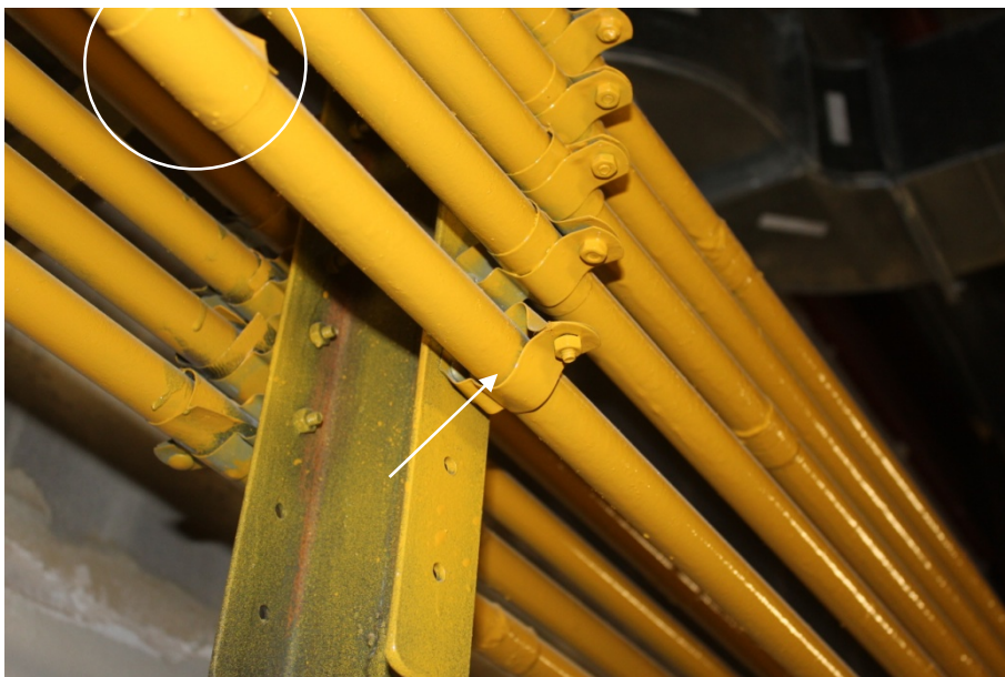
FOTO 21 – Tubulação sem isolamento (isolamento deslocado de posição)
