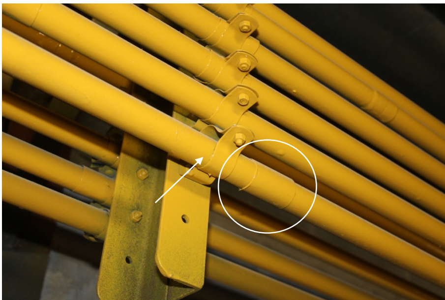
FOTO 23 – Tubulação sem isolamento (isolamento deslocado de posição)
