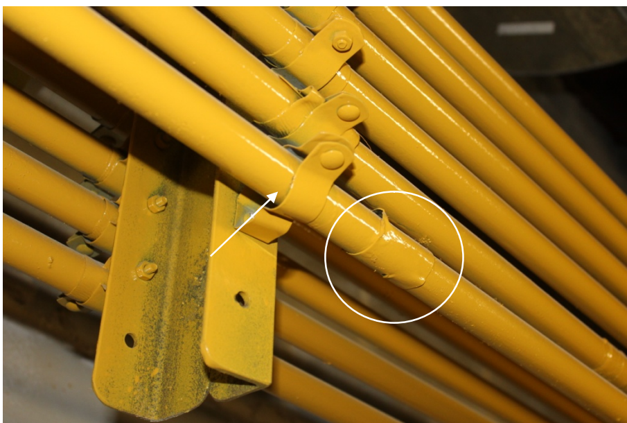
FOTO 22 – Tubulação sem isolamento (isolamento deslocado de posição)
