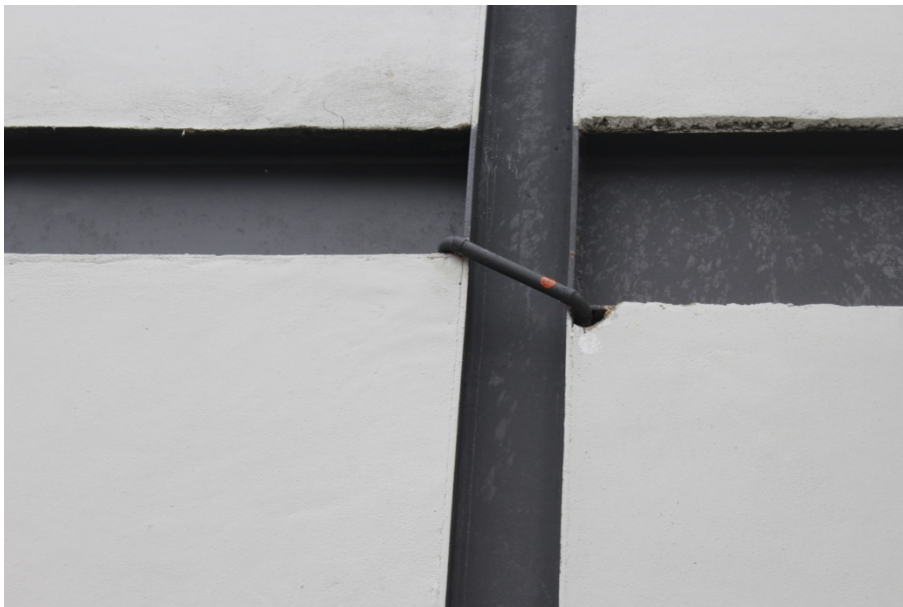
FOTO 01 – Passagem da tubulação pela fachada
