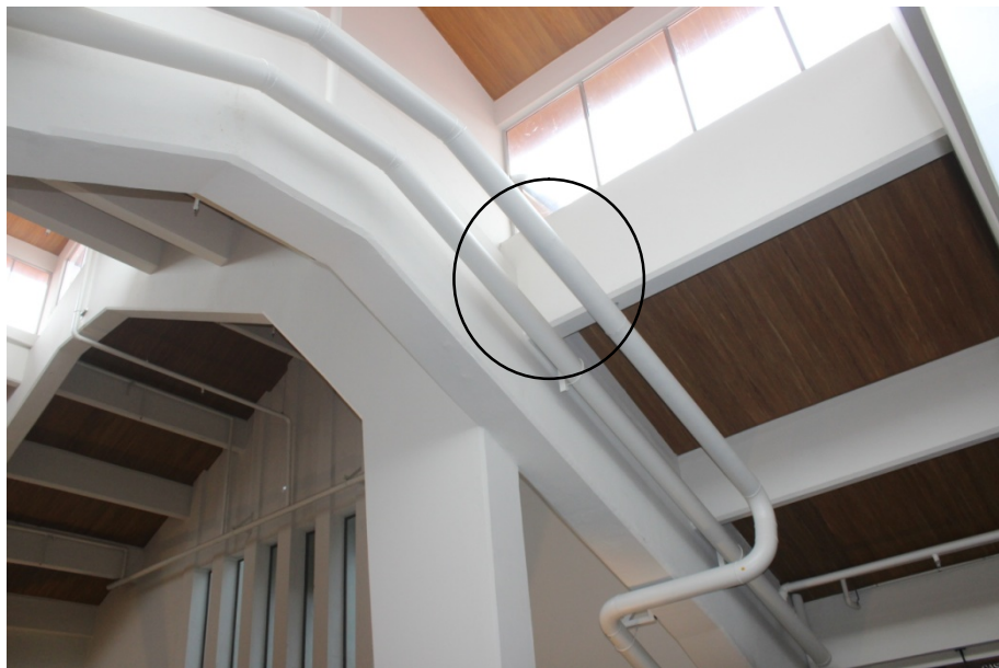
FOTO 08 – Tubulação aérea pintada e sem identificação
