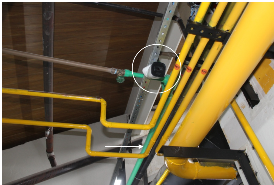
FOTO 09 – Camera de vigilância e tubulação de outra natureza junto à rede de gás (< 20 cm)
