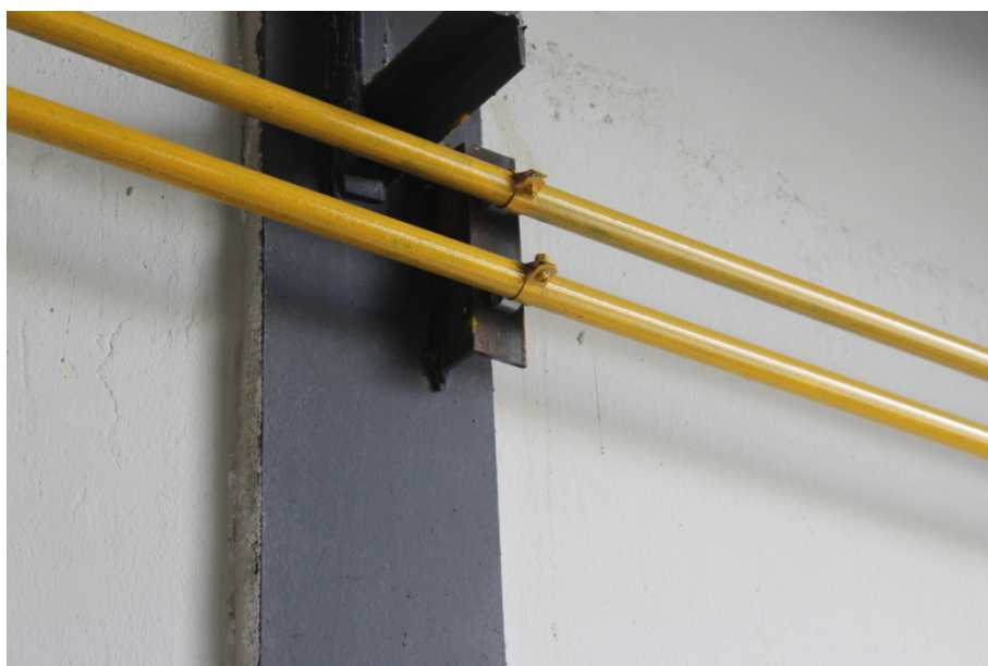
FOTO 16 – Tubulação sem isolamento
