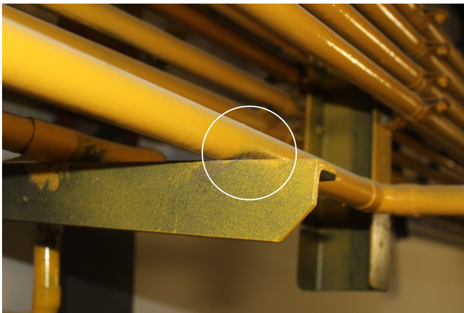
FOTO 17 – Tubulação sem fixação / isolamento
