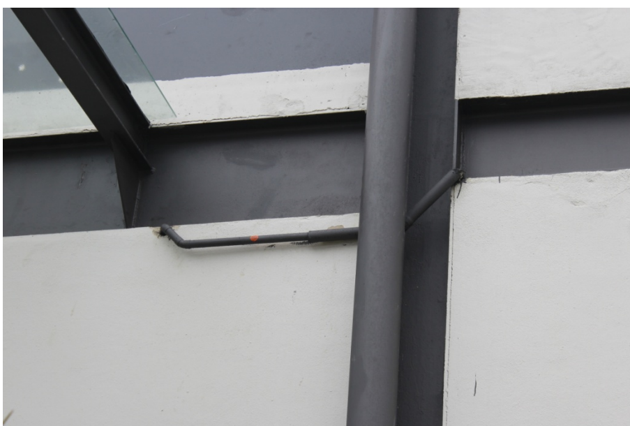
FOTO 02 – Passagem da tubulação pela fachada
