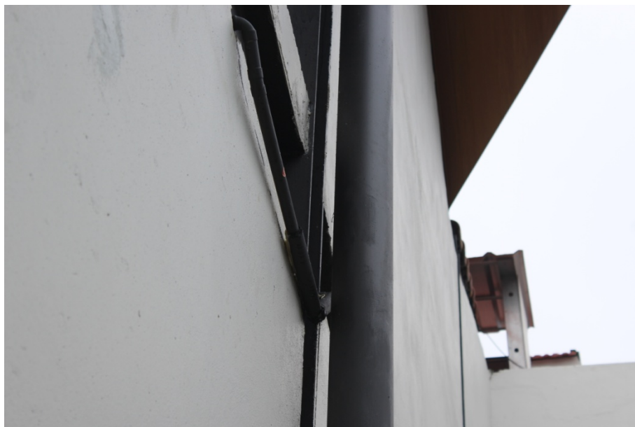
FOTO 03 – Passagem da tubulação pela fachada
