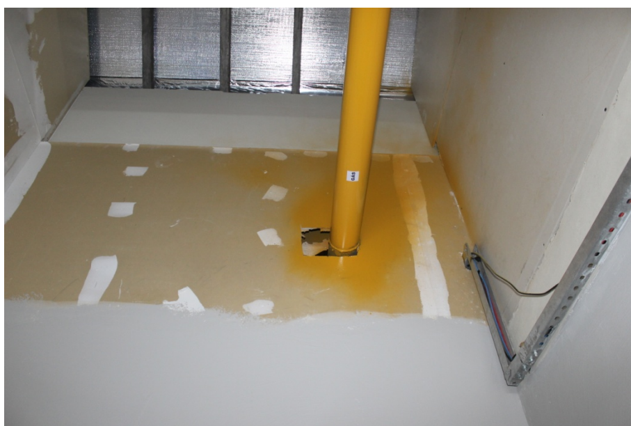
FOTO 04 – Passagem da tubulação através de parede, sem encamisamento, propiciando ambiente confinado
