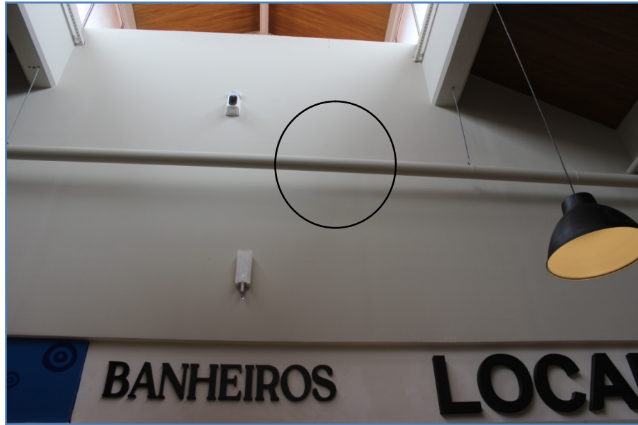
FOTO 07 – Tubulação aérea pintada e sem identificação
