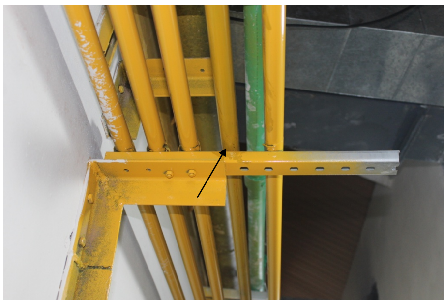
FOTO 10 – Tubulação sem fixação e sem isolamento
