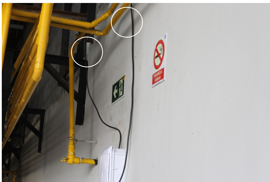
FOTO 12 – Passagem da tubulação junto a cabeamentos (< 20 cm)
