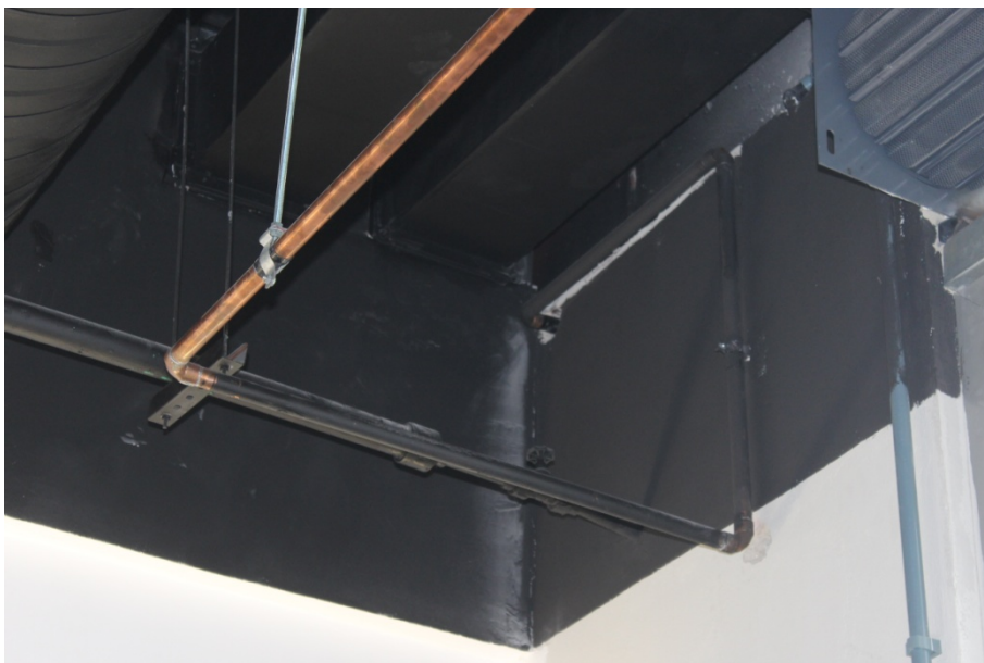
FOTO 29 – Tubulação aérea de cobre ainda sem pintura / identificação
