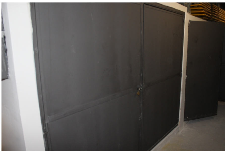
FOTO 28 – Porta cega de um PI sem abertura inferior (área a ser verificada no projeto)
