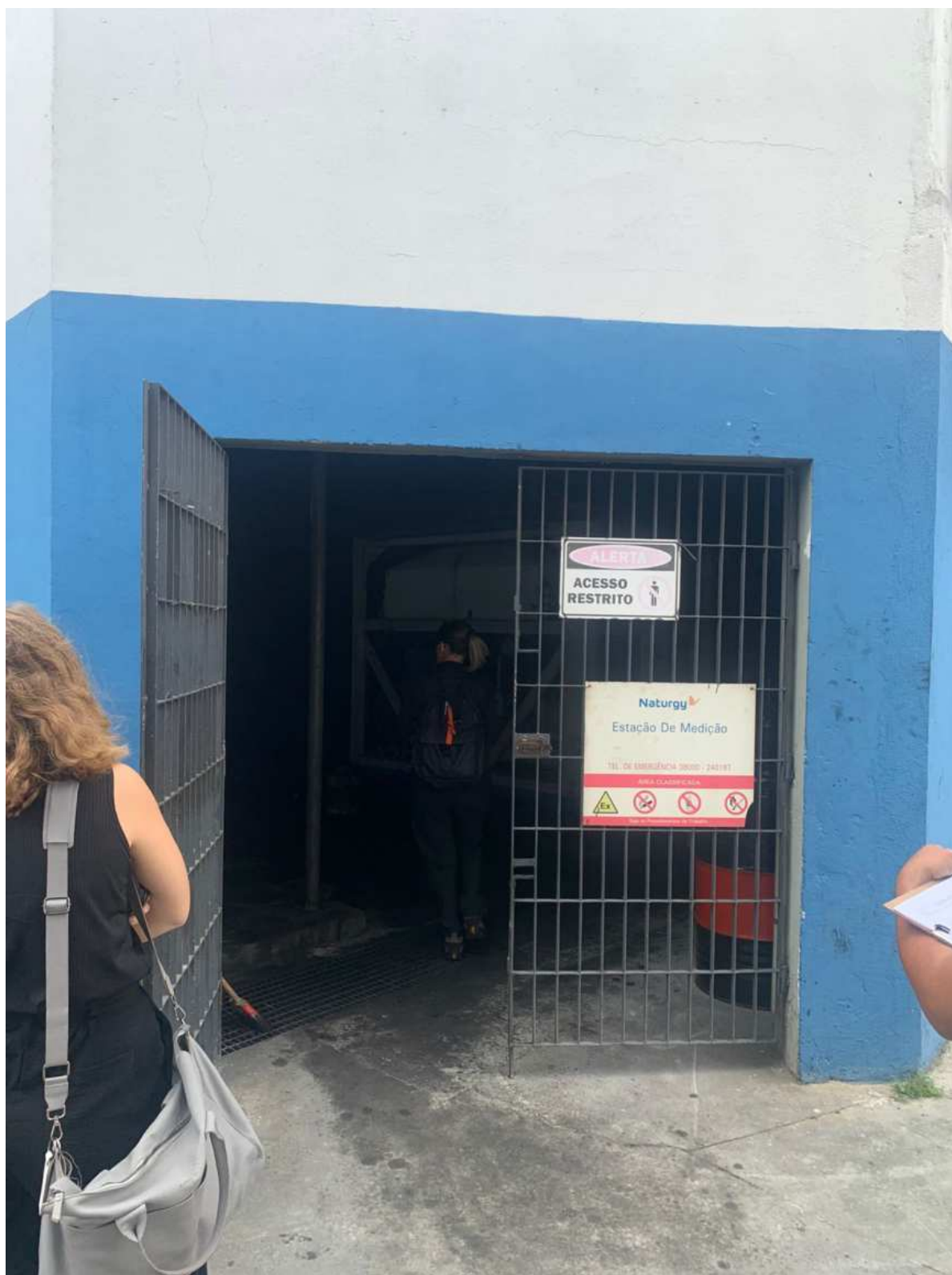
Foto 12: Entrada da estação de medição de GNV do posto.
