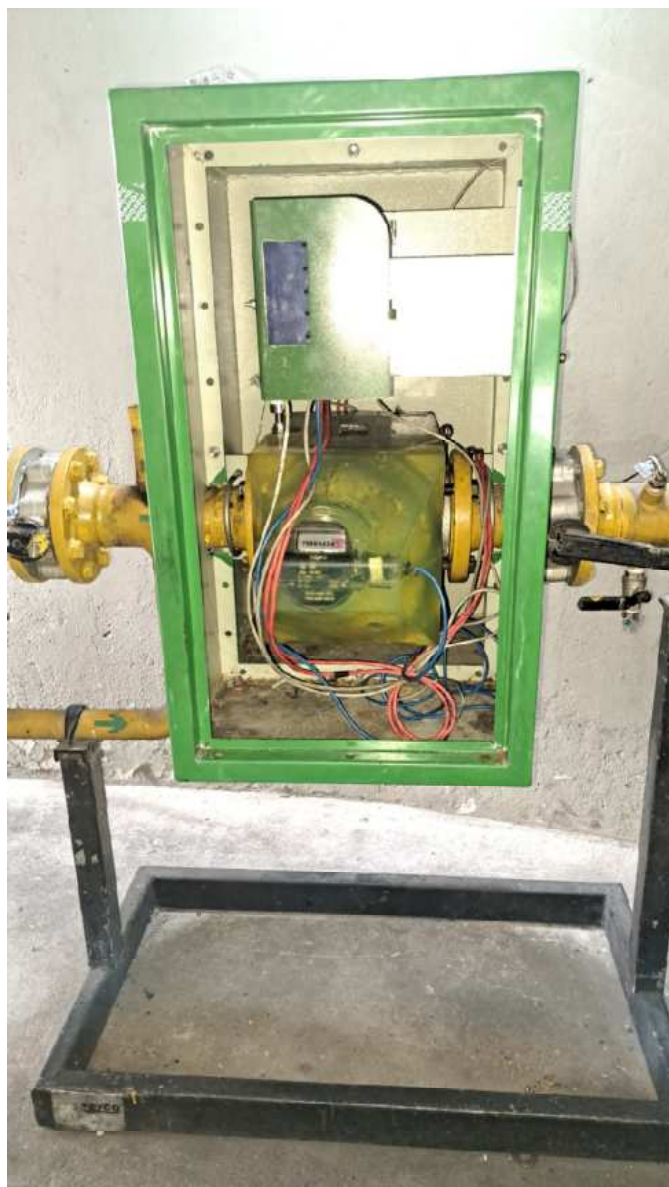
Foto 6: Medidor do posto.
