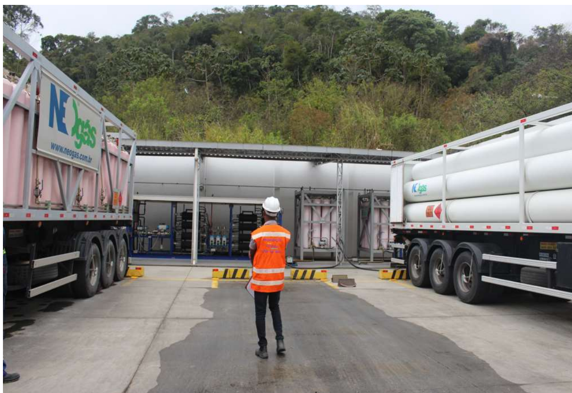
Foto 2: Pátio de estacionamento dos caminhões com cilindros para descompressão do gás.
