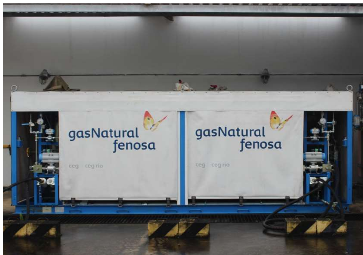
Foto 2: RCU e mangueiras de abastecimento
