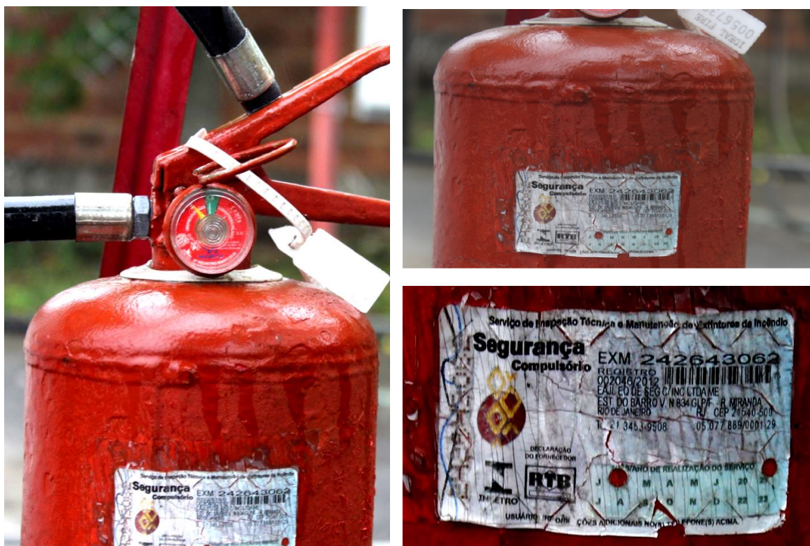
Foto 2: Extintor sem pressão de carga e inspeção vencida.
