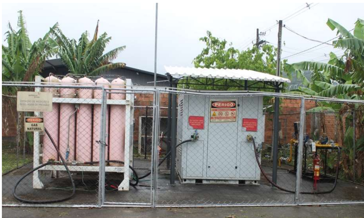
Foto 1: Entrada da estação de decompressão de gás natural de Cachoeiras de Macacu.
