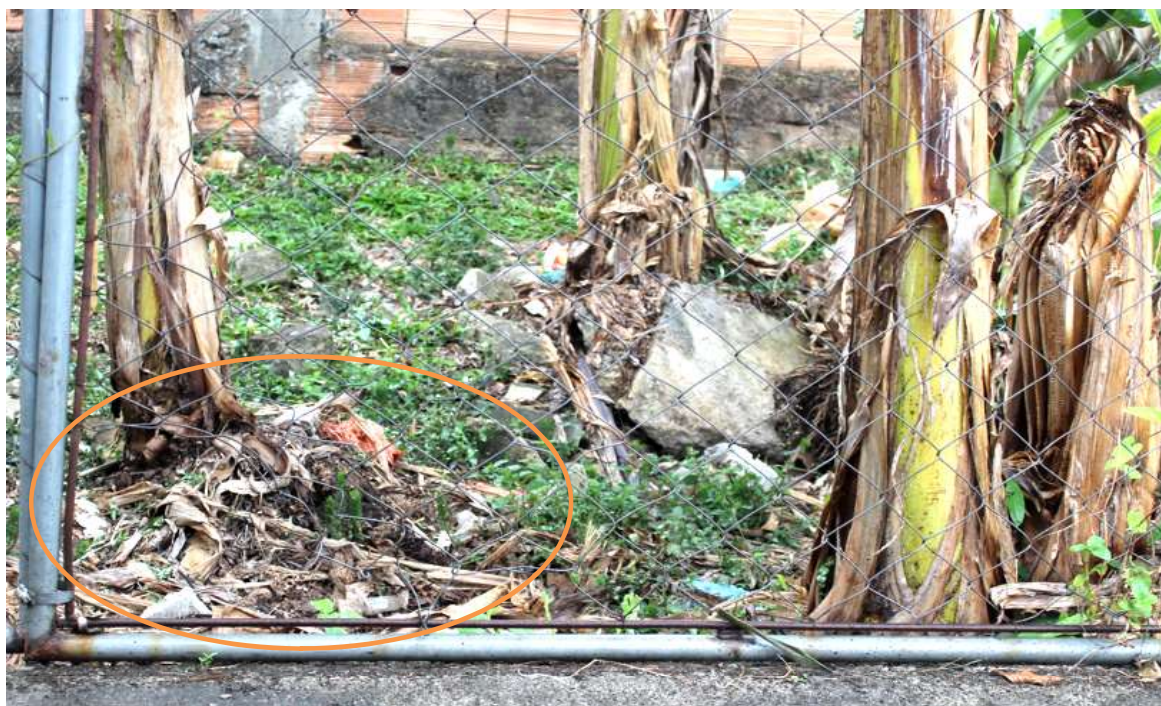
Foto 3: Abertura na cerca de vedação da estação (antes).
