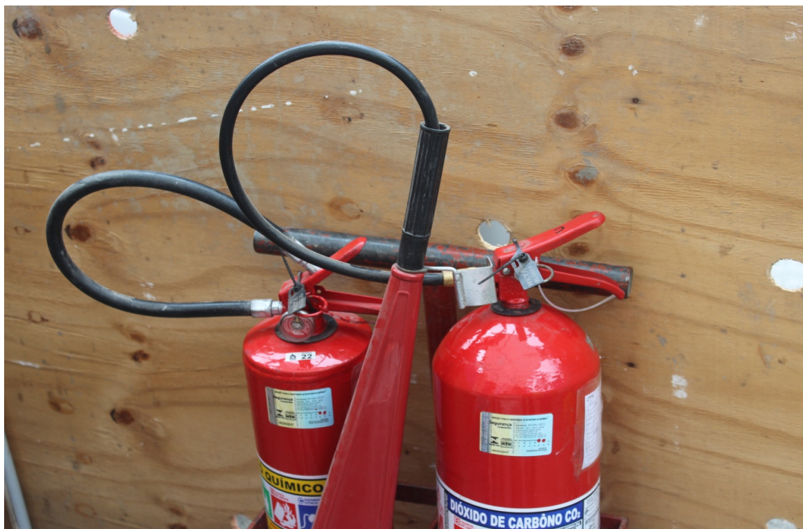
Foto 9: Extintor de Pó Químico e CO2
