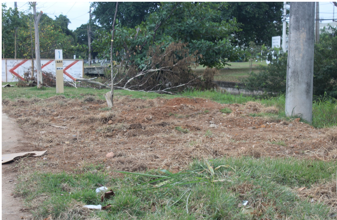
Foto 9: Gramado danificado onde foi realizada uma abertura
