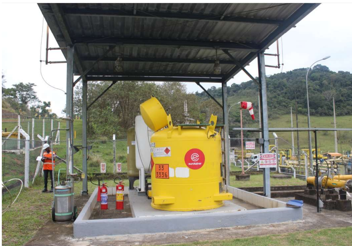
Foto 4: Ausência de sinalização de rota de fuga
