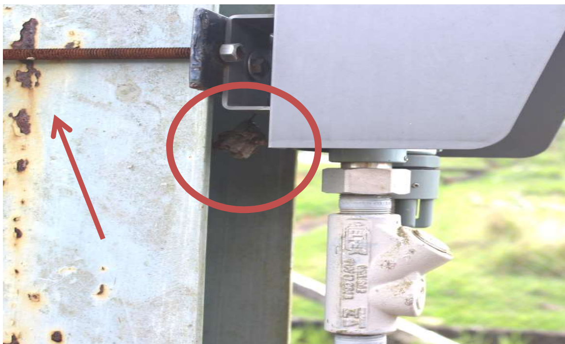
Foto 5: Presença de marimbondos e mau estado de conservação
