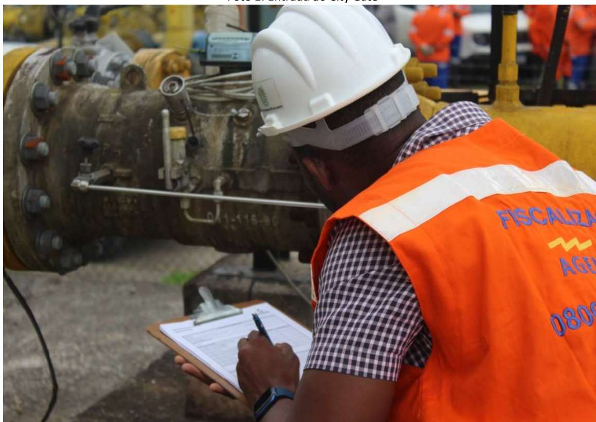
Foto 2: Equipamento sem pintura e com oxidação
