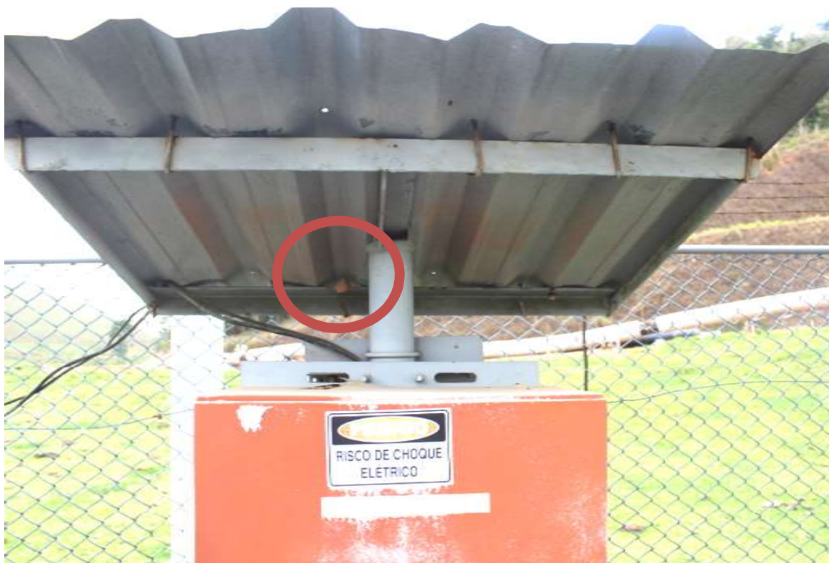
Foto 6: Presença de marimbondos
