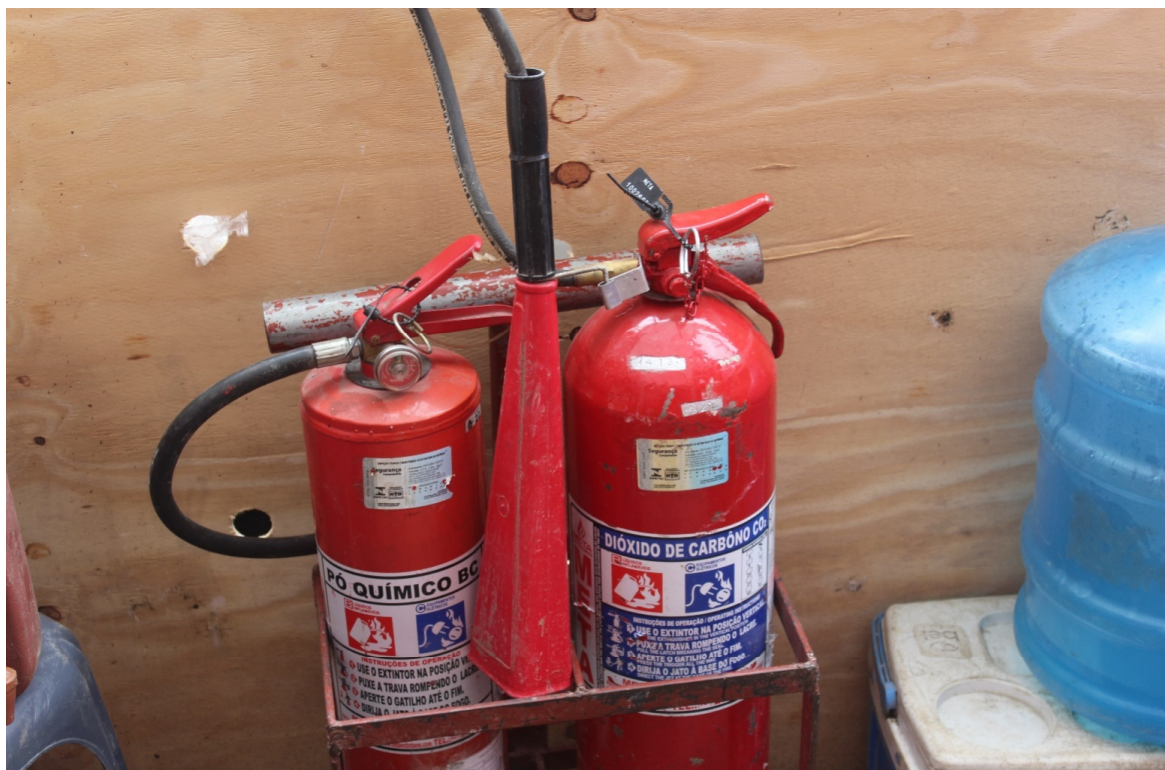
Foto 9: Extintor de Po Químico e CO2
