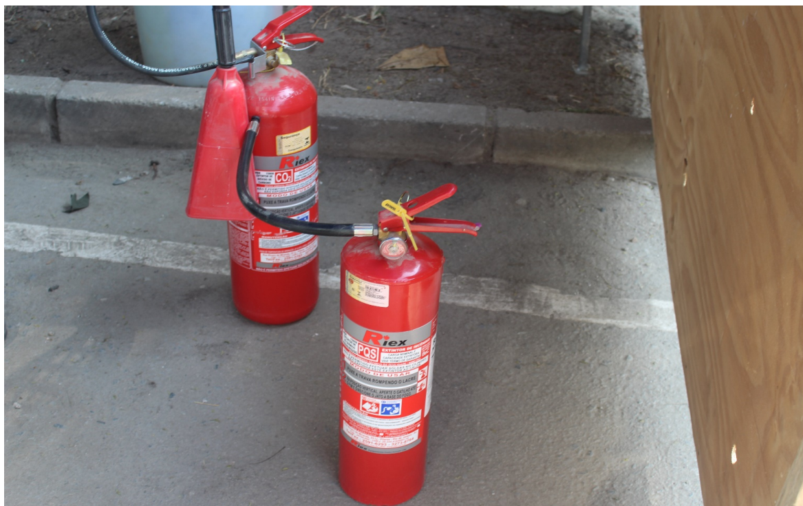
Foto 8: Extintor de CO2 e PQS
