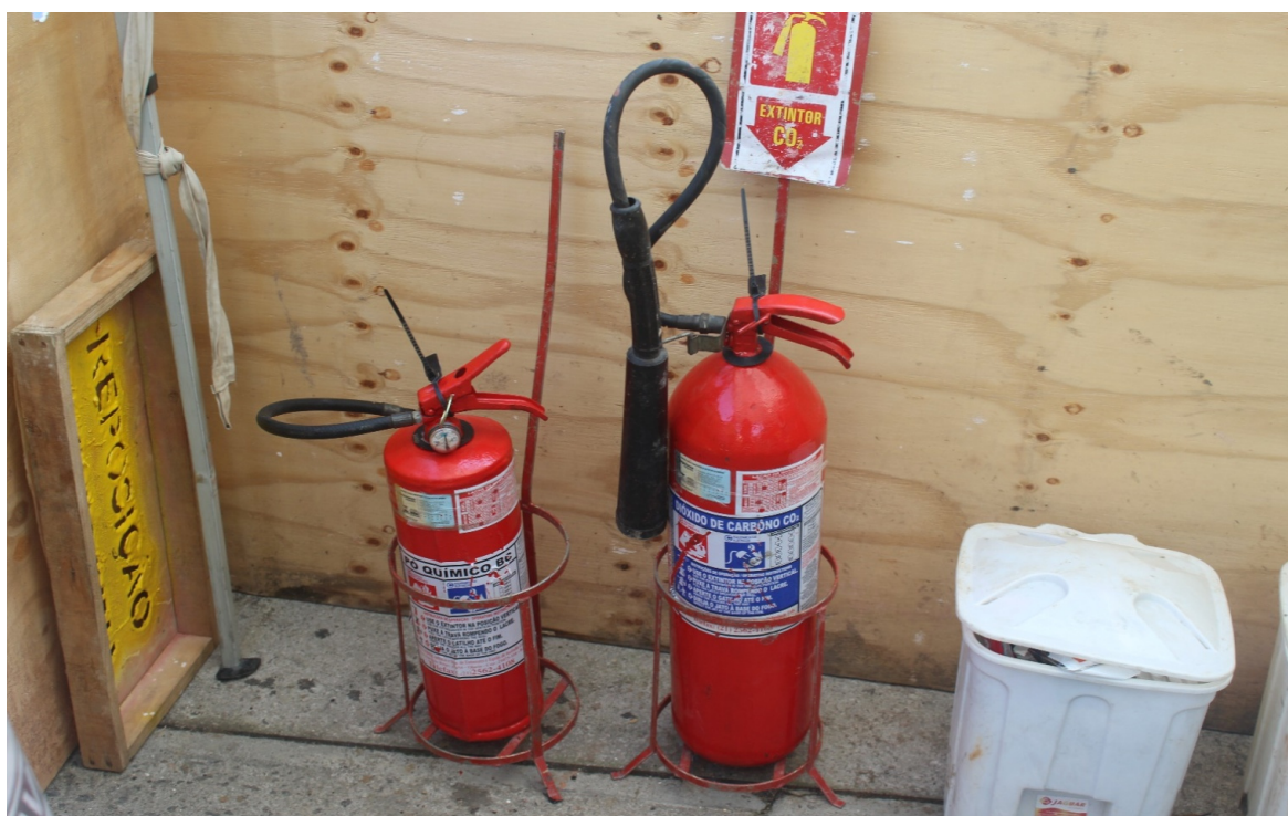
Foto 6: Extintores de Pó Químico e CO2
