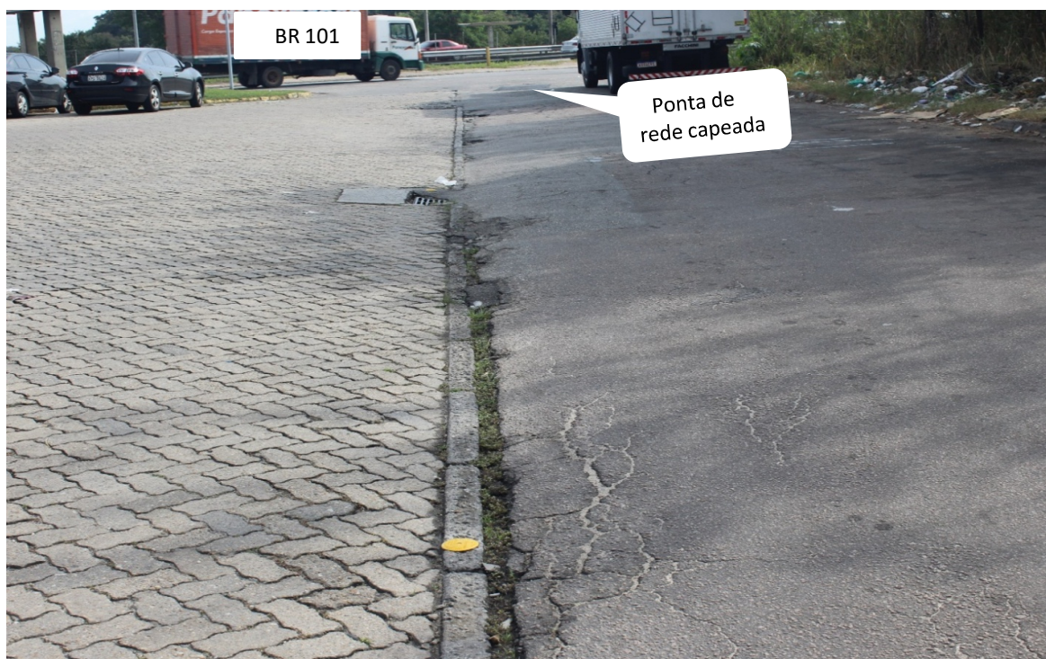
Foto 8: Trecho de rede pressurizada e com marco plano
