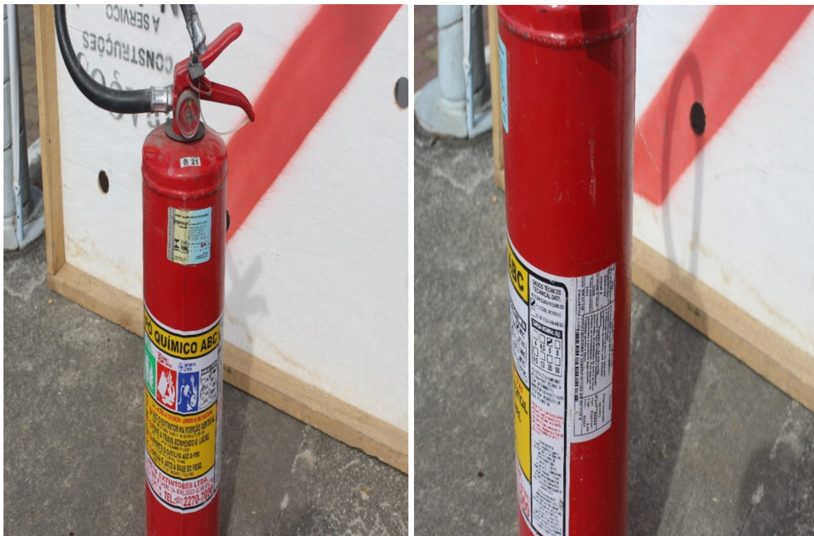
Foto 11: Extintor de Pó Químico com prazo de inspeção vencido
