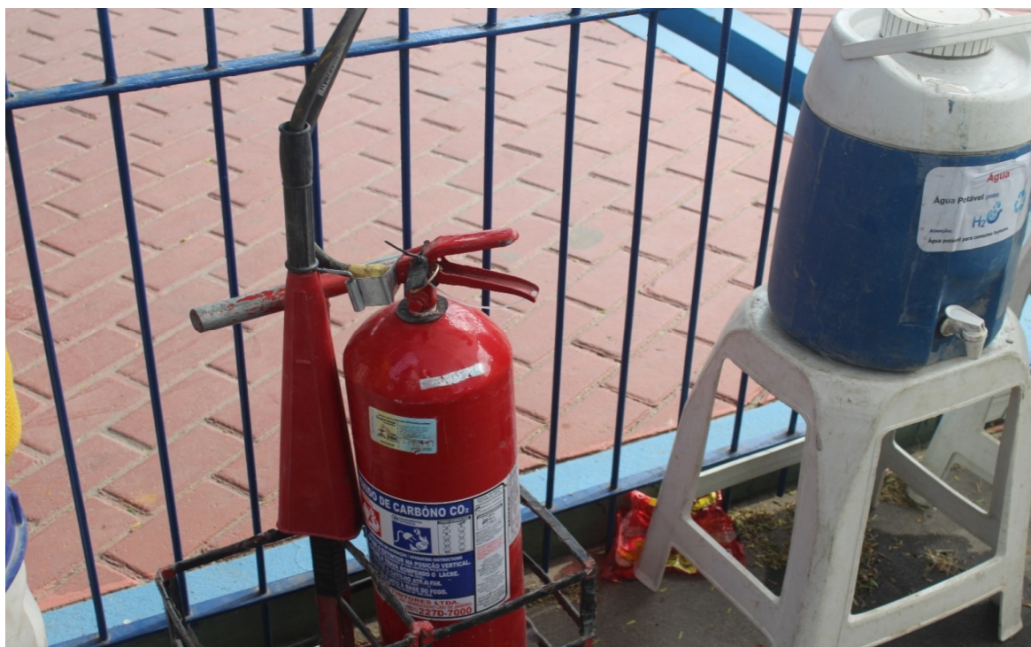
Foto 10: Extintor de CO2
