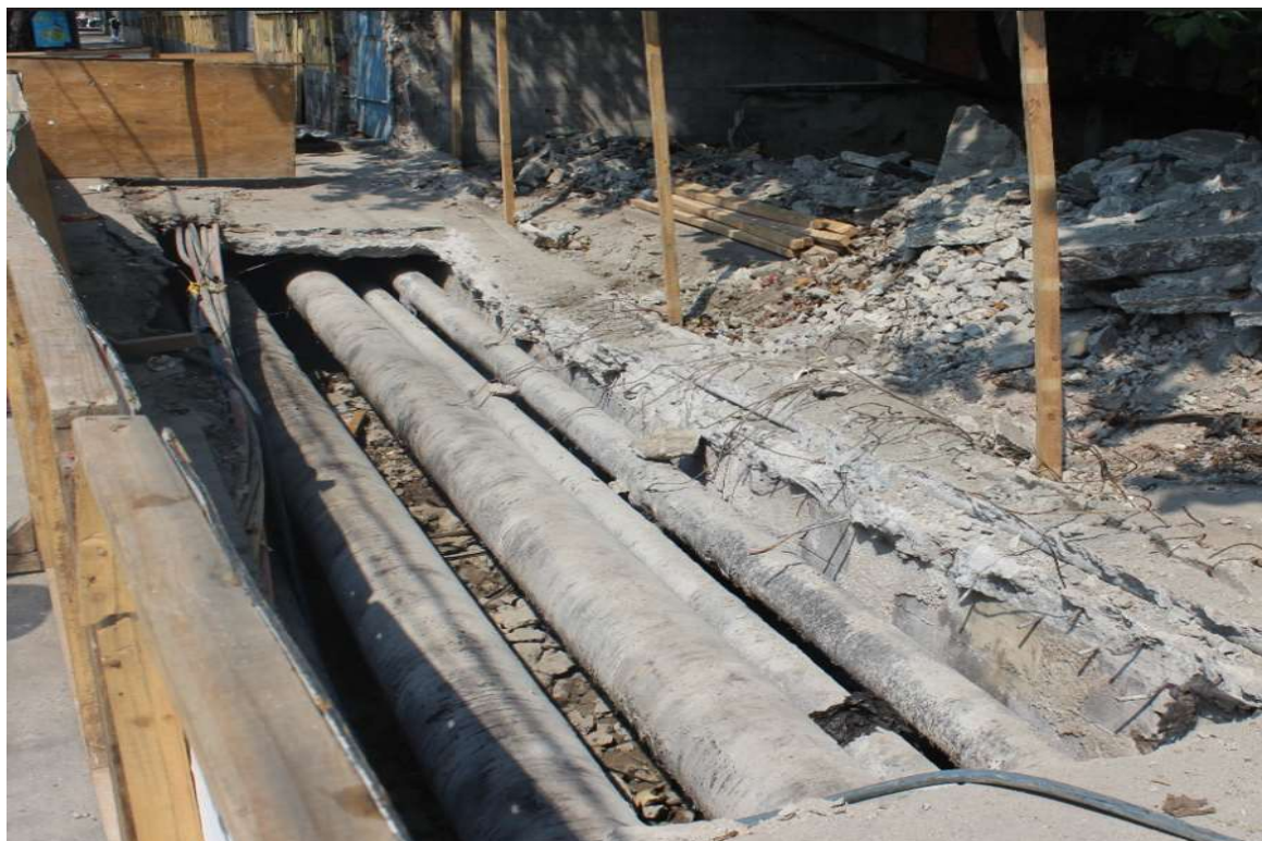
Foto 4 : Obra de emergência na Avenida Francisco Bicalho n.º 3271, provocado por um afundamento.
