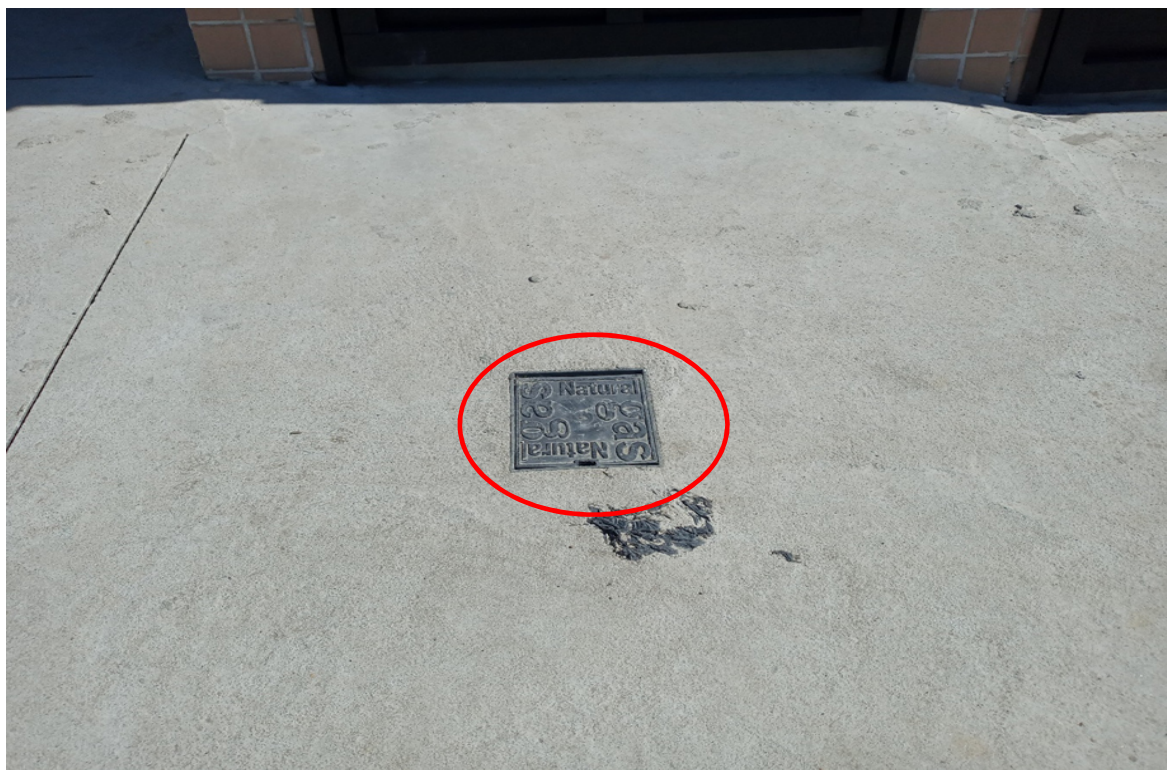
Foto 9: Válvula de bloqueio do ramal
