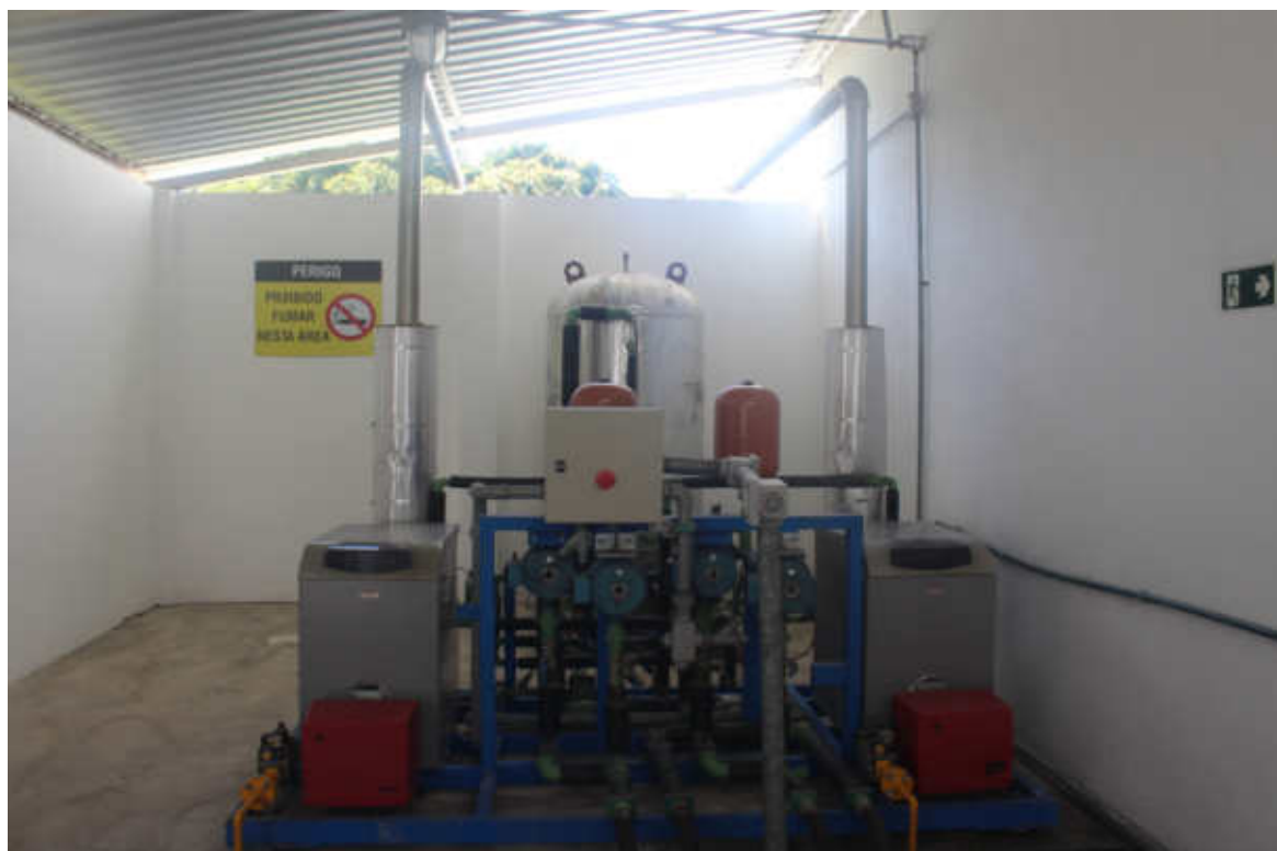
Foto 15: Aquecedores de água
