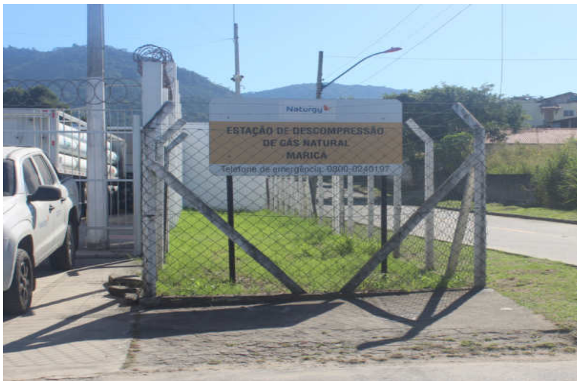
Foto 1: Placa de identificação da estação
