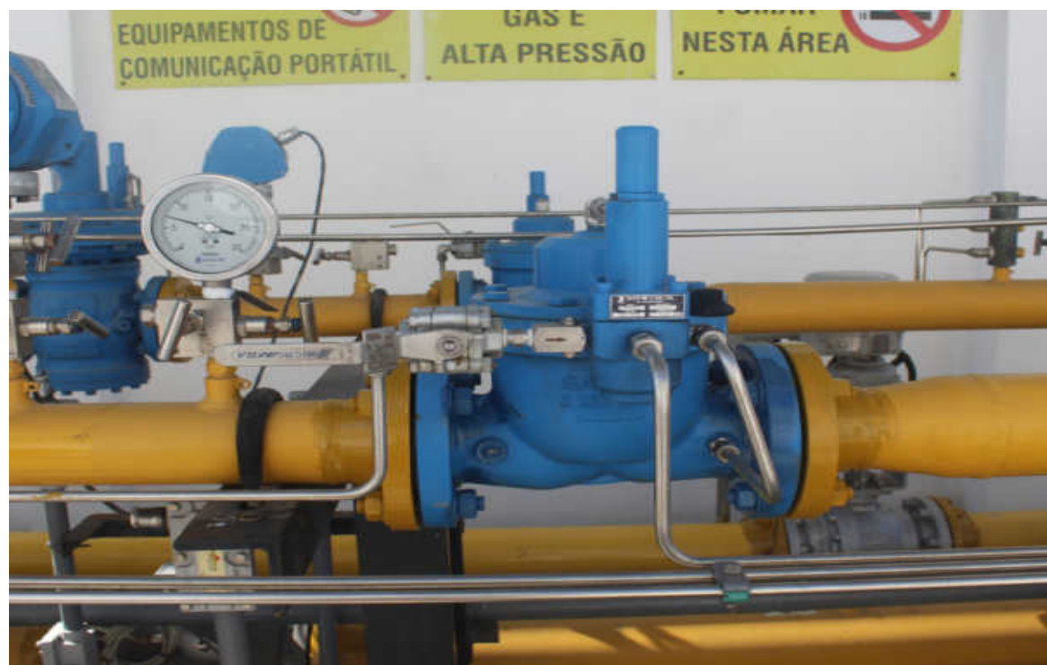
Foto 12: Regulador principal e manômetro
