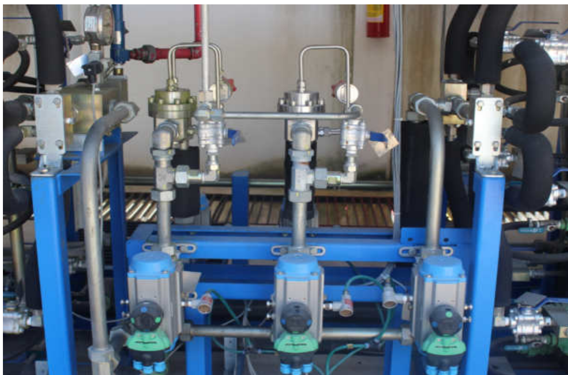
Foto 7: Reguladores de pressão
