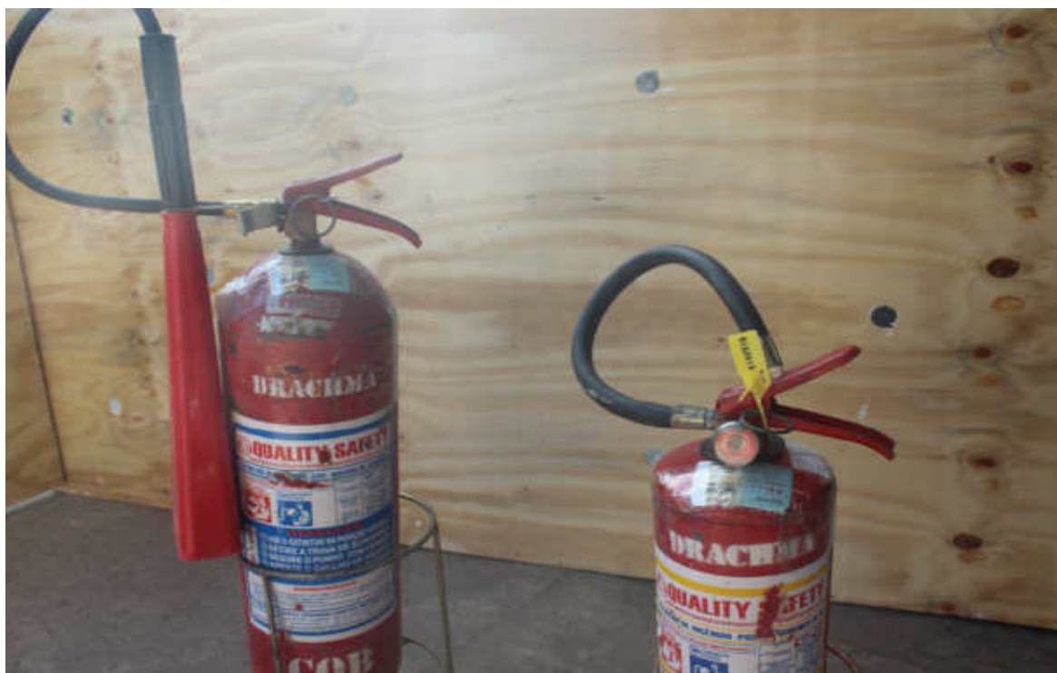
Foto 4: Extintores de incêndio
