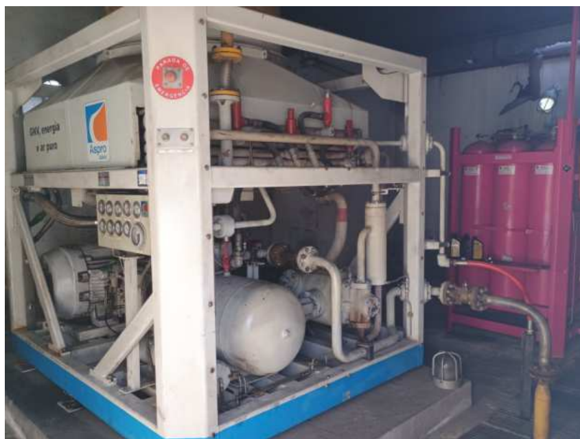
Foto 3: compressor do posto de combustível Halley.
