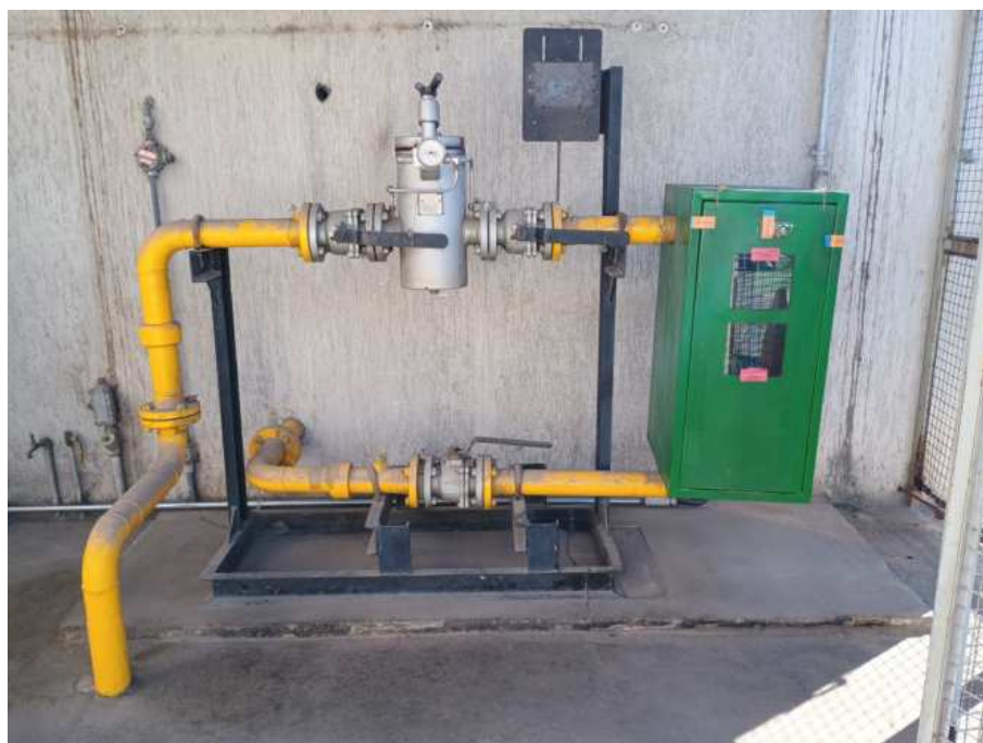
Foto 4: estação de GNV do posto de combustível Halley com o medidor.
