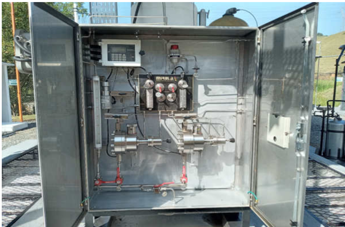
Foto 6: Equipamento de odorização
