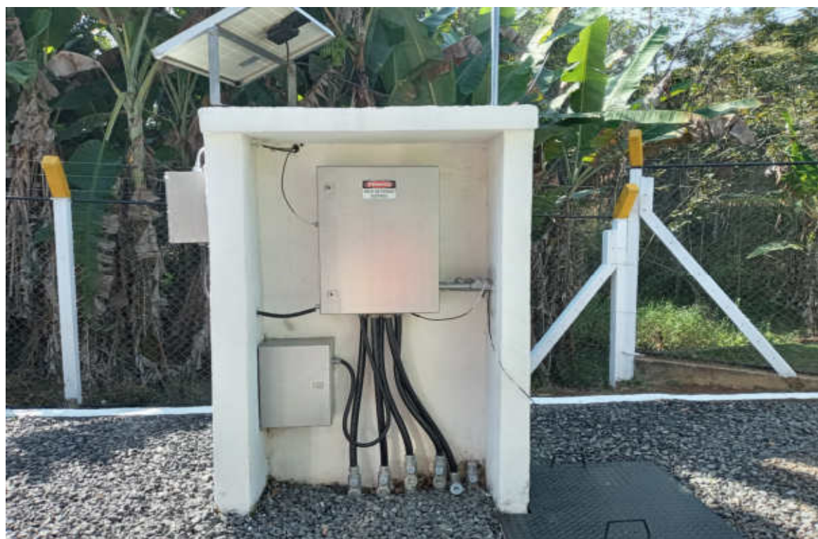
Foto 14: Painéis fotovoltaicos e banco de bateria
