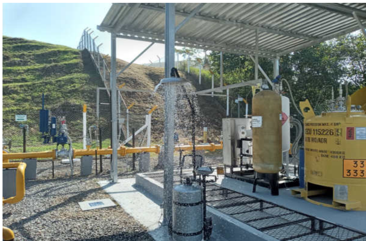
Foto 8: Chuveiro e lava-olhos de emergência
