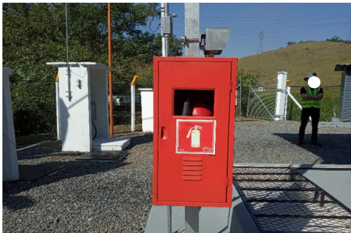
Foto 12: Extintor de CO2
