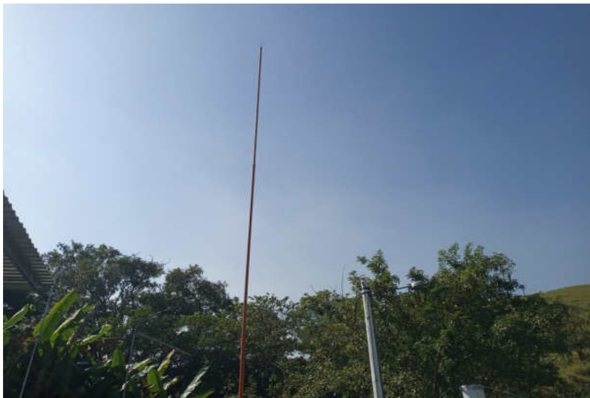
Foto 20: Sistema de proteção contra descargas atmosféricas
