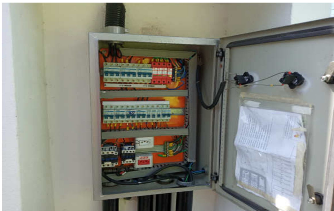
Foto 15: Quadro geral de distribuição
