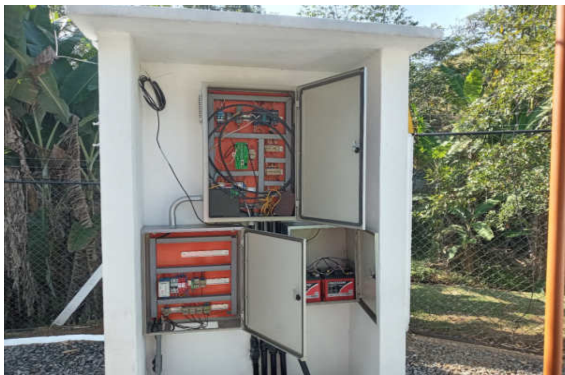
Foto 16: Painele de telemetria e banco de bateria
