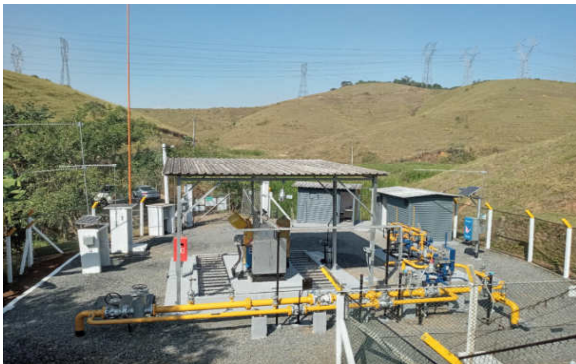
Foto 3: Visão geral da estação
