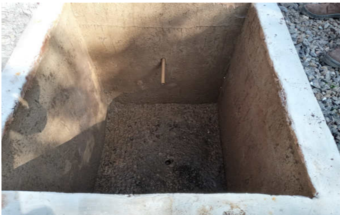
Foto 9: Caixa para armazenar mercaptana em caso de vazamento
