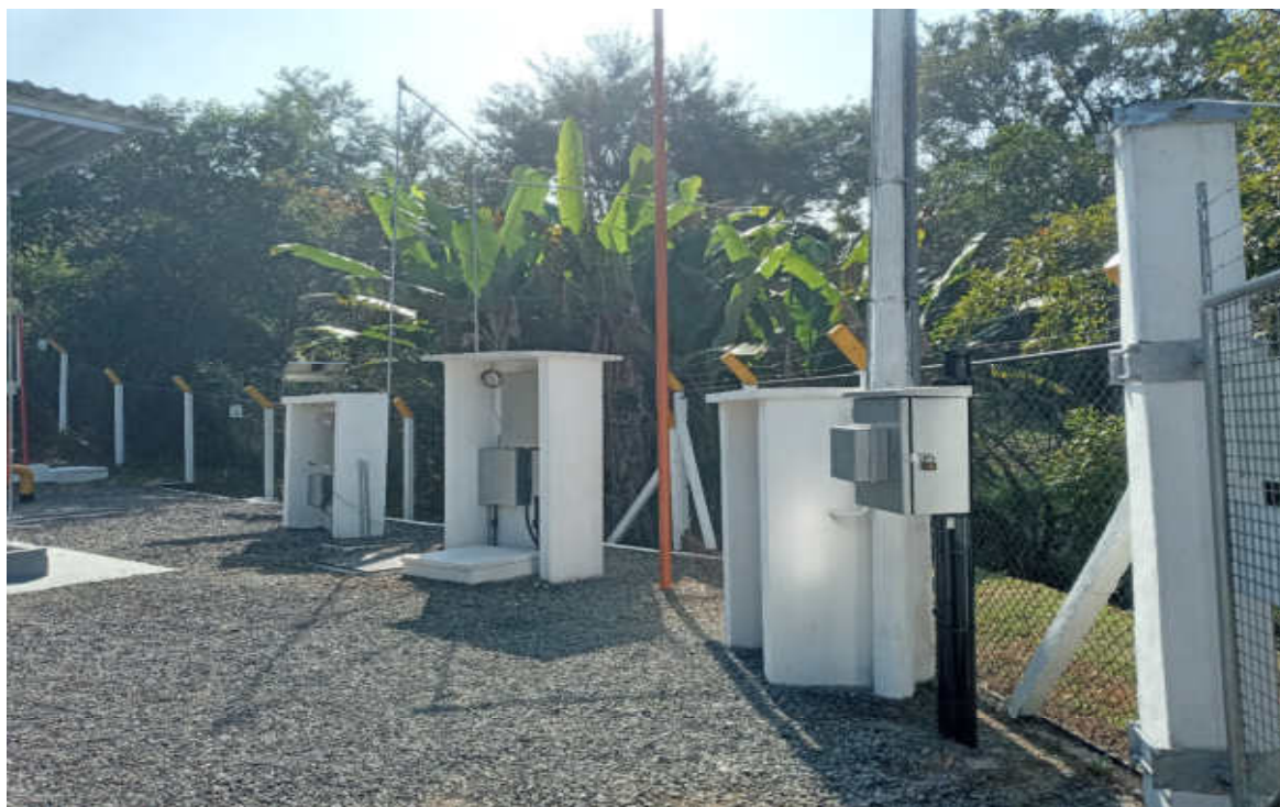
Foto 13: Sistema de energia elétrica
