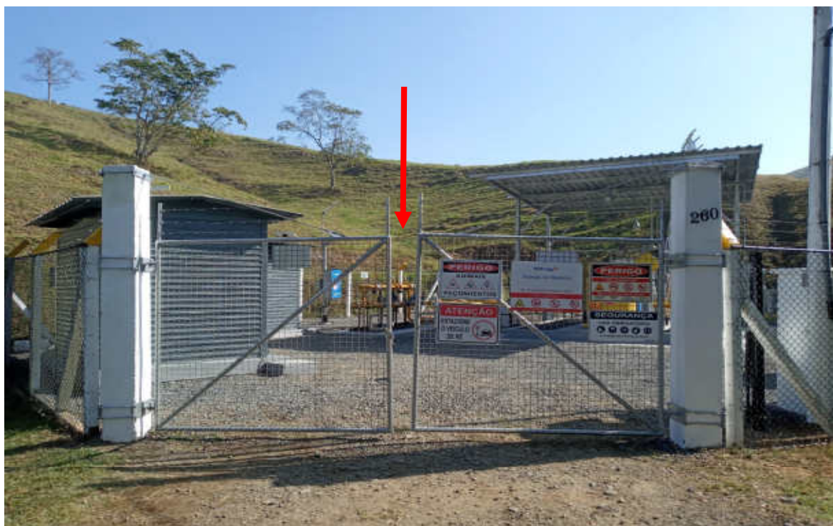
Foto 17: Espaço inadequado entre as partes do portão
