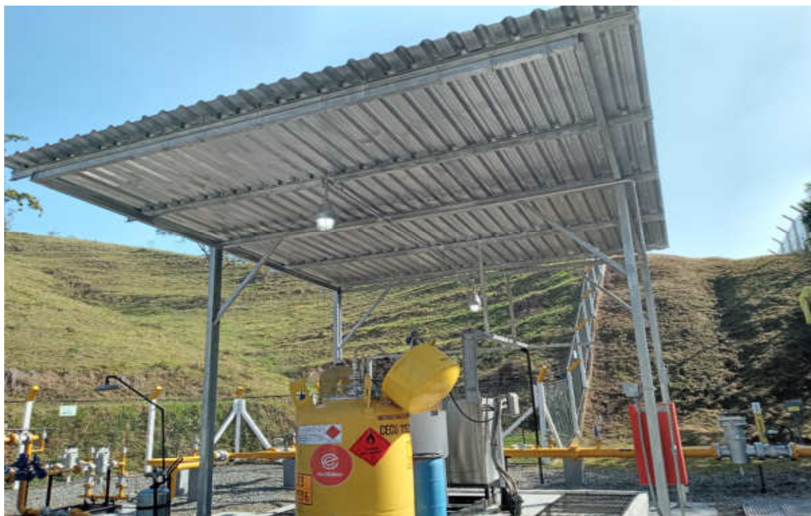
Foto 5: Estação de Odorização
