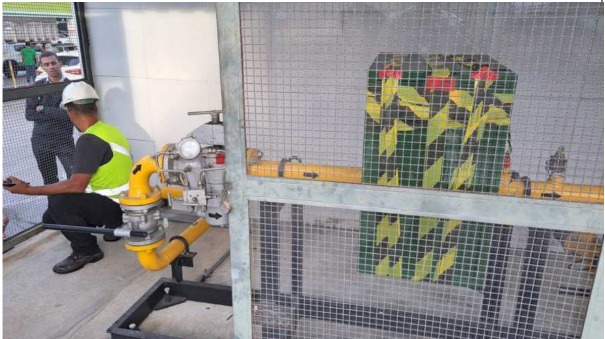
Posto El Ninho Foto 6: Medidor de Vazão lacrado pela Concessionária
