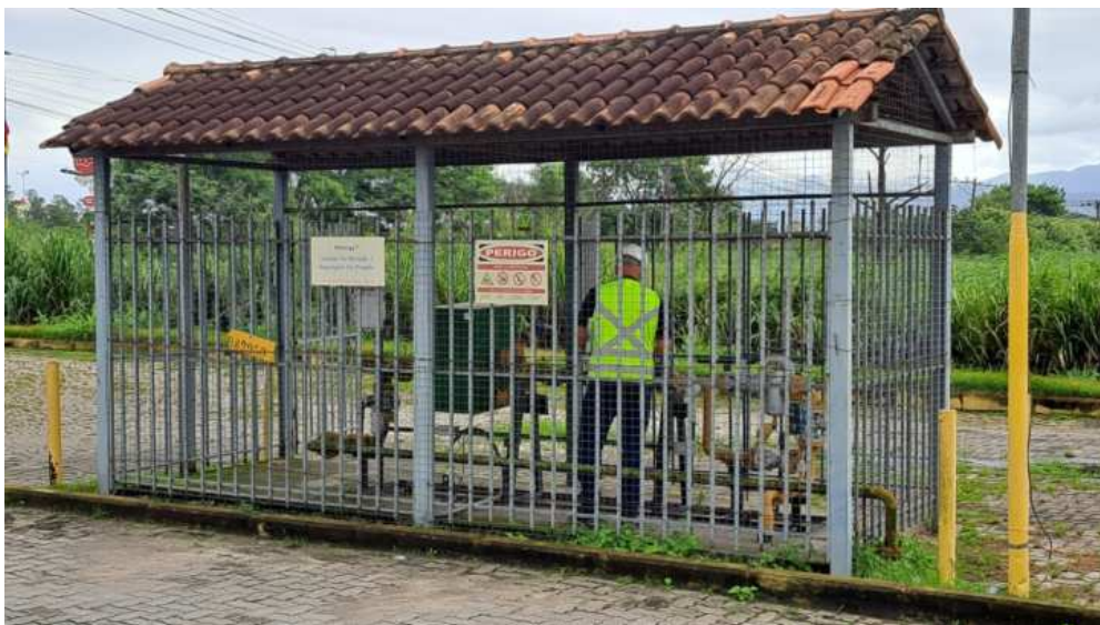
Posto Luar Foto 2: Medidor de vazão de GNV – entrada do fornecimento
