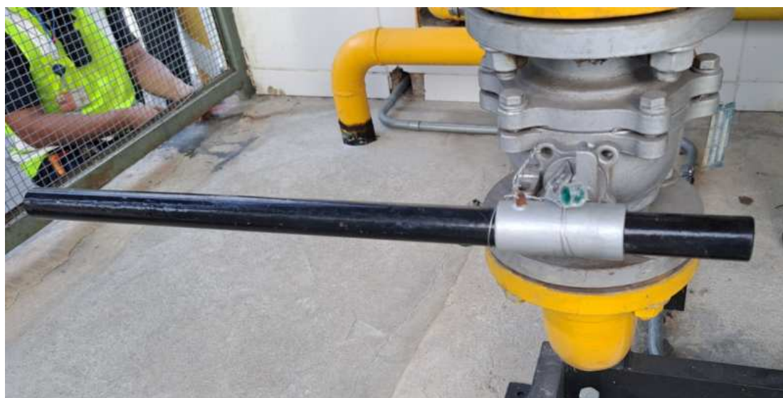
Posto El Ninho Foto 7: Válvula de entrada da área de medição e regulação lacrada
