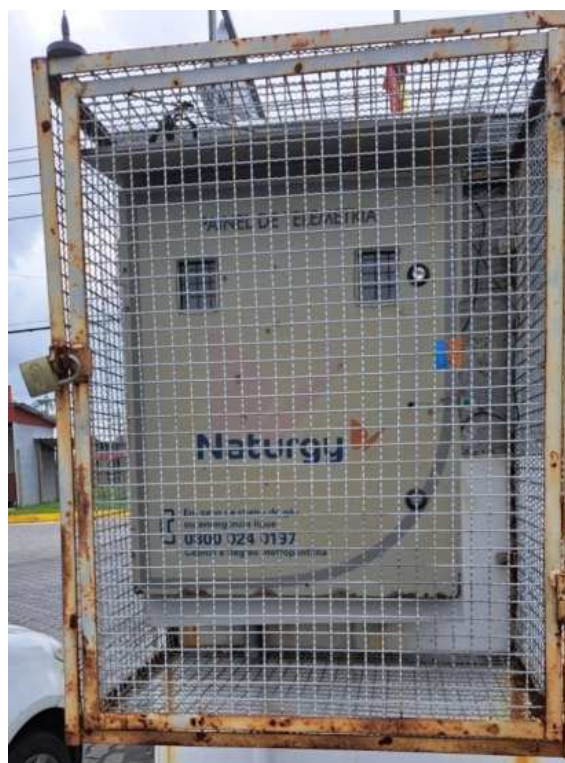
Posto Luar foto 8: Central de Telemetria
