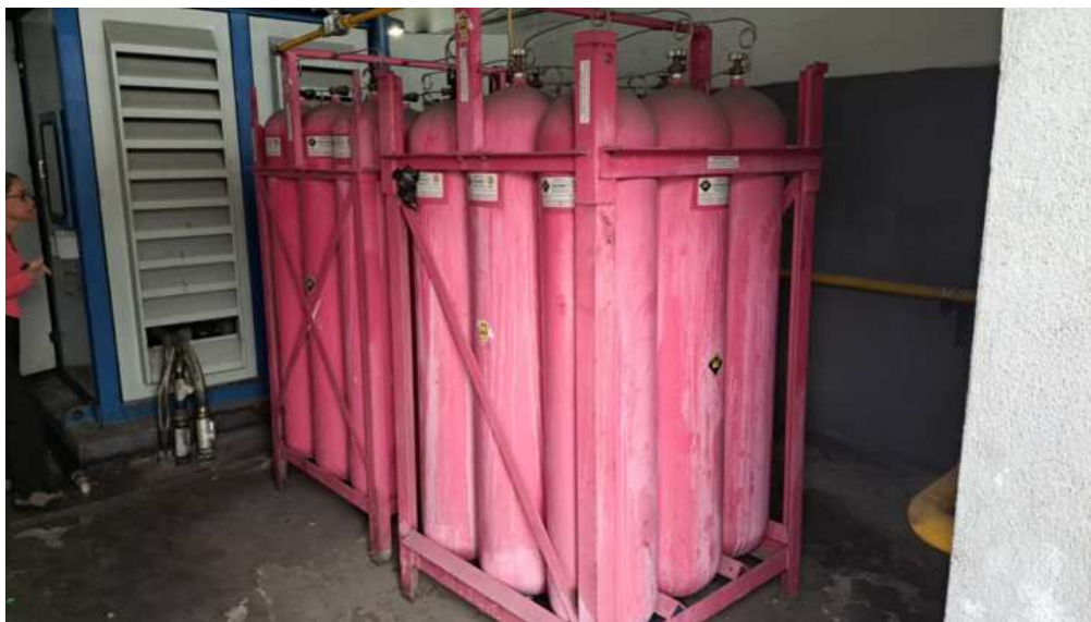
Posto El Ninho Foto 4: Cilindros "pulmão" da área de compressão
