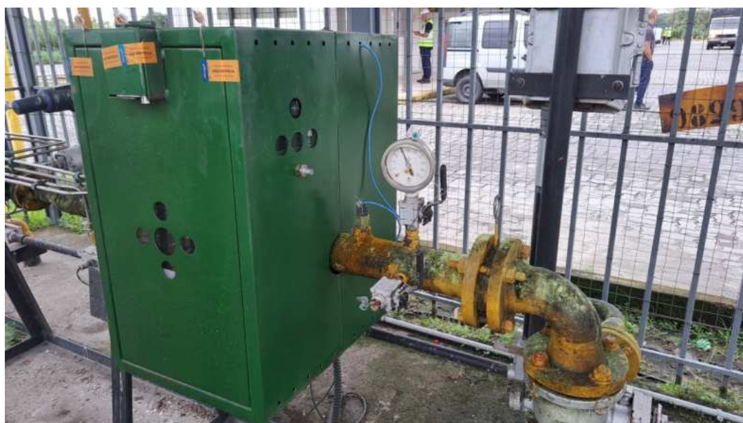
Posto Luar foto 6: Medidor de Vazão
