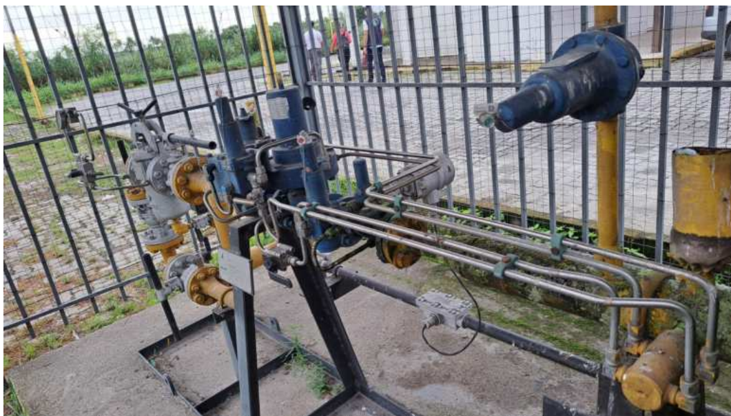
Posto Luar foto 7: Regulagem de pressão e filtragem
