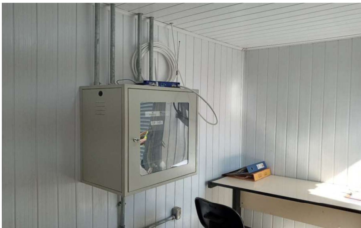
Foto 15: Sala de controle (Nobreak)
