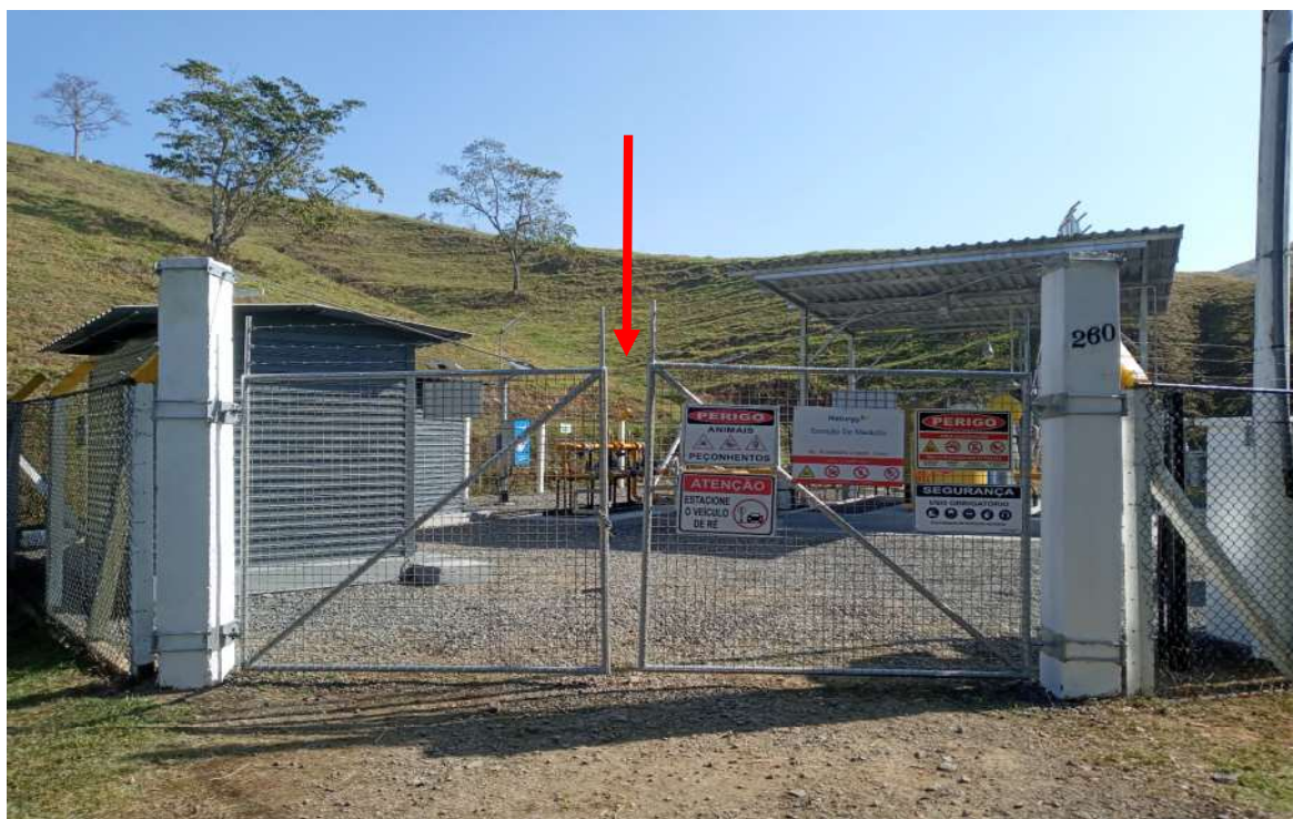
Foto 17: Espaçamento inadequado entre as partes do portão
