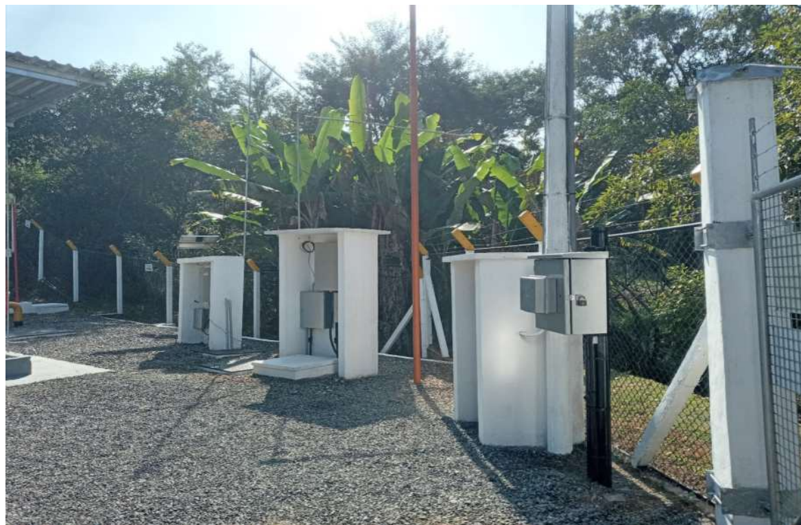
Foto 14: Sistema de energia elétrica
