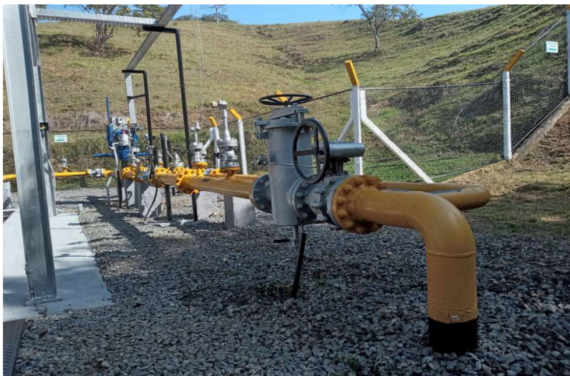
Foto 4: Tubulação de entrada do gás
