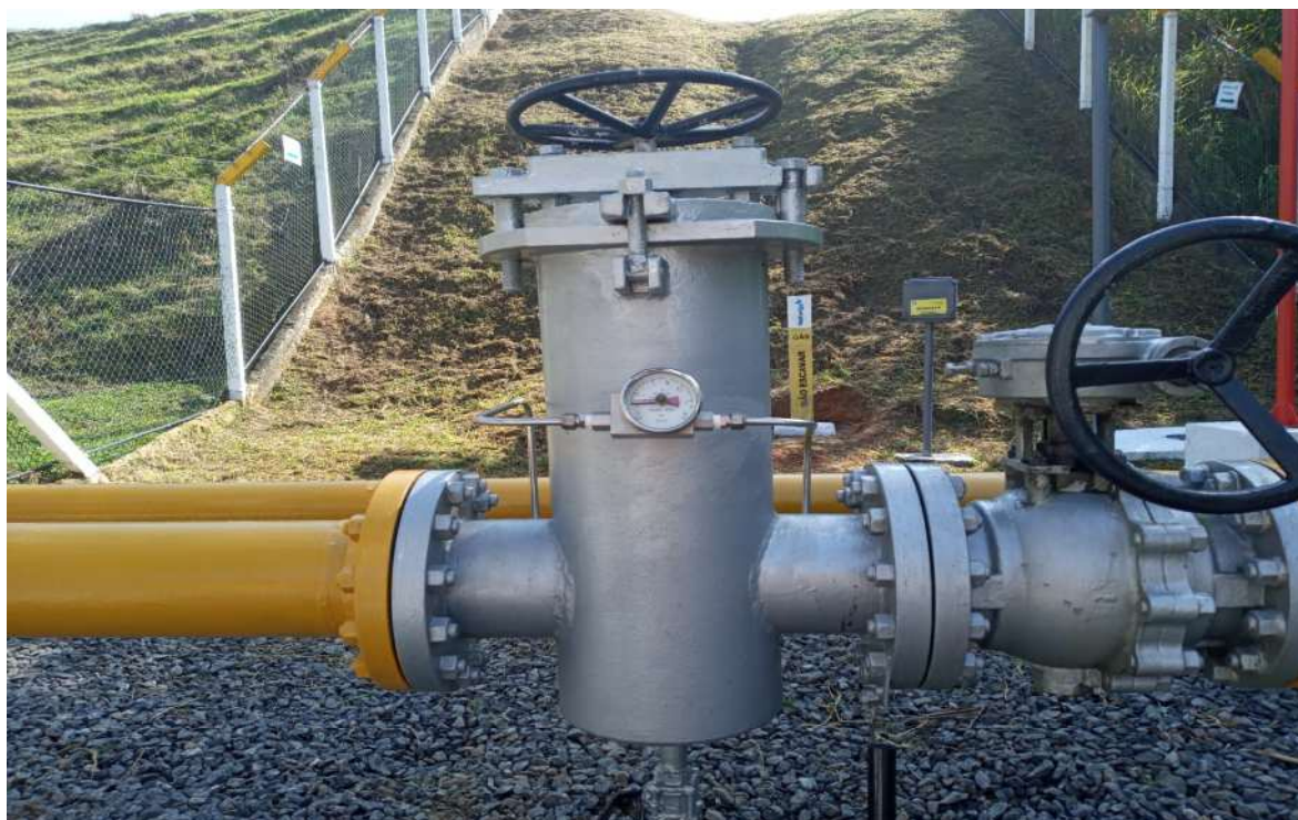
Foto 5: Filtro de gás com manômetro diferencial
