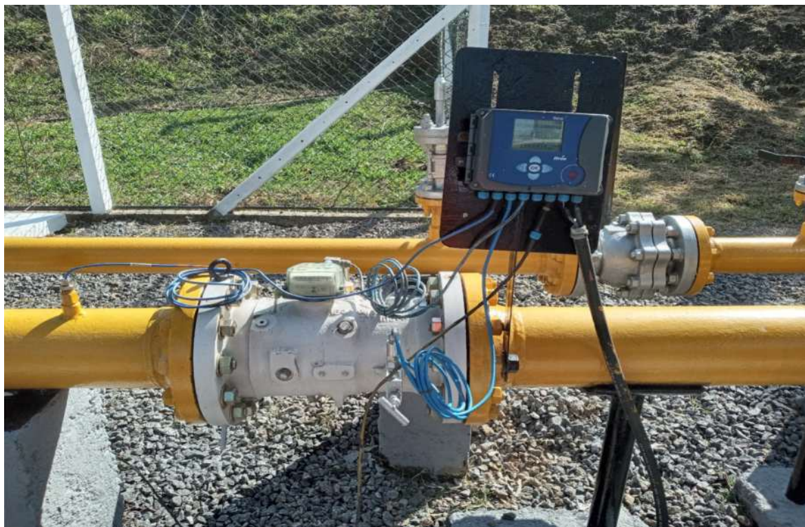
Foto 6: Medidor tipo turbina e conversor de volume
