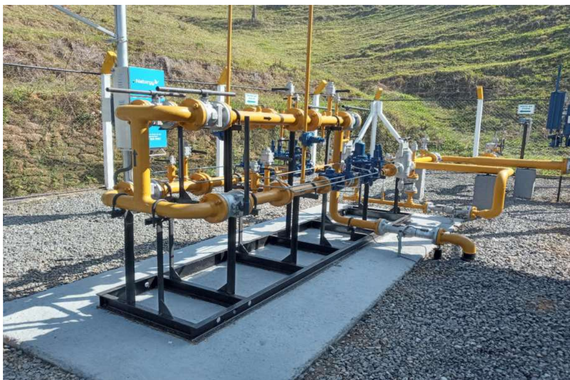
Foto 10: Estação de Regulagem
