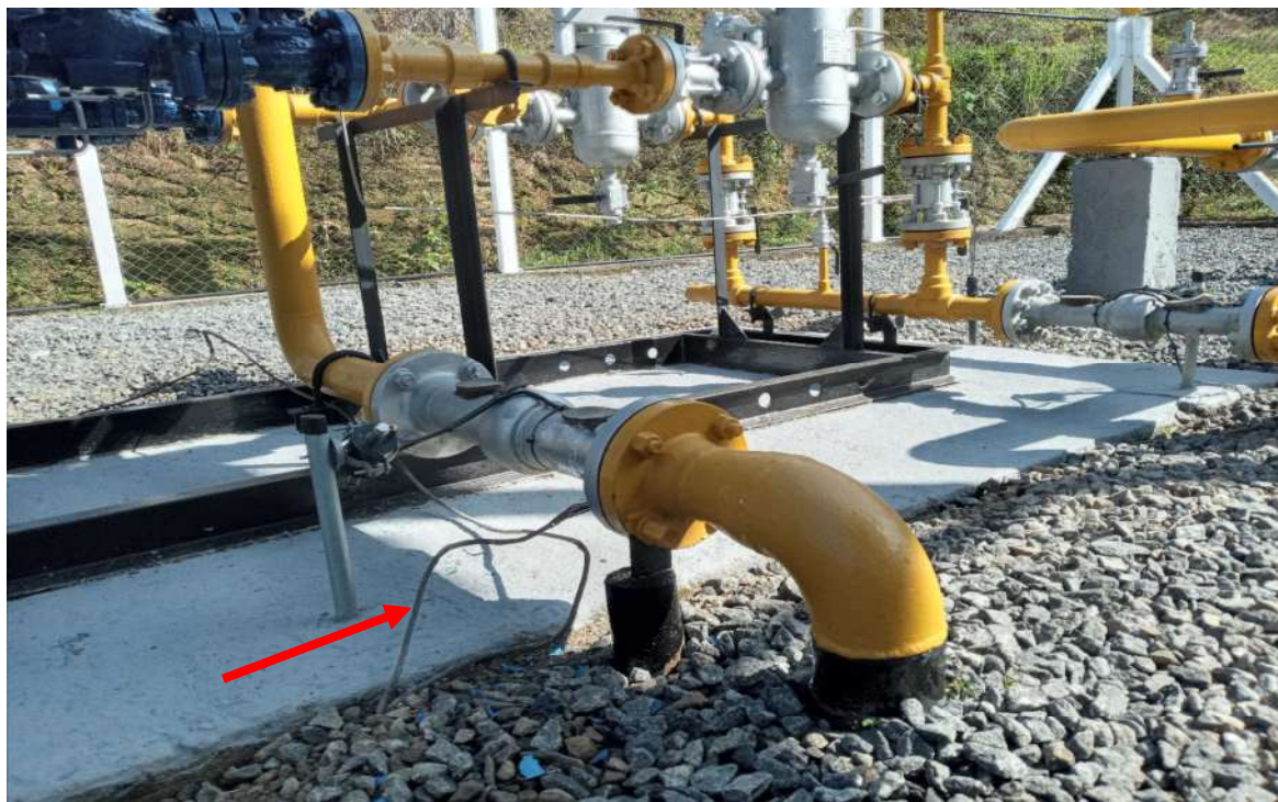
Foto 11: Cabo de aterramento do DPS rompido
