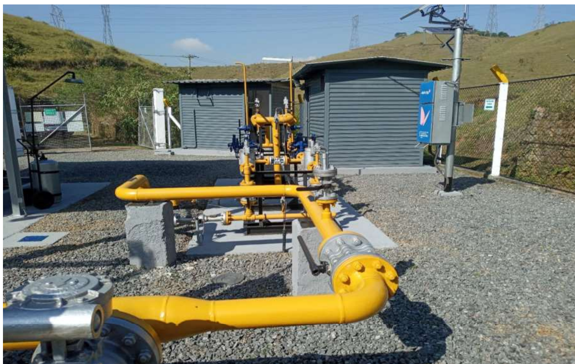
Foto 9: Regulagem de pressão (34 bar / 4 bar)
