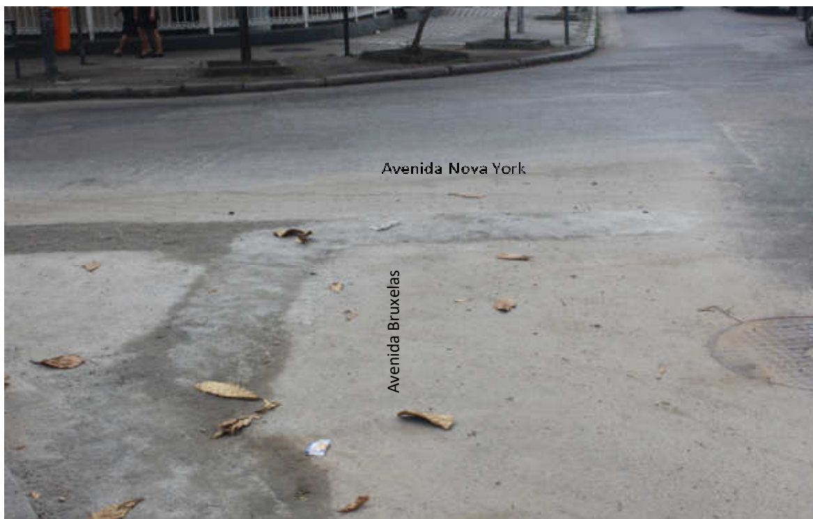
Foto 6: Ponto onde a obra se encontra parada
