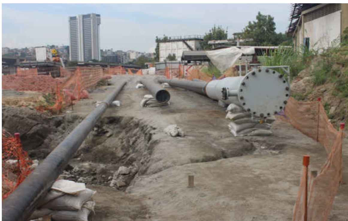
Foto 4: Redes de alta e média pressão
