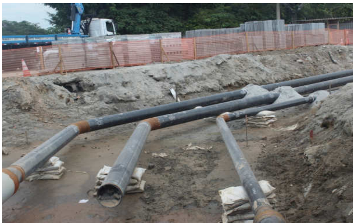
Foto 8: Redes de aço de 14 e 8 polegadas
