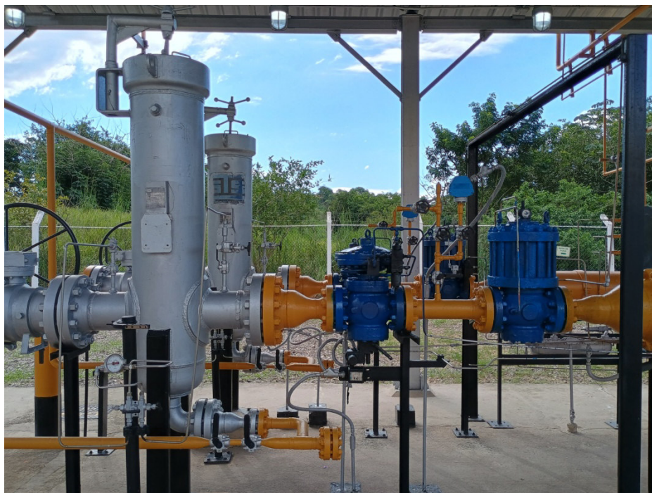
Foto 4: conjunto filtro, regulação e medição.
