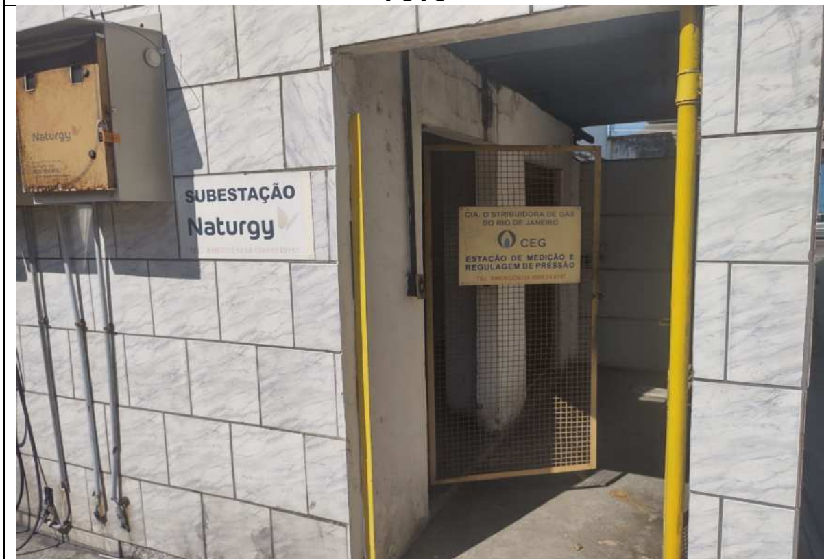
Foto 2: Estação de medição do posto.
