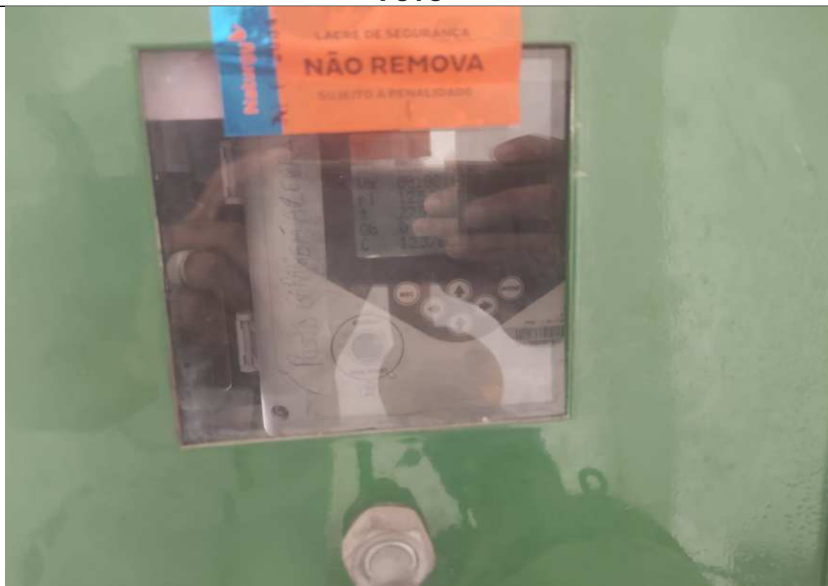
Foto 4: Conversor do posto Garagem.
