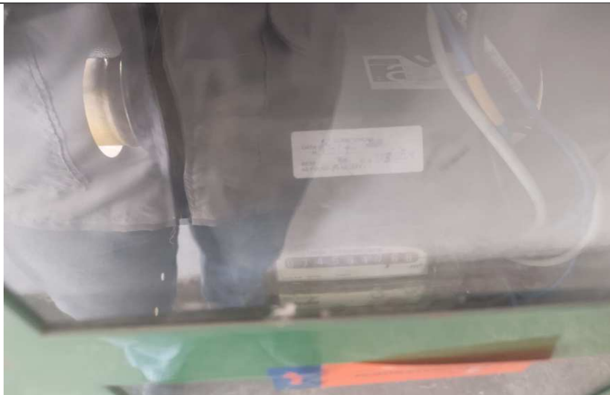
Foto 3: Medidor do posto Garagem.
