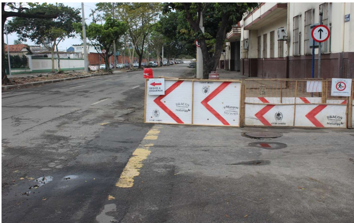
Foto 6 : Demonstração da correção da insuficiência no isolamento de pista.
