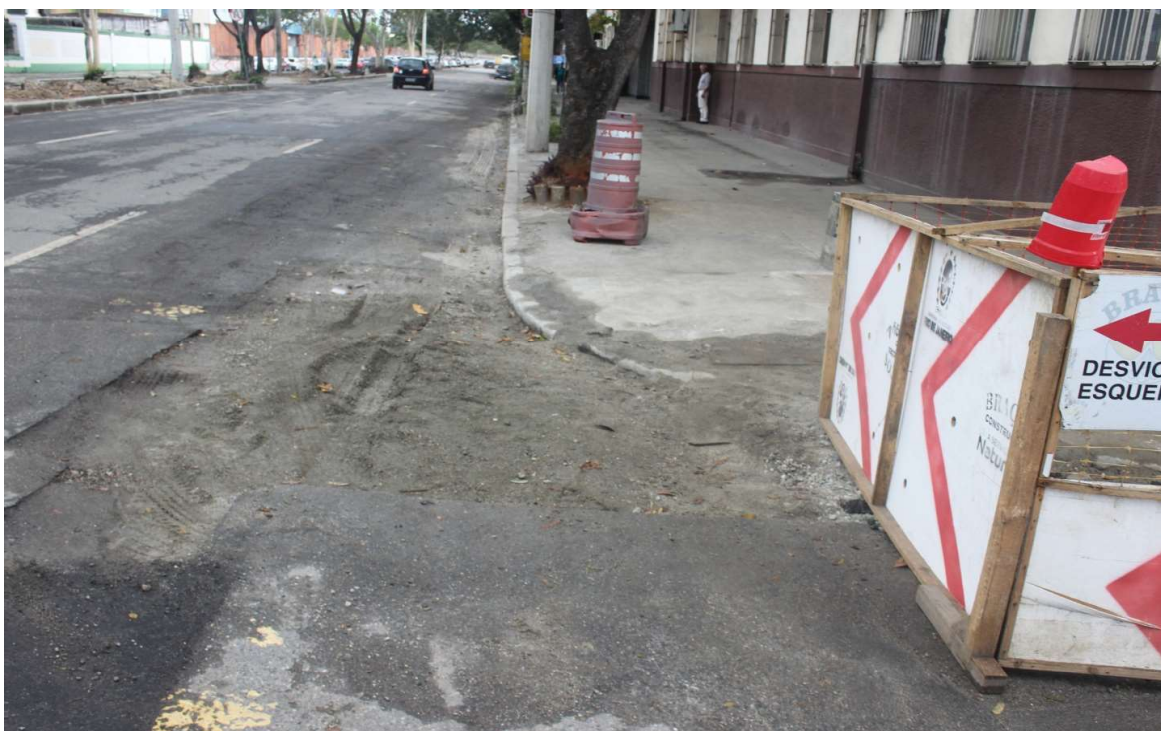
Foto 5 : Insuficiência no isolamento de pista onde foi realizada intervenção da Concessionária, corrigida e demonstrada na foto 2.
