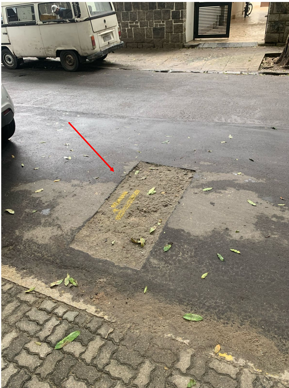
Foto 6: Trecho com recomposição provisória.
