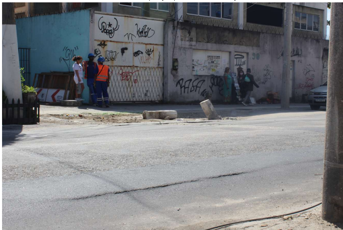
Foto 4: afundamento de recomposição
