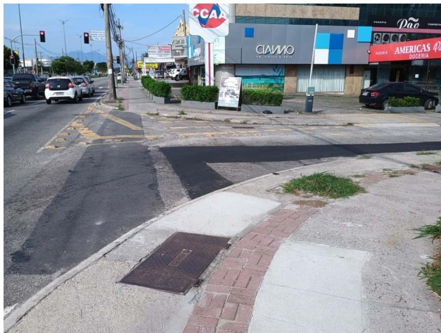
Foto 7: trecho de recomposição provisória não identificado.
