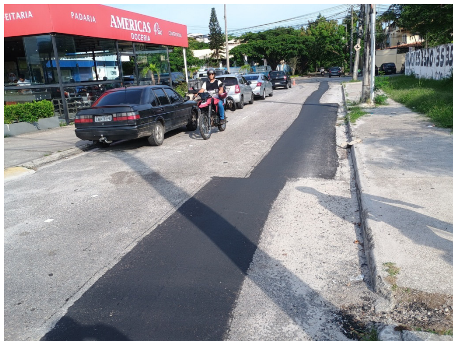
Foto 8: trecho de recomposição provisória não identificado.
