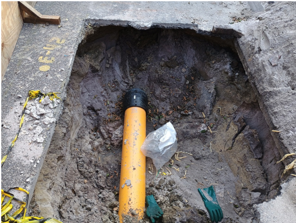
Foto 2: tubulação de polietileno com Ø250 mm.
