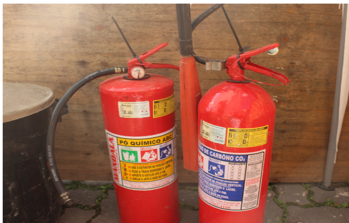
Foto 4: Extintores de incêndio
