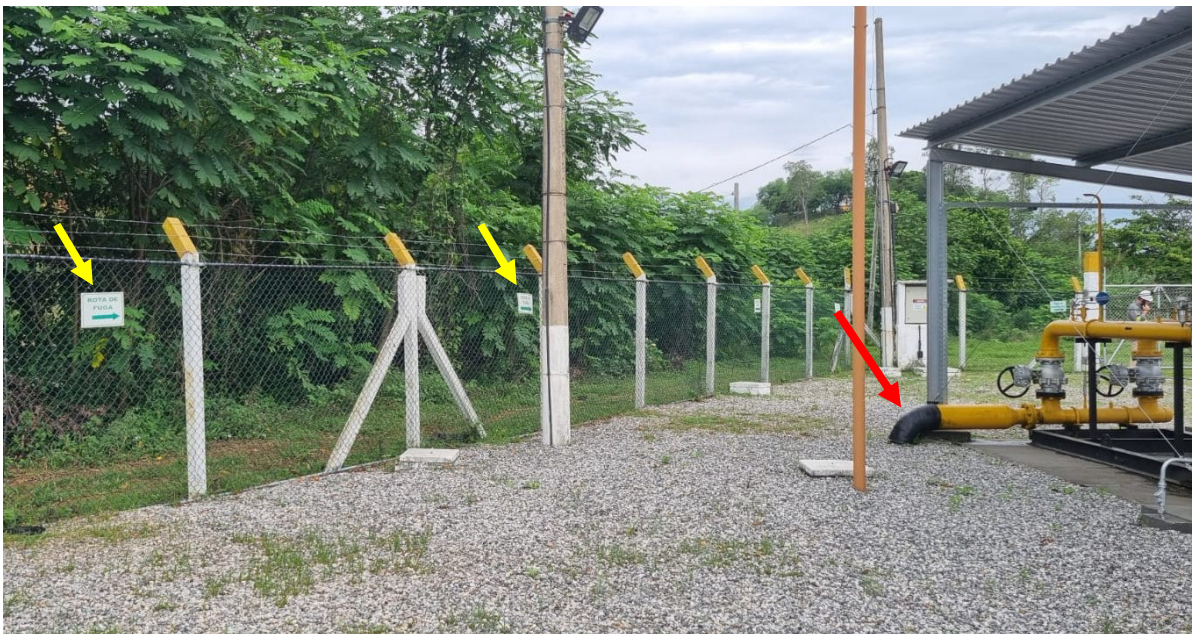
Foto 8: Linha de saída da estação (seta vermelha) e sinalização de rota de fuga (setas amarelas).
