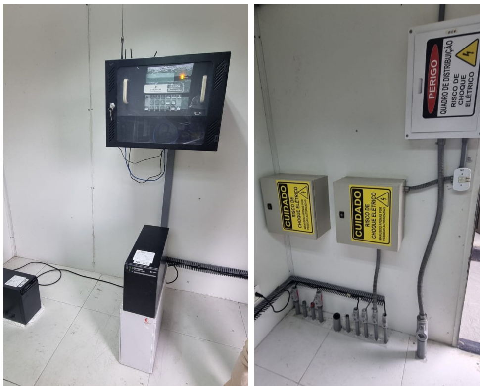
Foto 9: Equipamentos elétricos e de telemetria dentro da sala de controle.
