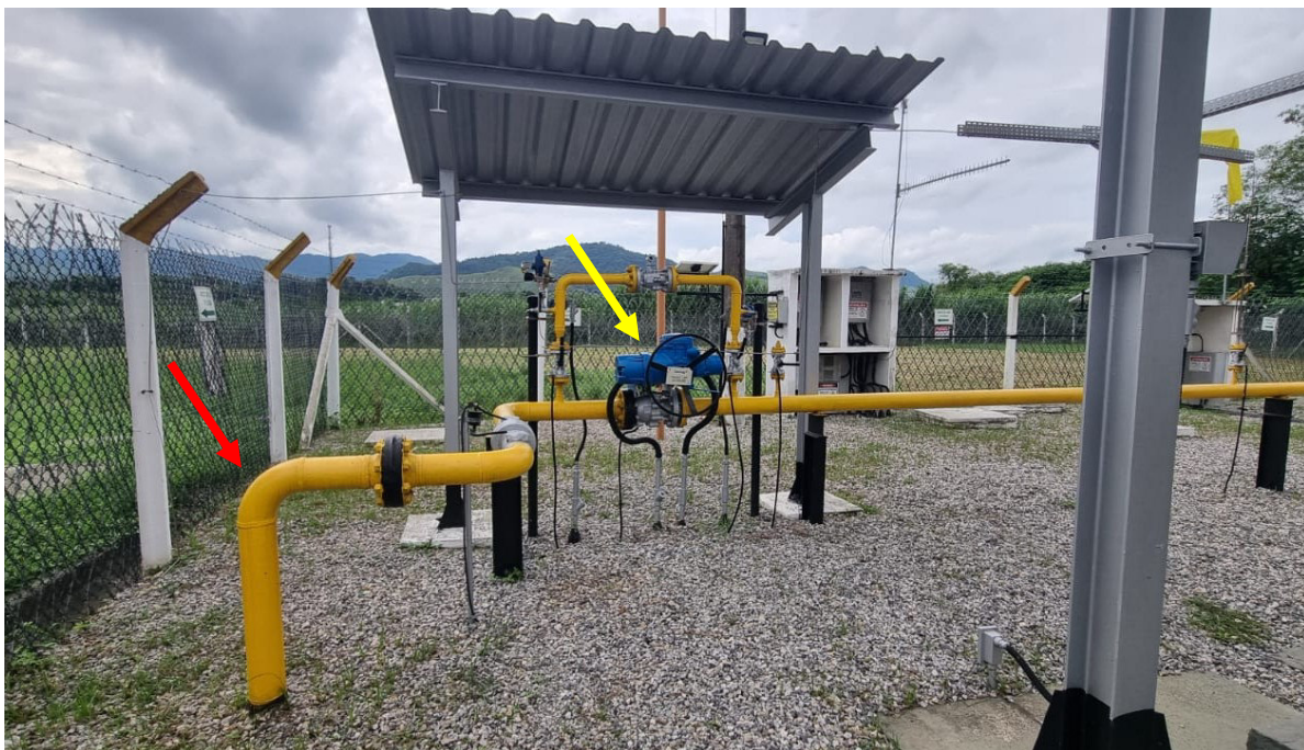
Foto 5: Linha de entrada – o gás é recebido da empresa NTS (seta vermelha) - e válvula telecomandada (seta amarela).
