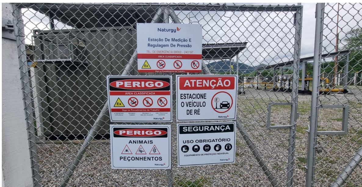
Foto 2: Placas de identificação e de sinalização de segurança da estação.
