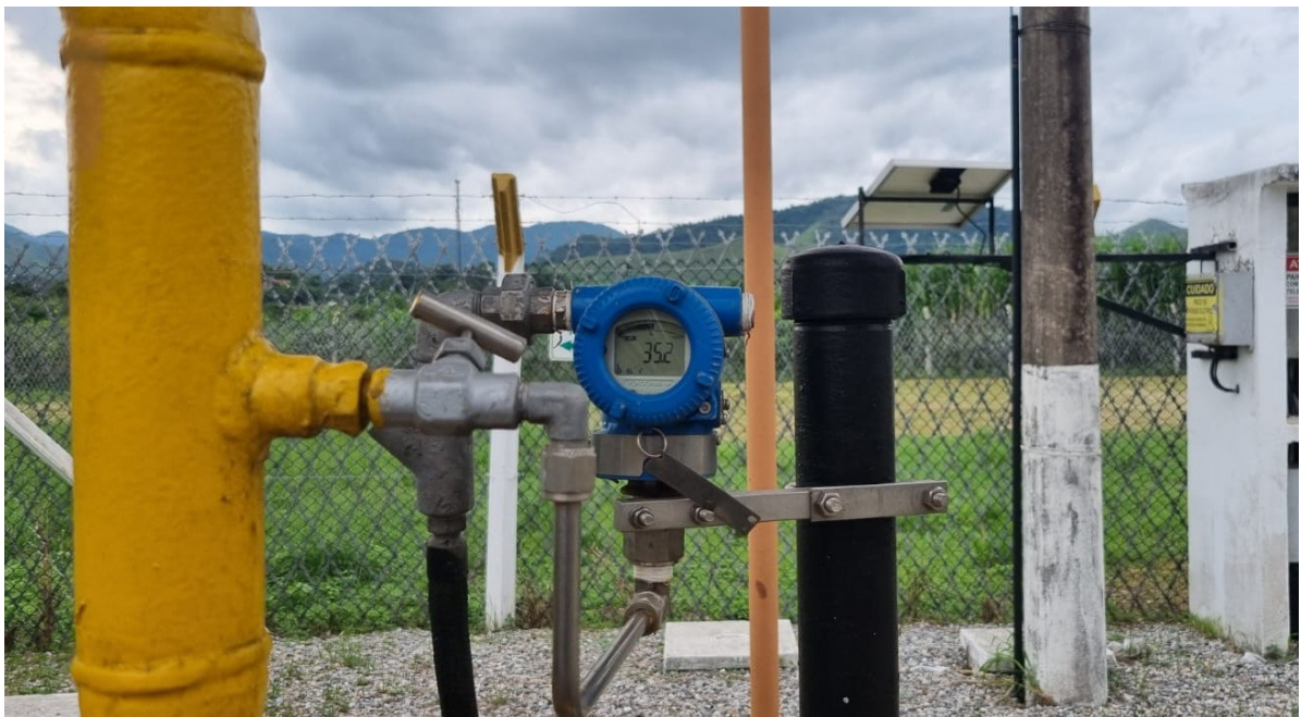
Foto 4: Medidor da pressão de entrada.
