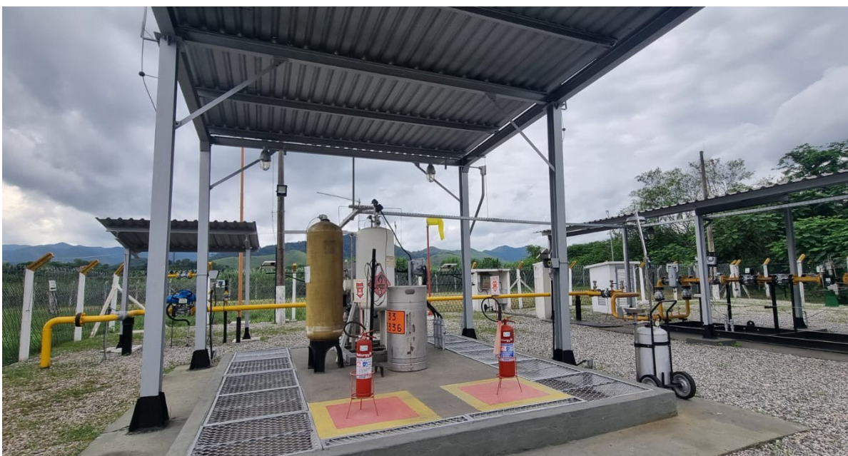
Foto 6: Sistema de Odoração da estação.
