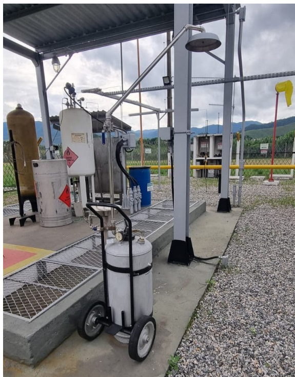
Foto 12: Chuveiro e lava olhos localizados ao lado do sistema de odorização da estação.
