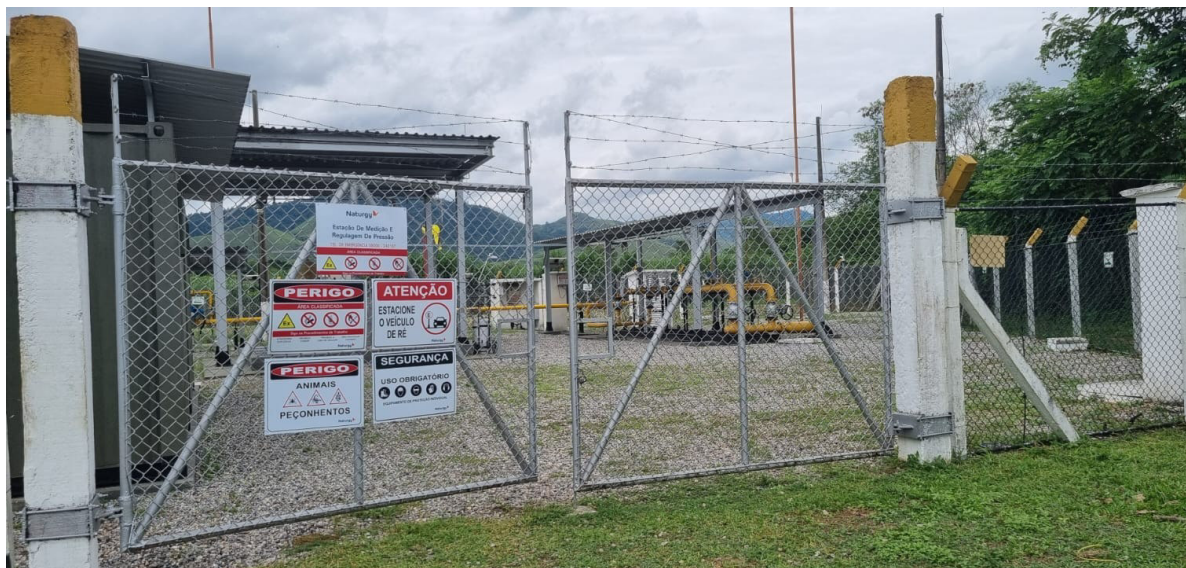
Foto 1: Portão de entrada da Estação de Regulação e Medição de Paracambi/RJ.
