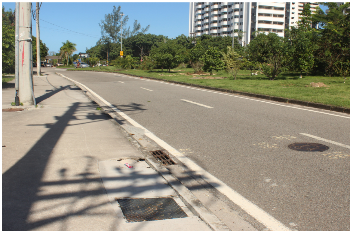
Foto 5: Afundamento de recomposição e caixa (antes)
